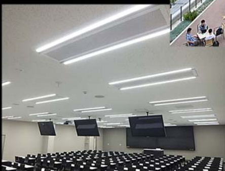
誘引放射整流空調 吹出し口
