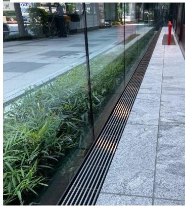
床放射冷暖房 吹出口
