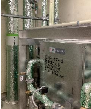
水冷ビルマルチ 水冷ユニット 熱源水配管
