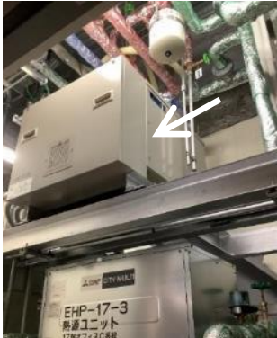
水冷HP給湯器
