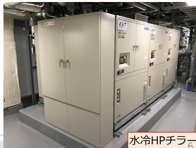
冷温水発生機
