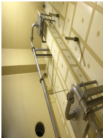
蓄熱槽廻り写真
