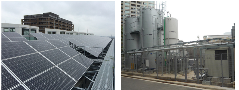
ショップ&オフィス棟屋上の太陽光パネル 発電出力は約220kw
