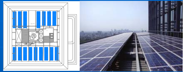
屋上太陽光発電パネル
