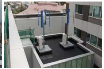
風力発電設備
