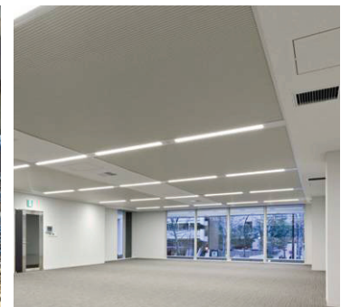
2階：輻射天井空調システム
