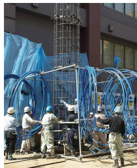
地中熱利用(杭方式)
