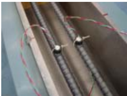
写真 1 鉄筋腐食センサー
