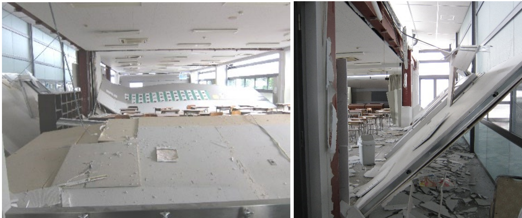
写真 熊本地震によるLGS壁の被害
