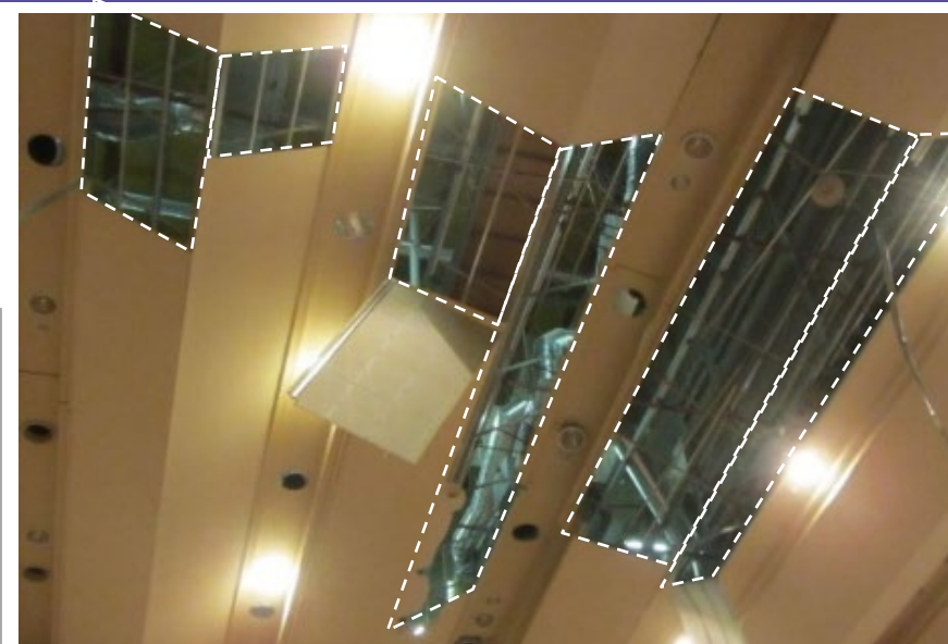
複数の勾配から成る天井の地震被害の例
