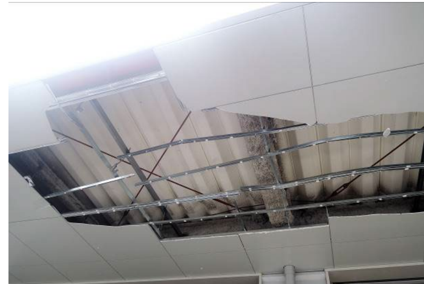
店舗の軒天井の損傷
