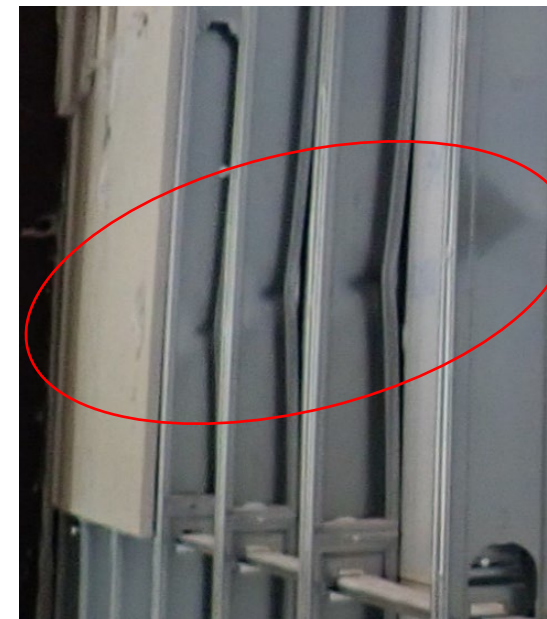
高さ1.5m部分でのスタッドの変形
