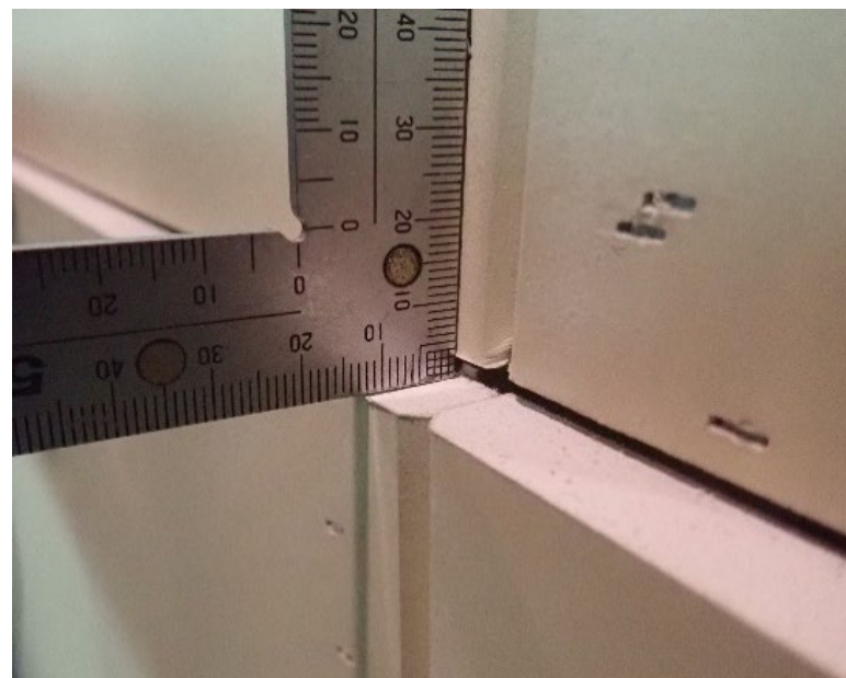
(c) 目地部分でのボードの剥がれ（面外2.0%後）
