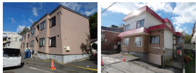
(a) 共同住宅 (b) 戸建住宅 写真 1 地盤変状による基礎・上部構造の損傷被害
