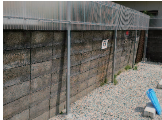
写真3 傾斜被害のあったI1の補強ブロック塀
