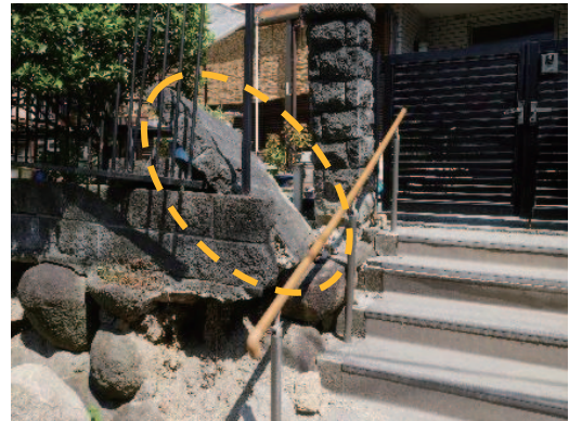
写真1 転倒したT2の補強ブロック塀
