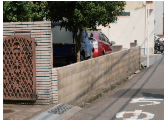
写真2 転倒したI4の補強ブロック塀
