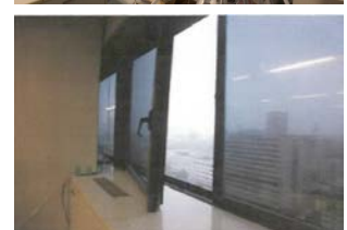
庁舎A 2・13・15階窓ガラスの被害
