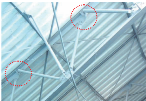
(b) 屋根のトラス梁(丸印が接合部の変形)
