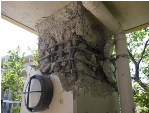
ピロティ階柱 柱頭部の破壊
