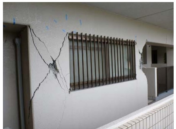
非構造壁の破壊
