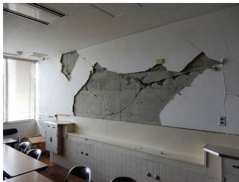
張間方向耐力壁のせん断ひび割れ
