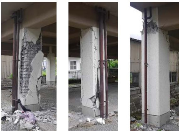
ピロティ階柱 脆性破壊
