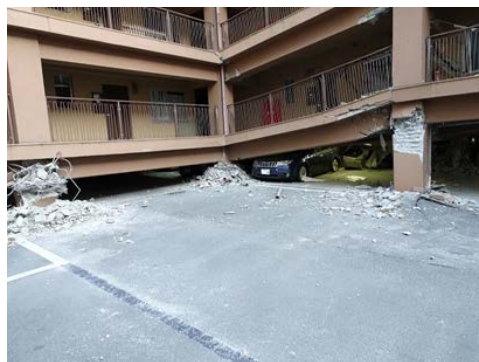
ピロティ層の部分崩壊
