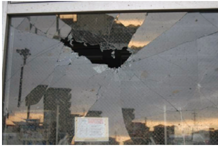
写真 27 窓ガラスへの衝突痕 (つくば市)
