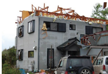
写真5 小屋組の破壊・飛散 (つくば市)
