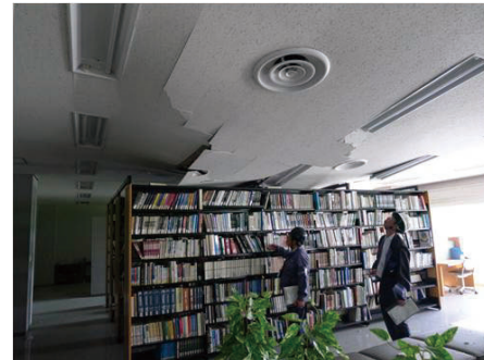
写真 25 内装材(天井材)の被害 (つくば市)
