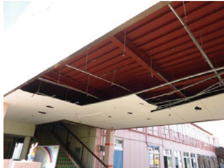
写真19 ピロティの天井の被害 (越谷市)
