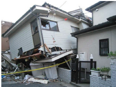
写真11 上部構造の倒壊（越谷市）
