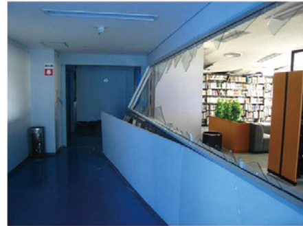
写真 24 内装材の被害 (つくば市)
