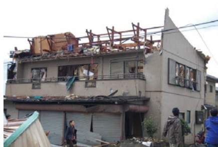
写真6 小屋組の破壊・飛散 (つくば市)
