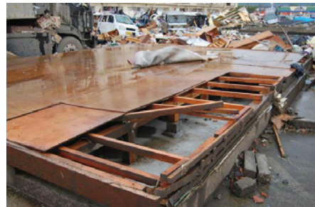
写真13 上部構造の飛散（つくば市）
