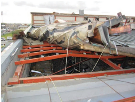
写真17 鋼板製の屋根ふき材及び母屋の破壊 (越谷市)
