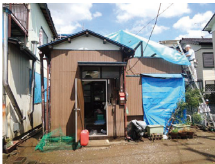
写真7 小屋組の破壊 (越谷市)
