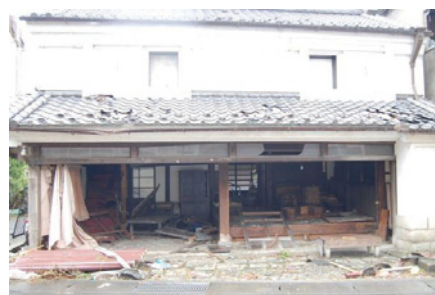
写真 2 開口部の損傷 (つくば市)
