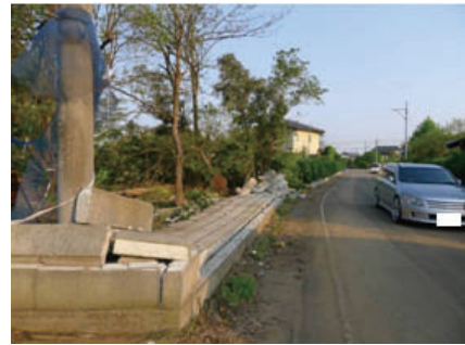
写真 31 石塀の倒壊 (つくば市)
