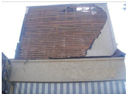
写真4 モルタル外壁の脱落 (つくば市)
