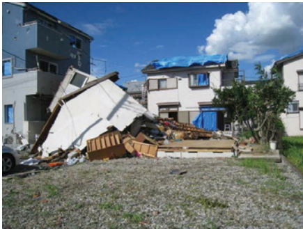
写真10 上部構造の倒壊（越谷市）
