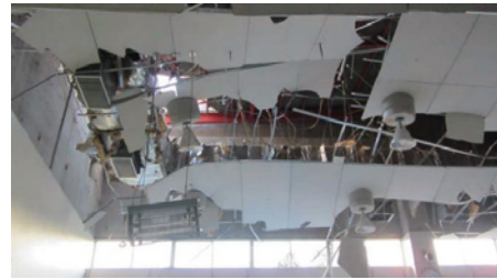
写真18 写真17に示す施設の天井の破壊 (越谷市)
