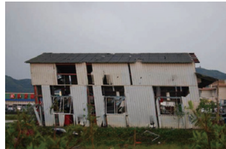
写真20 骨組の残留変形 (つくば市)
