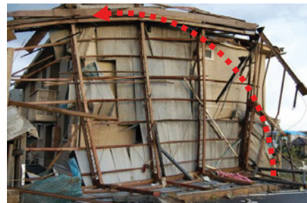
写真21 上部構造の転倒 (つくば市)
