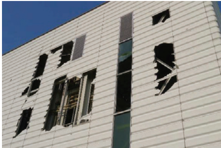
写真16 外壁材とガラスの損傷 (つくば市)
