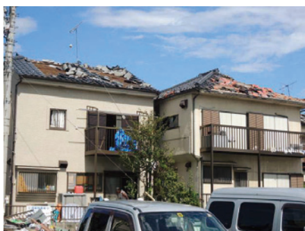
写真3 屋根ふき材の脱落・飛散 (越谷市)
