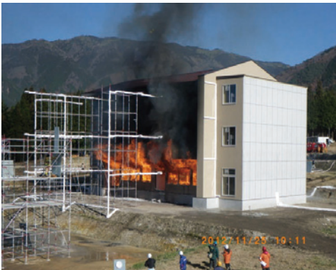
写真5 2階開口部からも噴出火炎 (131分後)
