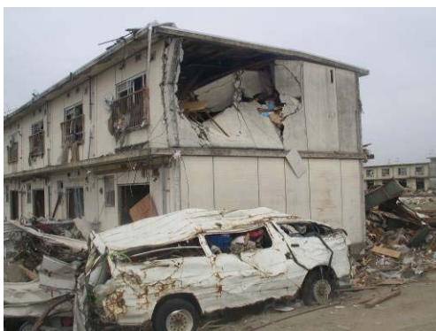
写真15 漂流物の衝突により生じた壁の開口
