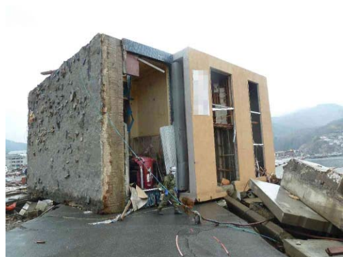
写真4 3階建て直接基礎建築物の転倒
