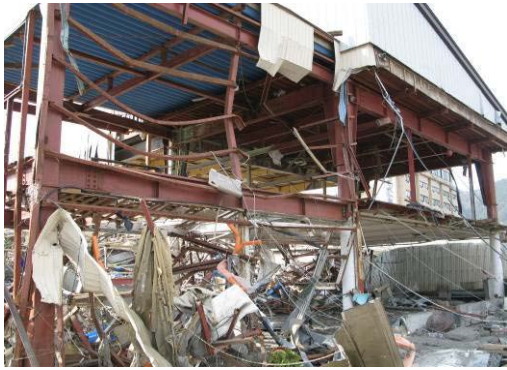
写真30 間柱等の非構造部材の変形
