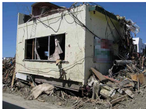
写真2 2階建て建築物の層崩壊
