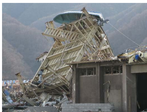
写真17 柱脚部アンカーボルトの破断により移動したと考えられる建築物
