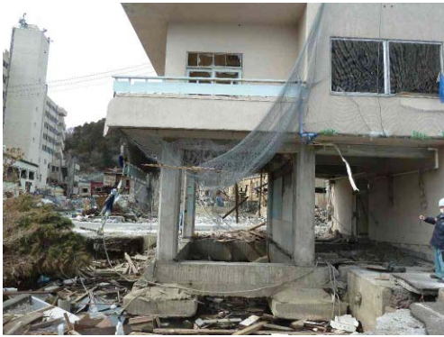
写真9 洗掘による基礎の露出
