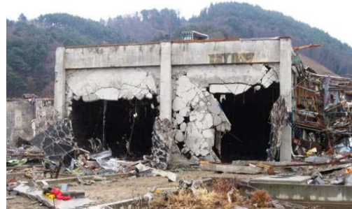
写真12 非構造壁の面外破壊
