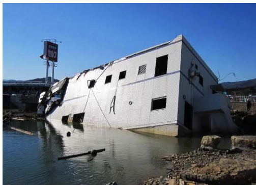
写真11 大きな波圧により流された直接基礎のRC造建築物
