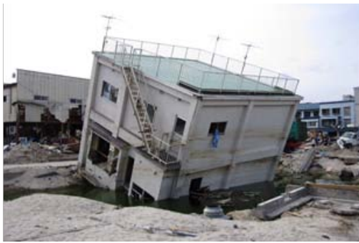
写真10 洗掘による2階建て建築物の傾斜
