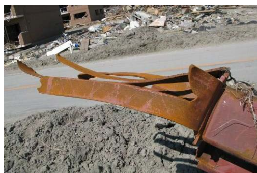
写真19 引き裂かれた梁フランジ
