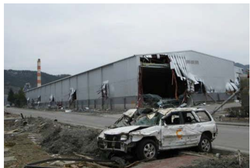
写真27 倉庫(津波の流出口として妻壁および開口部が外側に変形)
