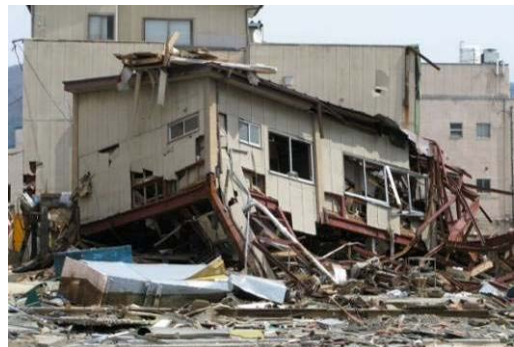
写真22 2階建てS造の1階の崩壊
