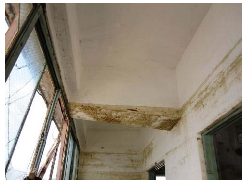
写真6 建物内部の水の汚れの痕跡
