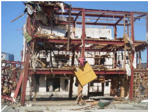
写真24 傾斜した重層建築物
