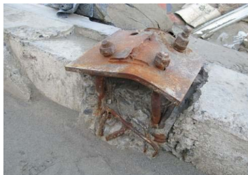
写真16 柱脚部の破断
