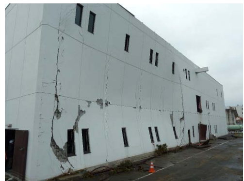
写真13 2,3階部分に床を持たない連層壁の面外破壊(建築物の奥の部分には2,3階部分に床がある)
