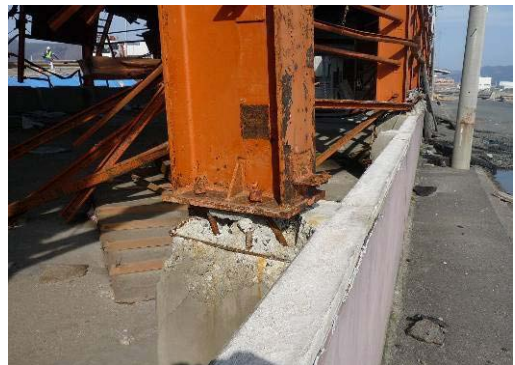
写真29 柱脚部の移動(コンクリート塊や道路の舗装アスファルト等の漂流物によると思われる)
