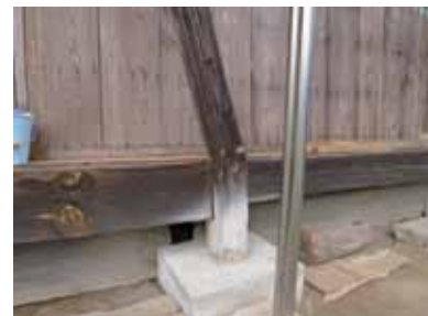
写真5-6 写真5-5の住宅の柱の折損
