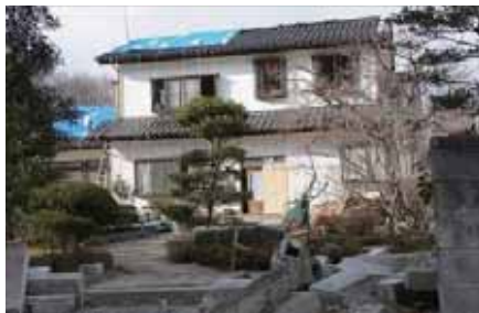
写真5-1 屋根瓦の被害
