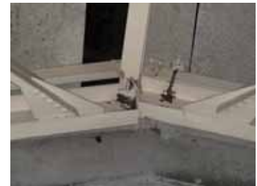
写真4-4 妻壁とS造屋根接続部のアンカーボルト抜け出し
