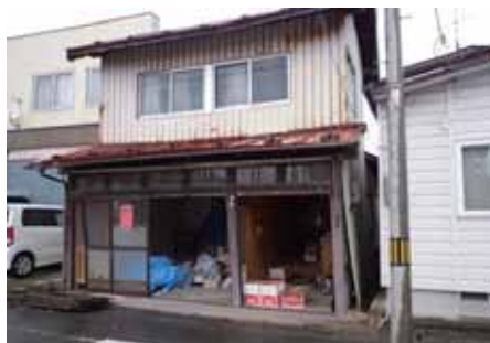
写真5-3 建築物の傾斜 (残留変形)
