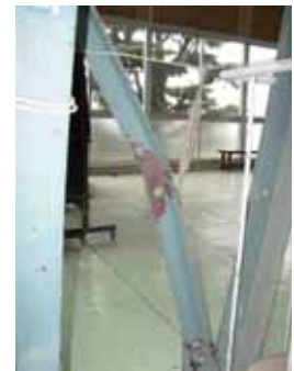
写真4-2 ラチス柱斜材の座屈
