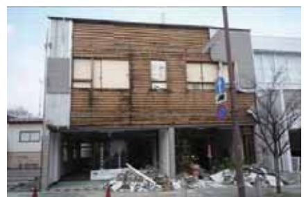
写真5-2 外装材の脱落
