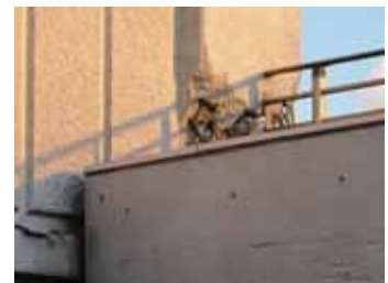
写真 3-4 連層耐力壁側柱脚部の圧壊
