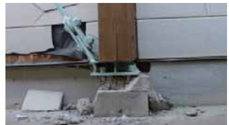
写真5-8 ベースプレート部基礎の被害
