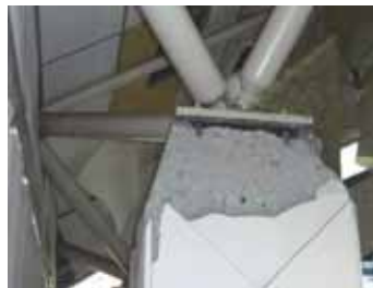
写真4-3 RC柱とS造屋根接続部被害
