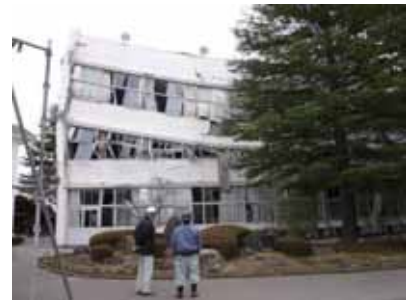
写真 3-2 中間階の層崩壊
