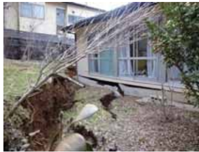
写真 5-11 敷地等の崩壊に伴う基礎の被害
