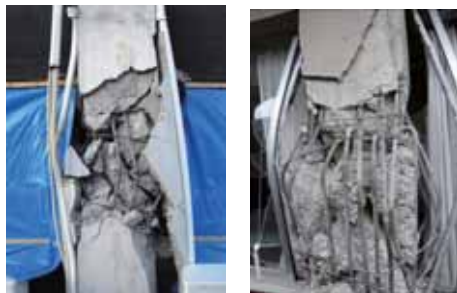
写真 3-3 柱のせん断破壊
