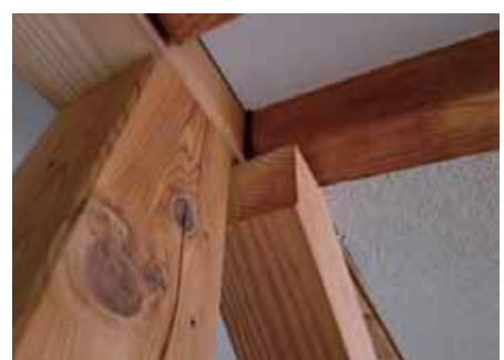
写真5-10 写真5-9の筋かい端部のはずれ
