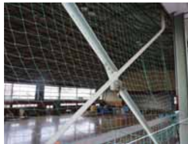
写真4-1 ブレースの破断、座屈
