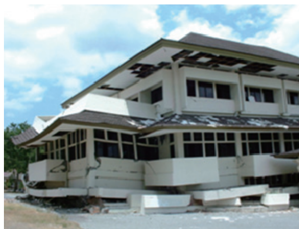
図6 1階が層崩壊した大学校舎 ジョクジャカルタ
