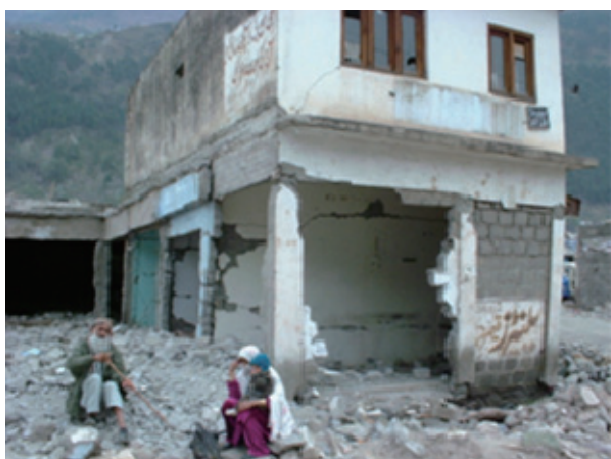
図5 住宅の地震被害 2006 パキスタン
