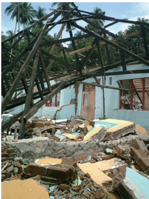
図15 ノンエンジニアド建築の被害 2009 パダン
