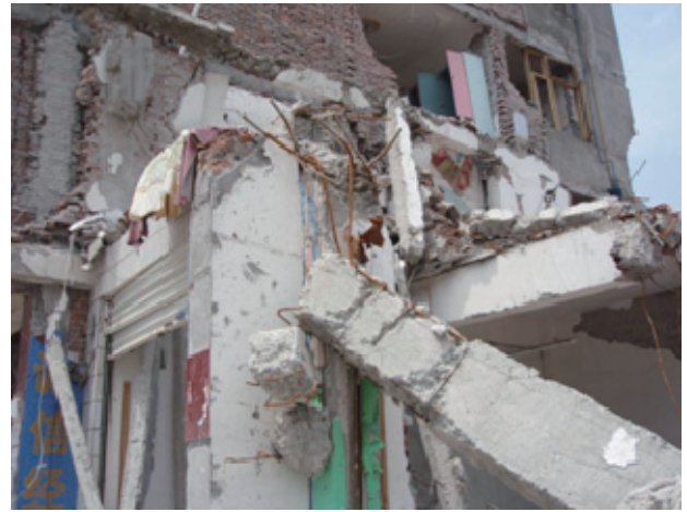
図13 中高層建築の被害 2008 都江堰、四川
