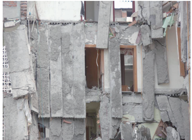
図22 2008年四川地震による建物被害 (2008年6月)
