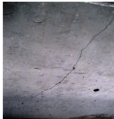
大きなひび割れが入った 床スラブ(下面)
