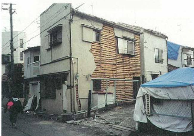
写真3.2.3.15 [復旧事例, 大石2] 被災後の状況 (1995年2月)
