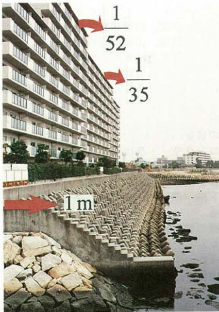
写真3.2.4.3 側方流動によりP C杭が破壊したため傾いた 11階建S R C造マンション
