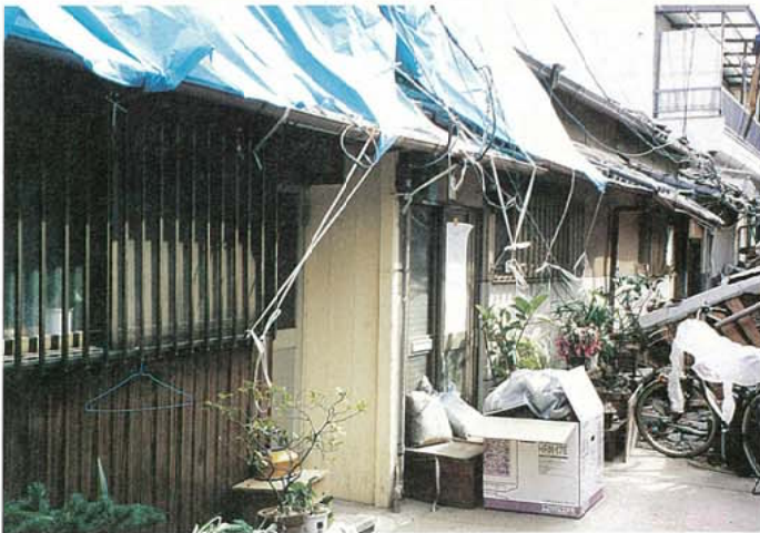
写真3.2.3. 5 [復旧事例、長田2] 被災後の状況 (被害度Ⅱ)
