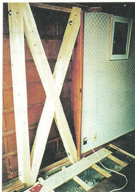
写真3.2.3.39 N氏宅 両筋違い・柱補強 (西第2構面)
