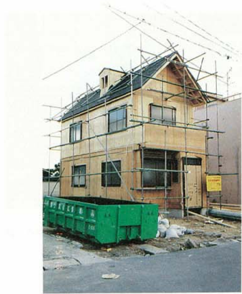
写真3.2.3.32 新築建物の耐力壁（枠組壁工法住宅の外壁長さの問題例）
