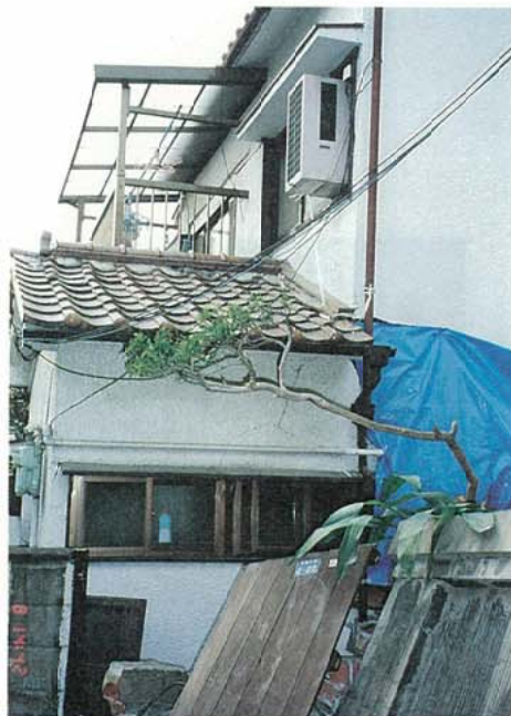
写真3.2.3.13 [復旧事例, 大石1] 被災後の状況 (1995年2月)
