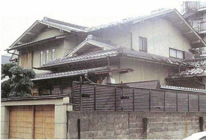
写真3.2.3.53 Y氏宅 被害後の状況(北西より)
