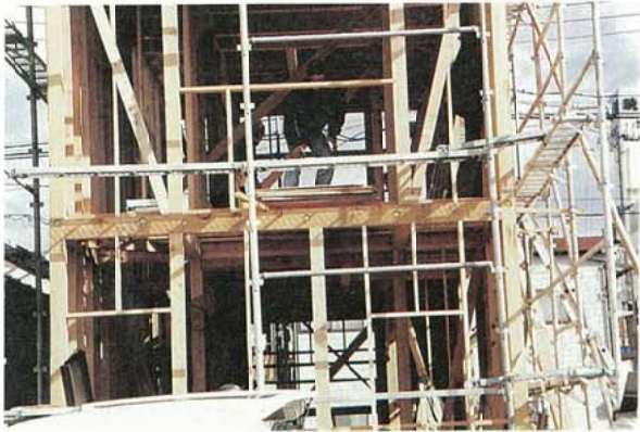
写真3.2.3.31 新築建物の筋交い（補強金物を使用していない例）
