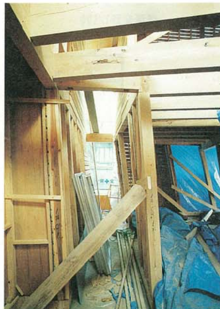
写真3.2.3.48 K動物病院 震災直後内部被害状況
