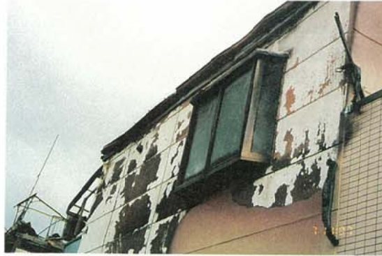
写真1：建築年代が比較的新しく、網入りガラスの入ったアルミサッシ窓を有する建物が焼け止まりとなる事例
