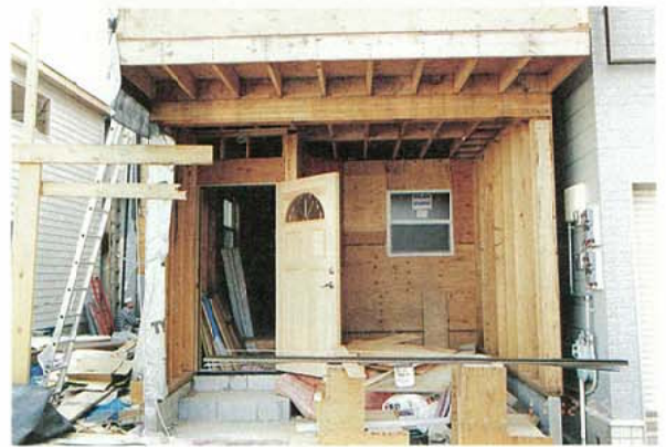
写真3.2.3.34 新築建物の耐力壁（枠組壁工法住宅の上下階の壁面位置の不一致例）
