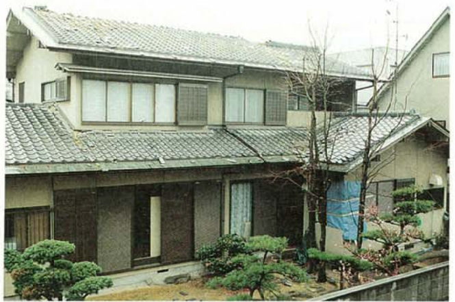
写真3.2.3.54 Y氏宅 被害後の状況(南西より)
