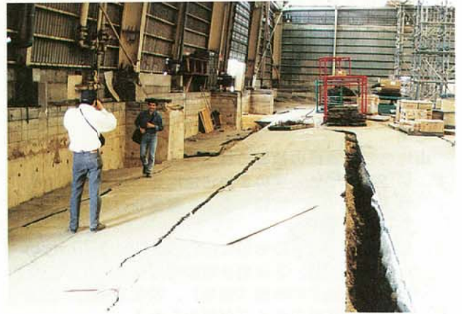
写真3.2.4.2 側方流動により被害を受けた倉庫の内部 (既製杭基礎)
