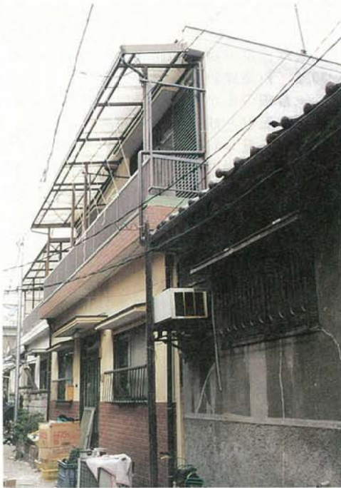
写真3.2.3. 3 [復旧事例、長田1] 被災後の状況 (被害度Ⅰ)
