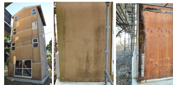
写真 1 4 階建て枠組壁工法実験棟 写真 2 北東隅部北面モルタル外壁の現況 写真 3 北東隅部躯体の腐朽・蟻害
