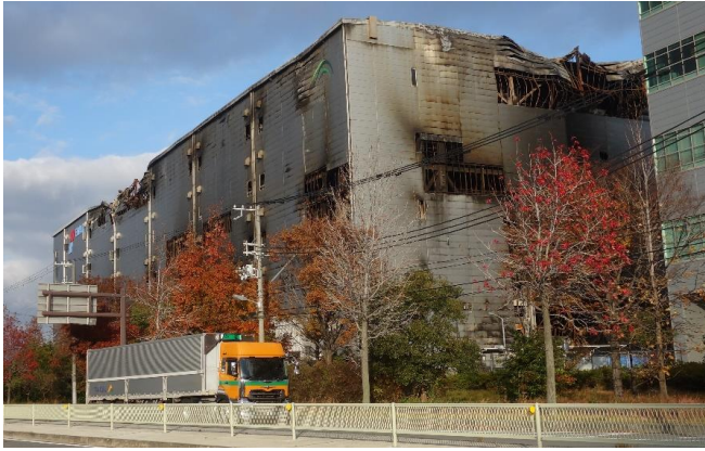
写真-I-1. 2. 1 火災による倉庫の被害状況
