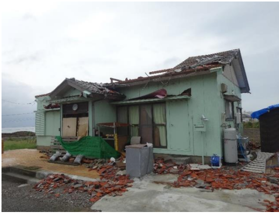
(a) 小屋組が飛散した住宅
