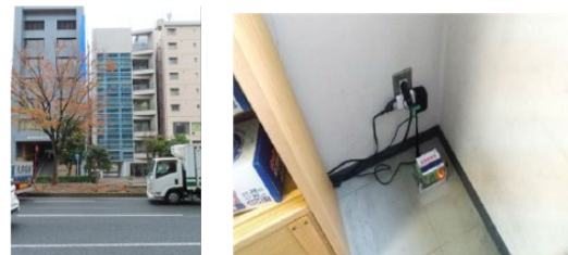
写真3 地震計設置建物と無線式地震計
