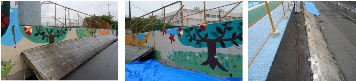
写真-I-1. 2. 3 倒壊した補強コンクリート造ブロック塀の状況
