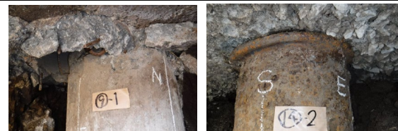
図 1.3 杭被害の事例 (左:既製杭, 右:鋼管杭)
