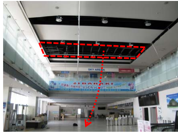
図1 東日本大震災での天井脱落被害例
