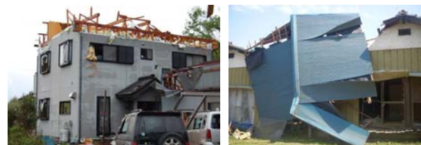
(a) 木造小屋組の倒壊 (b) 飛来物(屋根)の衝突
