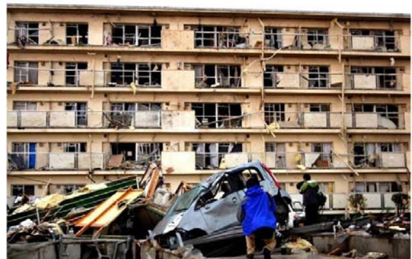
図 4 竜巻による集合住宅の被害状況
