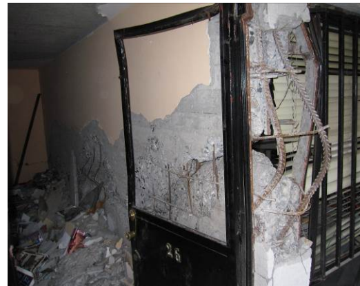
図 1 柱型を省略した連層耐力壁の被害（2010年チリ地震）
