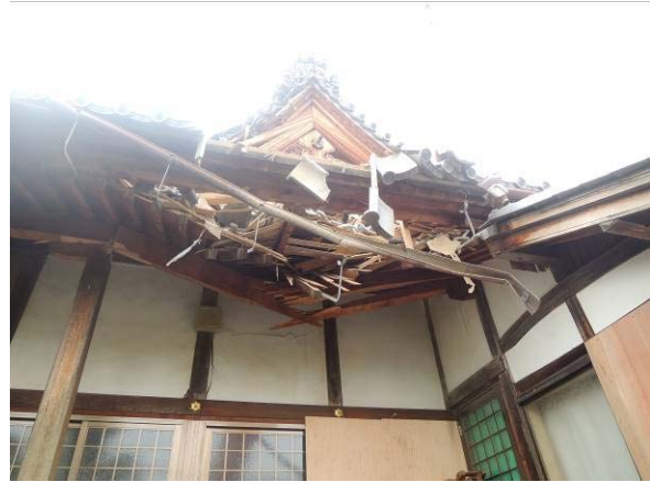
写真 13 鋼製屋根が衝突した範囲の状況
