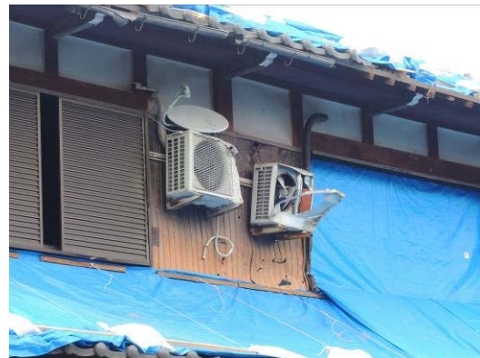
写真 24 室外機の損傷
