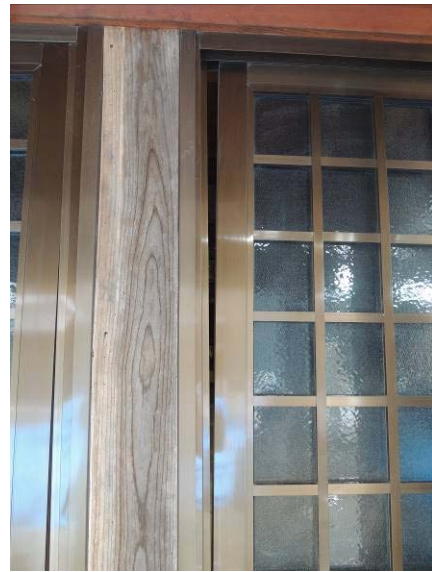
写真 18 寺社 C の建具の状況
