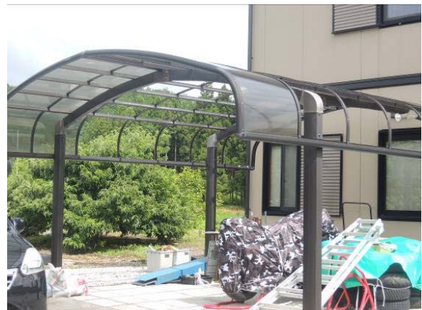
写真 26 カーポートの損傷
