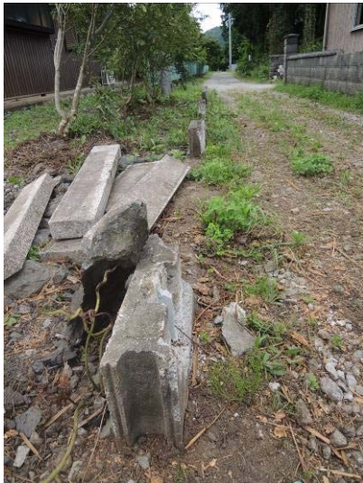
写真 23 フェンスの基礎の損壊
