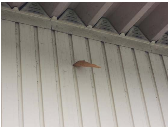
写真 25 外壁材への木材の突き刺さり
