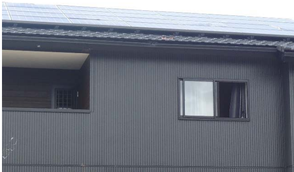
写真 21 太陽光パネルの軽微な損傷
