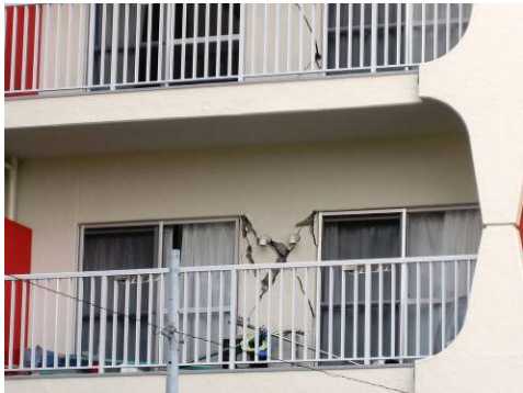
写真 5.2.1-13 非構造壁（ベランダ側）のせん断破壊
