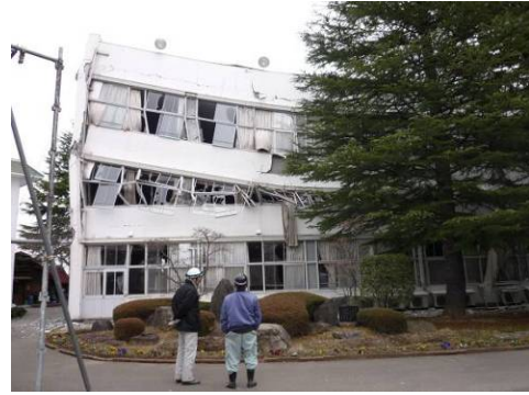
写真 5. 2. 1-2 中間階の層崩壊
