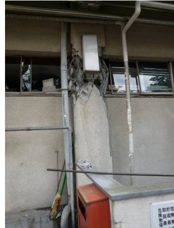
(b) 建築物 I (損傷度 V)
