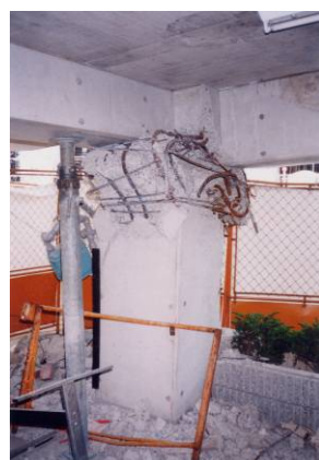
(e) 軸力の大きな柱の破壊 (表 5.2.1-1 の 3))
