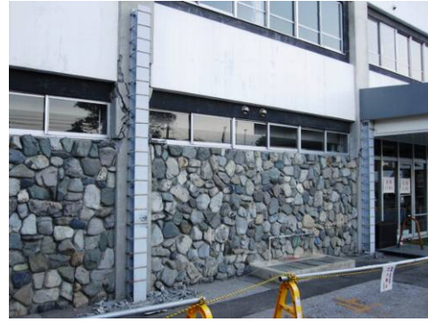
写真 5.2.1-10 応急補強した柱の被害
