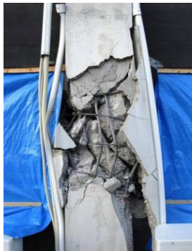
(a) 短柱のせん断破壊
