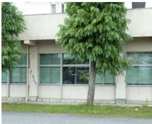
(a) 南側構面柱のせん断破壊
