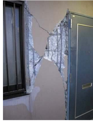
写真 5.2.1-12 非構造壁（玄関側）のせん断破壊
