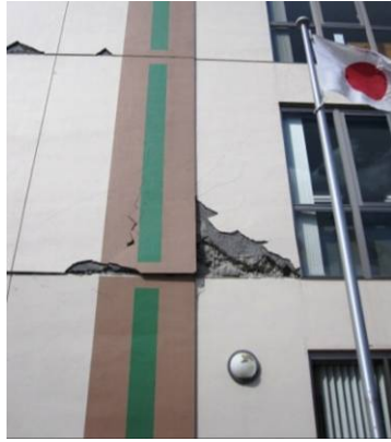
写真 5.2.1-11 袖壁脚部の損傷
