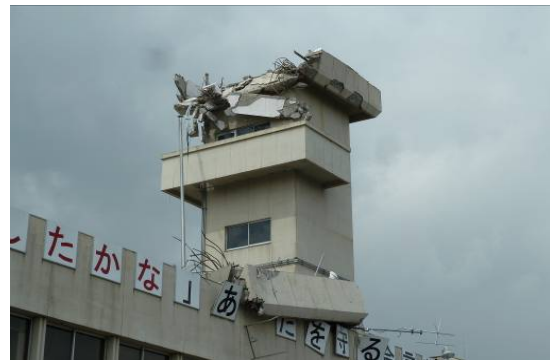
写真 5. 2. 1-4 塔屋の損傷及び落下
