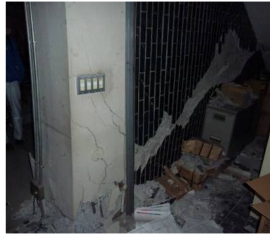
(b) 1階耐力壁のせん断破壊
