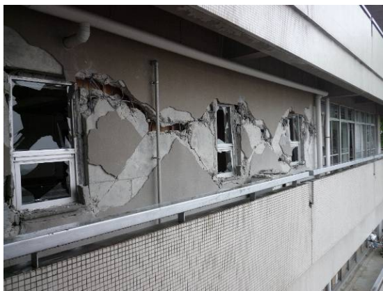
(a) 非構造壁のせん断破壊 (建築物 C)
