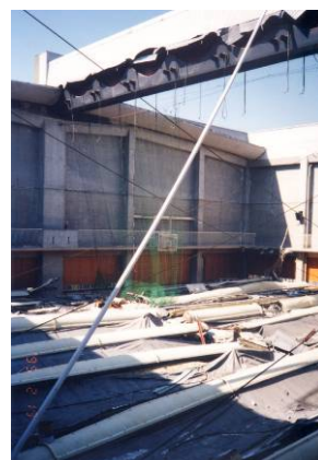
(f) 体育館 PCa 屋根の落下 (表 5.2.1-1 の 22))
