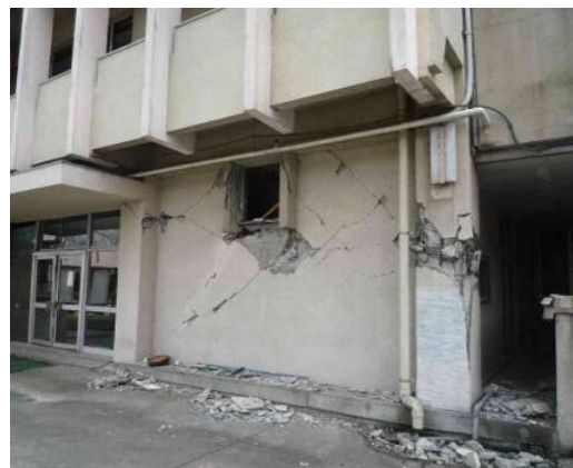
(b) 有開口耐力壁のせん断破壊
