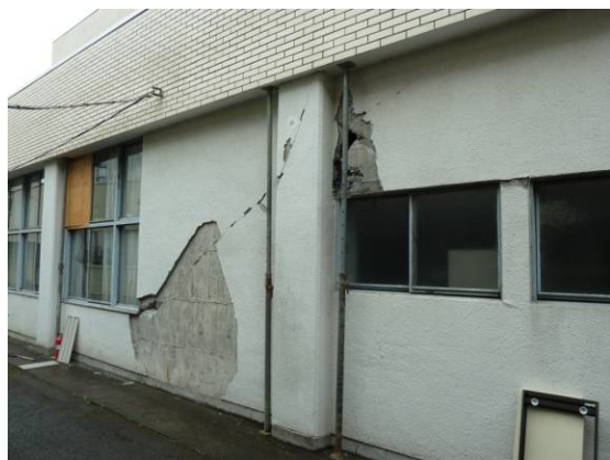
写真 5.2.2-12 そで壁付き柱のせん断ひび割れ (建築物 B、損傷度 IV)
