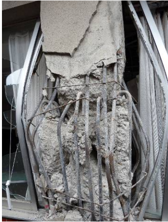
(a) 建築物 C (損傷度 V)
