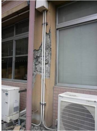
(b) 建築物 F (損傷度 IV)
