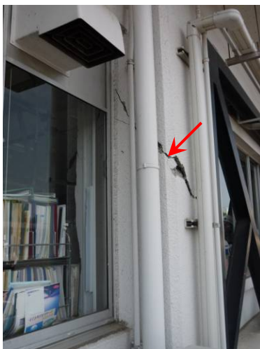
写真 5.2.3.3-3 ブレースが取り付け柱の構面内及び構面外に生じたせん断破壊（C-8）
