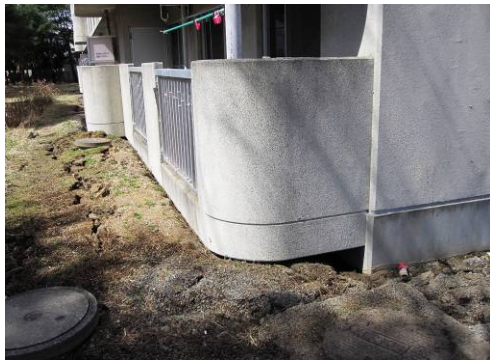
写真 5. 2. 1-3 4階建て建築物の傾斜
