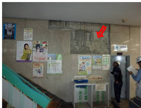
写真 5.2.2-13 耐力壁のせん断ひび割れ (建築物 B、損傷度 II)
