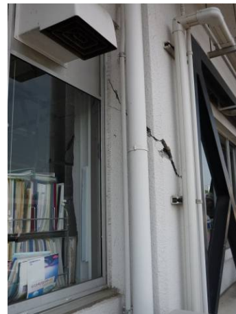
(b) 建築物 J (損傷度 IV)
