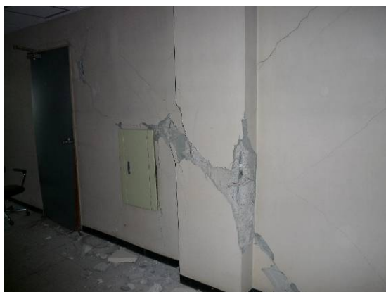
(a) 建築物 C (損傷度 IV)
