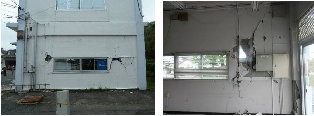
写真 5.2.2-10 コンクリートブロック造壁の被害（建築物 H）
