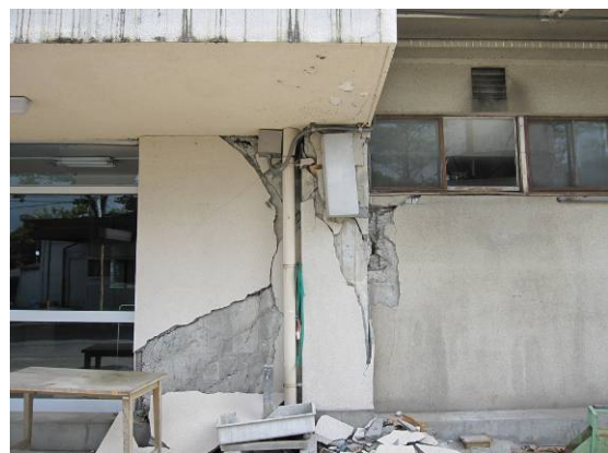
(b) 建築物 I (損傷度 V)
