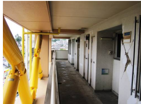
写真 5.2.1-14 制震ダンパーで補強された建築物における非構造壁の被害
