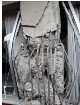
(b) 主筋段落とし部を起点とするせん断破壊
