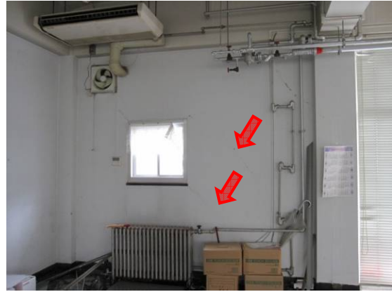
(b) 建築物 G (損傷度 II)
