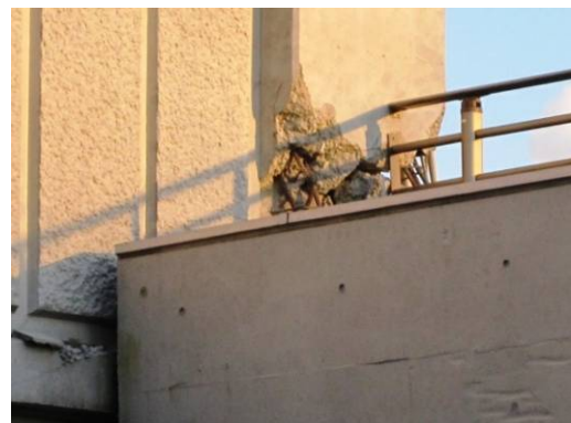
写真 5. 2. 1-6 連層耐力壁側柱脚部の圧壊
