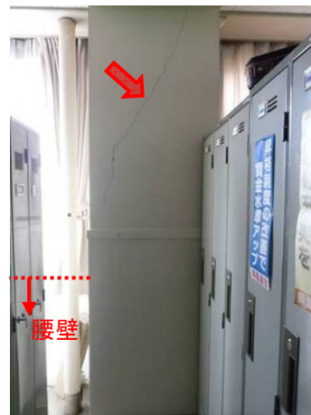
(b) 建築物 E（損傷度 III）
