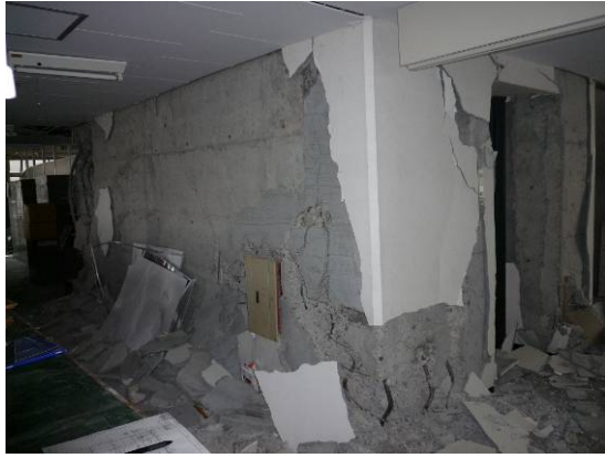
(a) 建築物 C (損傷度 V)
