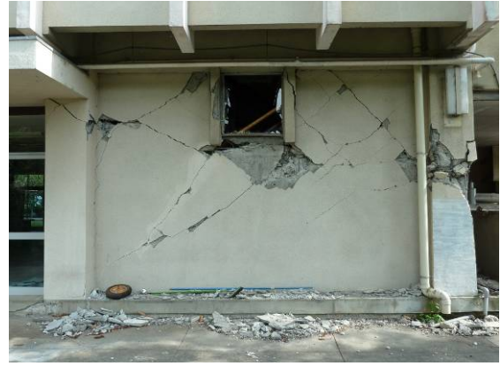
(b) 建築物 I (損傷度 V)
