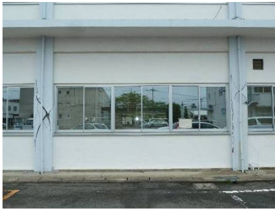
(a) 建築物 H (損傷度 IV)
