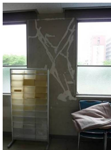
(b) 方立て壁のせん断破壊 (建築物 E：雨漏り防止の暫定補修)
