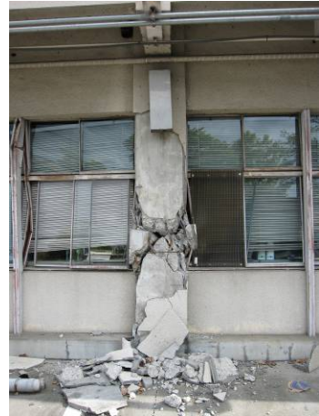
(c) 建築物 I (損傷度 V)
