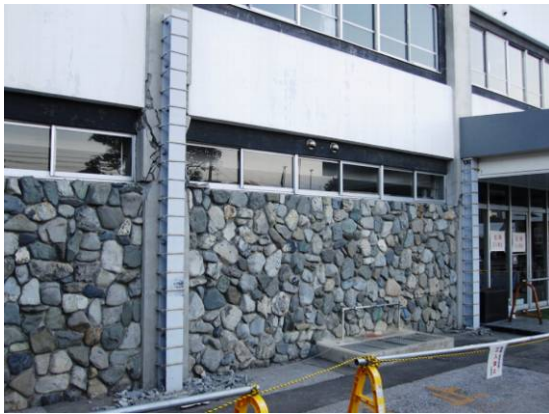
(a) 建築物 A (損傷度 V)
