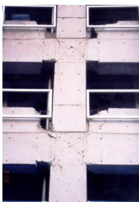
(d) 柱はり接合部の破壊 (表 5.2.1-1 の 10))
