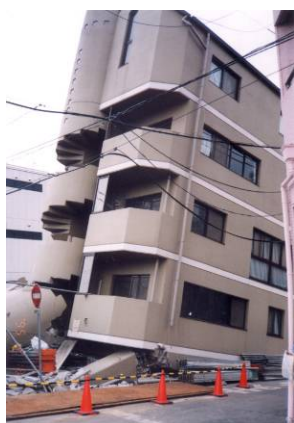
(a) ピロティ階の崩壊 (表 5.2.1-1 の 13))
