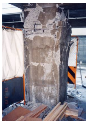
(b) 柱主筋段落とし部の破壊 (表 5.2.1-1 の 4))
