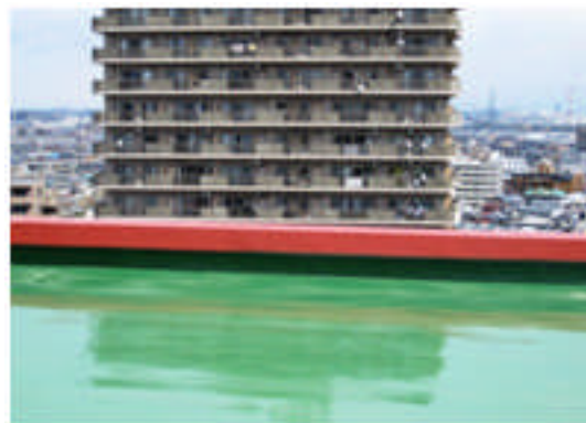
写真 5.4-54 屋上床の傾斜 (パラペットの天端が遠方建築物の床の水平ラインから傾いている)
