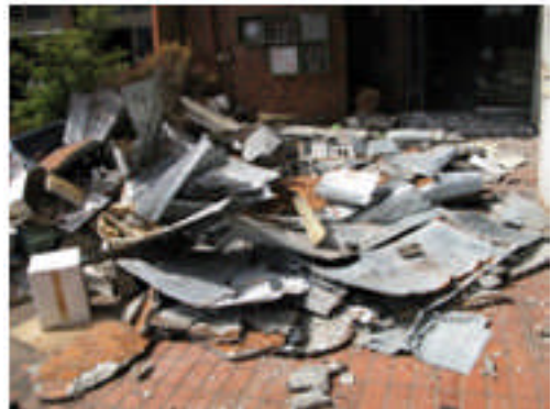
写真 5.4-175 落下した外壁の仕上げ
