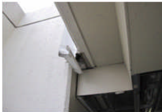
写真 5.4-23 エキスパンションジョイントの損傷
