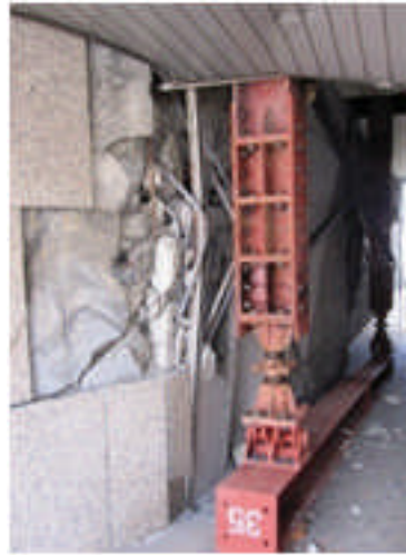
写真 5.4-140 1階柱のせん断破壊
