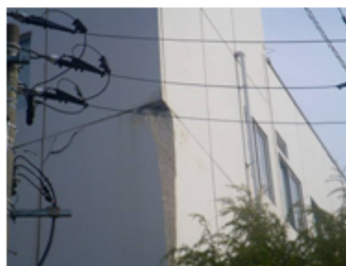
写真 5.4-92 かぶりコンクリートの剥落状況
