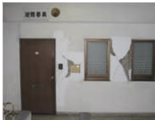
写真 5.4-19 非構造壁のせん断ひび割れ
