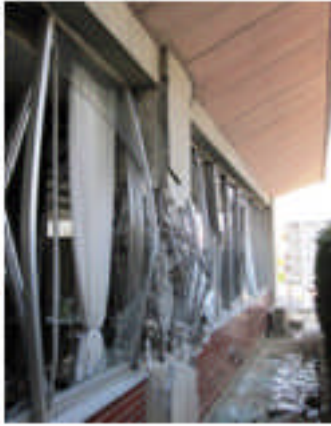
写真 5.4-122 1階柱のせん断破壊
