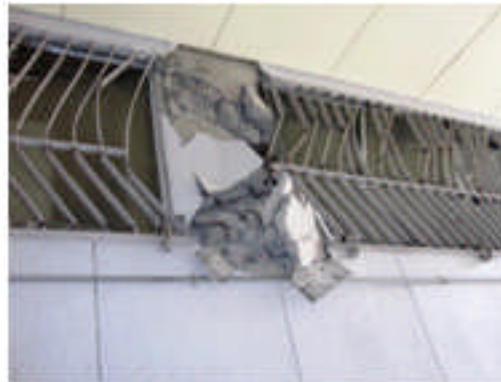
写真 5.4-142 2階の短柱のせん断破壊
