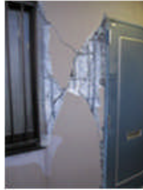
写真 5.4-27 非構造壁のせん断破壊
