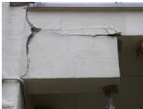
写真 5.4-190 支持部分の損傷 （写真 5.4-189 の○印内）
