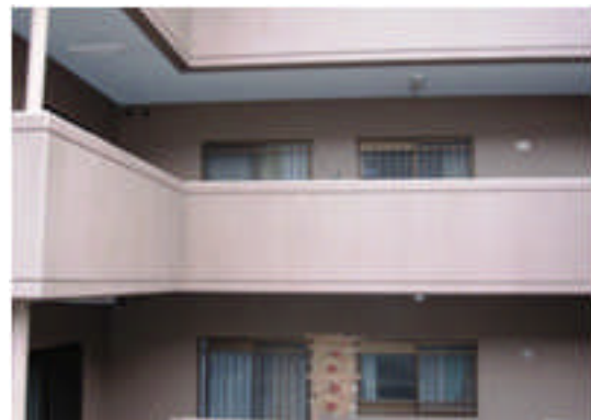
写真 5.4-25 非構造壁のせん断破壊
