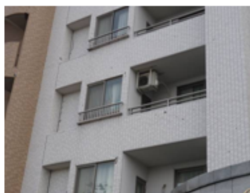
写真 5.4-90 軽微なせん断ひび割れ (梁及び柱)
