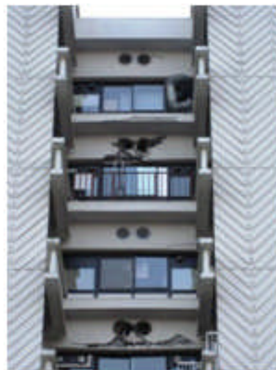
写真 5.4-32 開口付き境界梁の損傷
