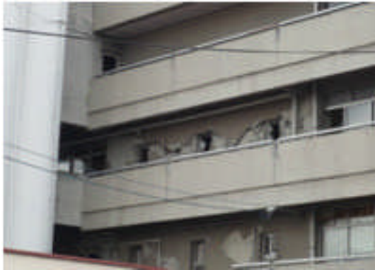
写真 5.4-125 非構造壁の損傷
