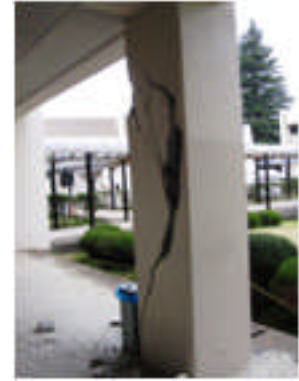
写真 5.4-36 余震でせん断破壊した柱
