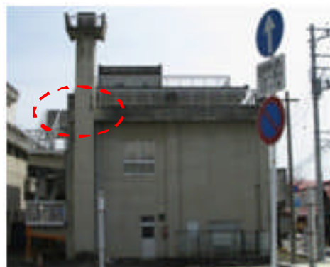
写真 5.4-156 煙突の曲げひび割れ
