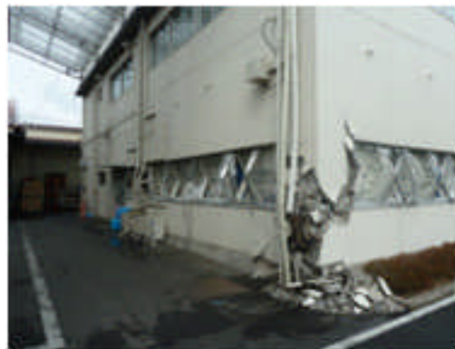
写真 5.4-40 腰壁付き短柱の軸崩壊
