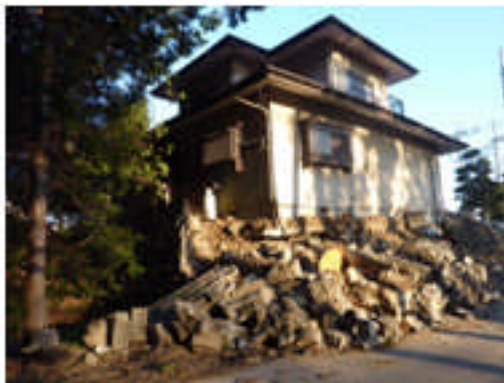
写真 5.4-195 地盤変状の被害
