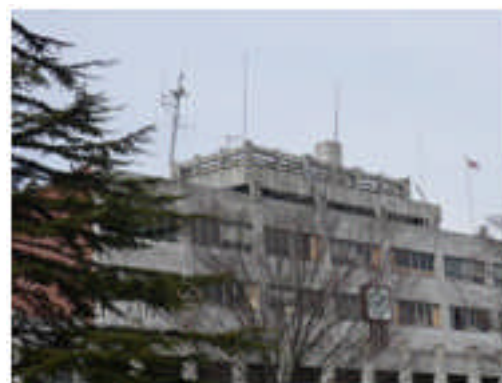
写真 5.4-87 ペントハウス部の損傷
