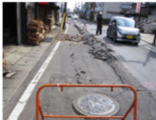
写真 5.4-154 道路の地盤変状
