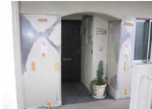
写真 5.4-22 非構造壁のせん断破壊 （損傷部分が養生されている）
