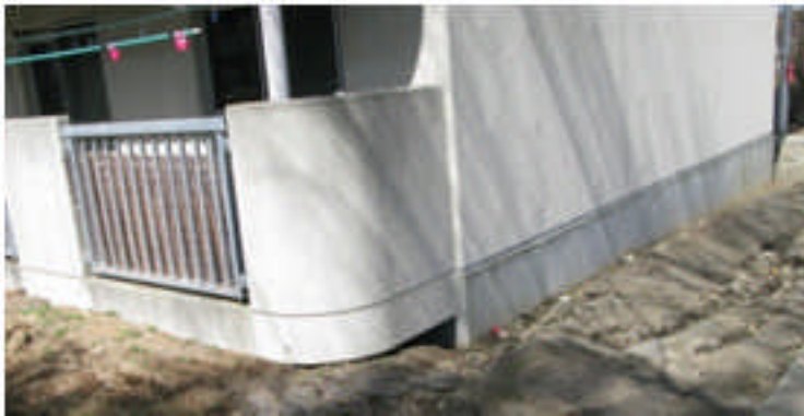
写真 5.4-165 a 棟 (沈み込みの大きい妻面)
