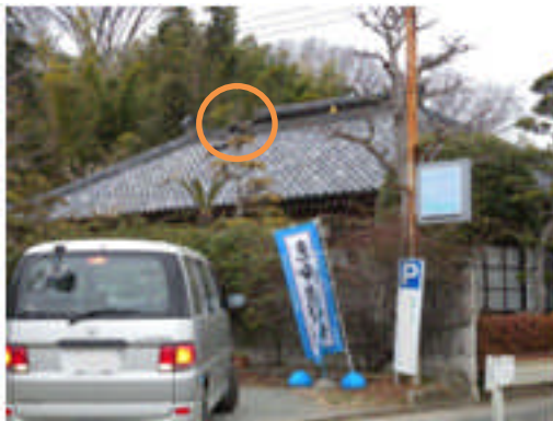
写真 5.4-184 瓦屋根の被害
