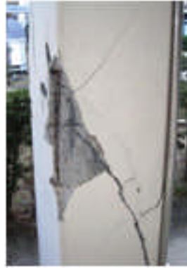
写真 5.4-35 1 階柱のせん断破壊
