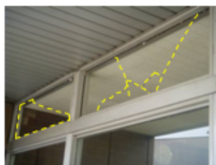
写真 5.4-67 ガラスの破損
