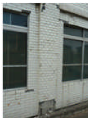
写真 5.4-130 柱脚部の損傷
