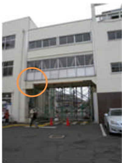
写真 5.4-189 使用禁止の渡り廊下
