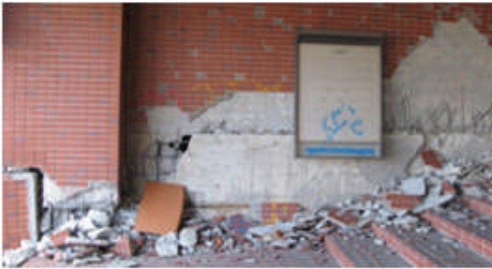
写真 5.4-171 壁及びSRC柱脚の損傷
