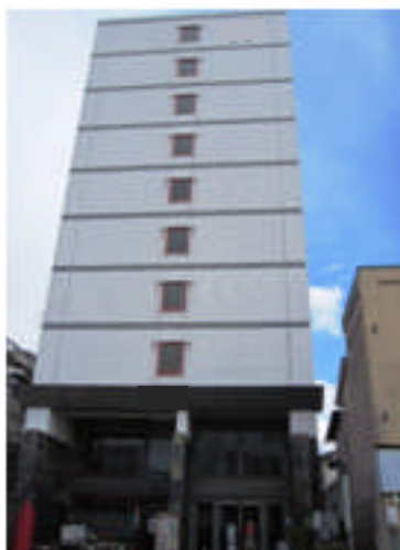
写真 5.4-135 建築物外観 1 (3階壁にせん断ひび割れ)
