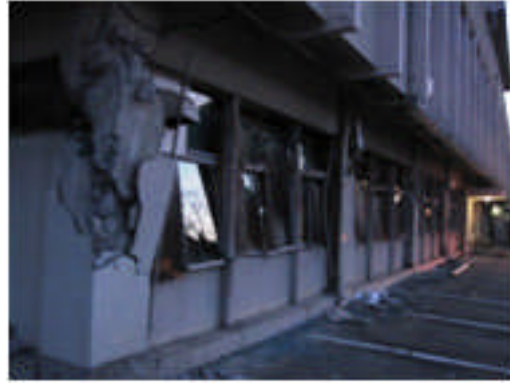
写真 5.4-202 外柱のせん断破壊
