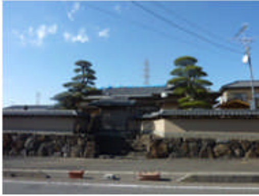
写真 5.4-210 木造住宅の瓦の被害
