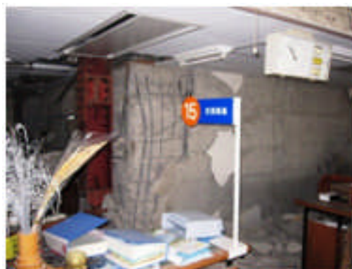
写真 5.4-121 耐震壁側柱の主筋の座屈
