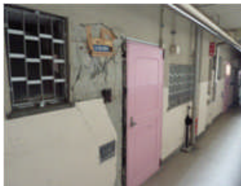
写真 5.4-15 非構造壁のせん断破壊
