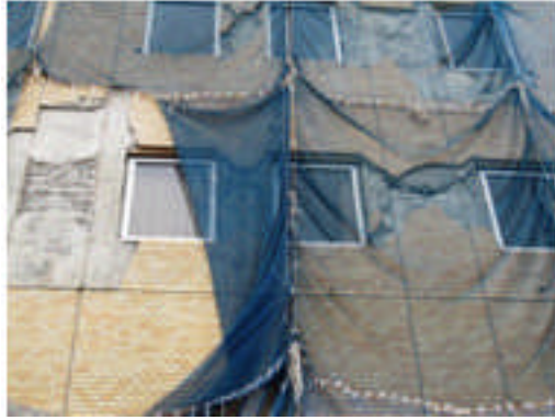
写真 5.4-4 RC 造柱及び非構造壁の損傷
