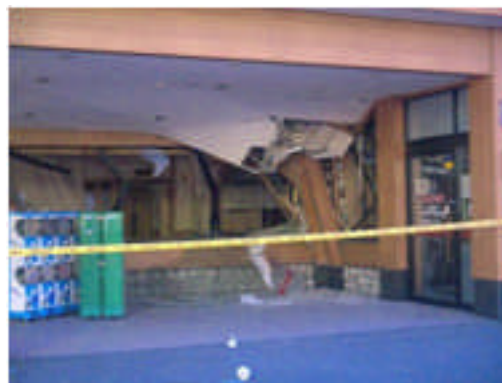
写真 5.4-106 1階隅部の柱と天井の破壊
