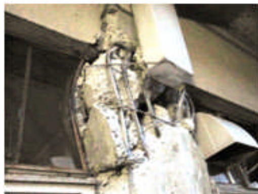
写真 5. 4-200 極短柱のせん断破壊
