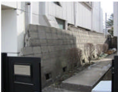
写真 5.4-153 コンクリートブロック塀の倒壊
