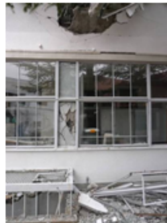
写真 5.4-79 1階柱のせん断破壊
