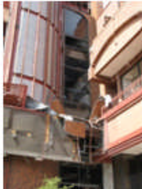
写真 5.4-174 外壁仕上げの落下
