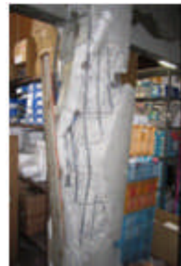
写真 5.4-44 長柱のせん断破壊
