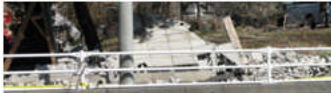
写真 5.4-176 ブロック塀の倒壊
