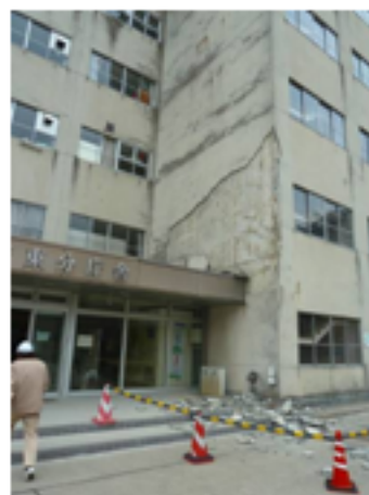
写真 5.4-66 エントランス脇の外壁仕上げの剥落
