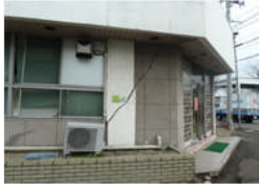
写真 5.4-42 袖壁付き短柱のせん断破壊
