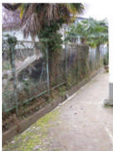
写真 5.4-180 校舎裏のブロック塀の被害
