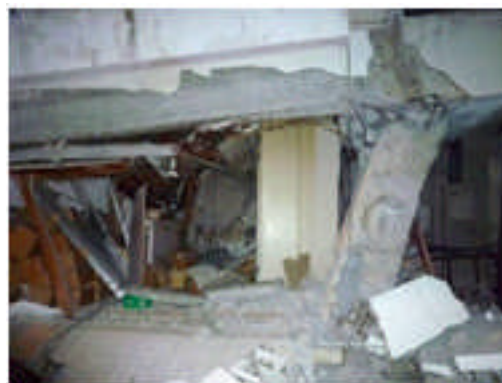
写真 5.4-110 1階柱頭・柱脚の曲げ破壊
