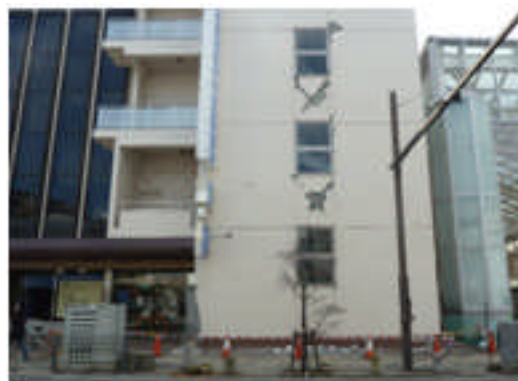
写真 5.4-148 壁の縦開口隅角部を結ぶせん断ひびわれ
