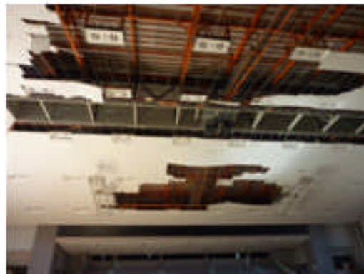
写真 5.4-209 脱落部分の拡大2
