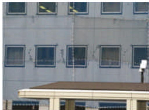
写真 5.4-7 外壁タイルの剥落
