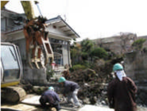
写真 5.4-159 被災したブロック塀（解体中）
