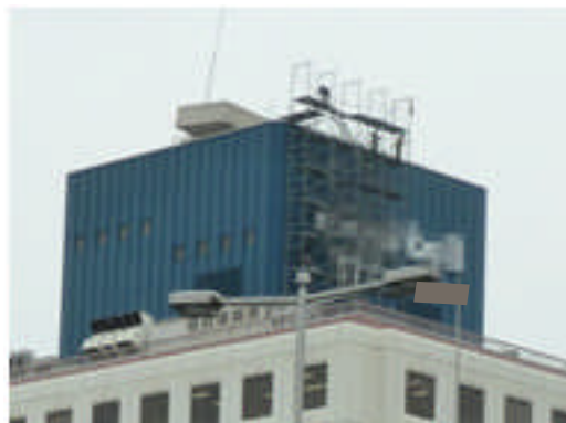
写真 5.4-12 ペントハウスの傾斜
