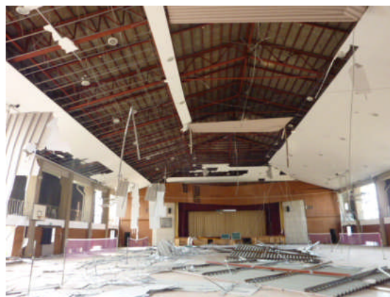
写真 5.3-43 天井材脱落 (MIT-7)
