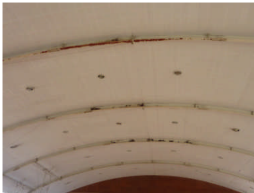
写真 5.3-37 アーチ状の梁中央部塗装の剥がれ(MIT-6)
