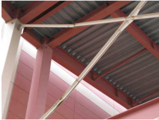
(a) ブレース（山形鋼ダブル）の座屈
