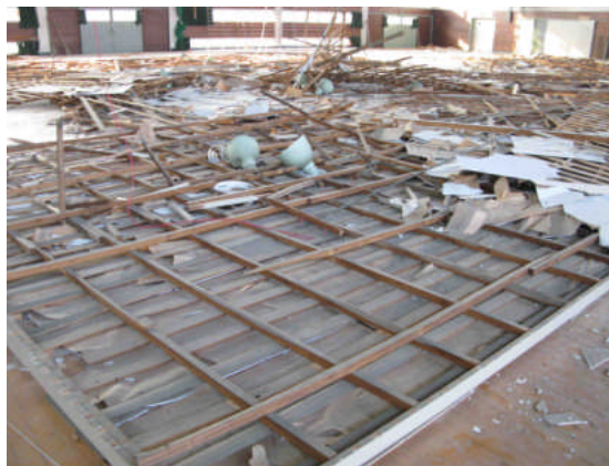
写真 5.3-41 落下した天井と照明 (HTC-4)
