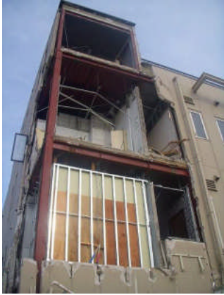
写真 5.3-5 外装材の脱落 (二本松市)
