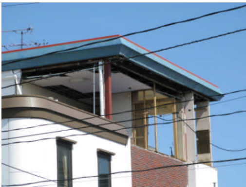
写真 5.3-7 4階建て最上階の外装材等の被害 (須賀川市)
