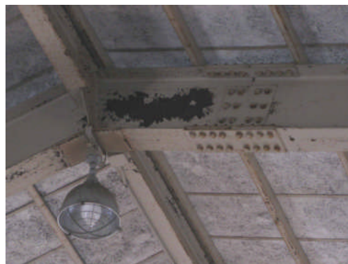
写真 5.3-39 梁ウェブの塗装の剥がれ (MIT-22)
