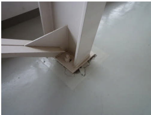
写真 5.3-30 モルタルの損傷 (栗原市)
