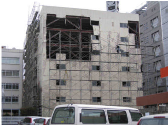
写真 5.3-11 駐車場の外装材の脱落（水戸市）
