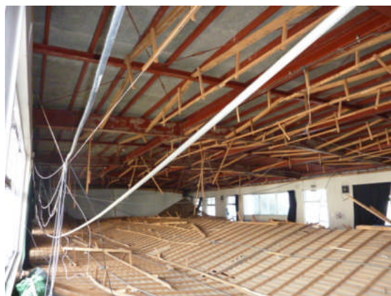
写真 5.3-42 天井材脱落 (MIT-5)
