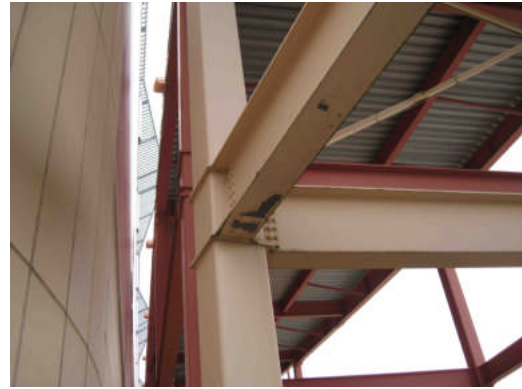
(b) 梁端部塗装の剥がれ
