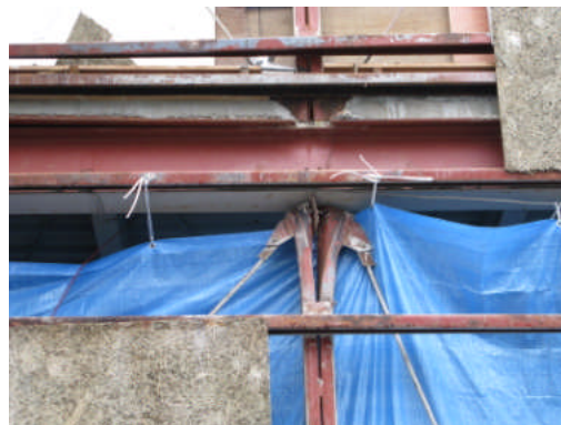
写真 5.3-2 S 造のブレース付き間柱接合部の変形 (仙台市若林区)
