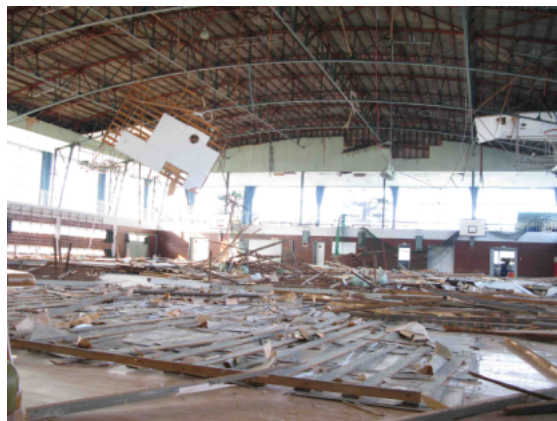
写真 5.3-40 天井材脱落 (HTC-4)
