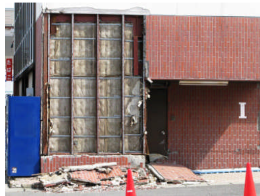
写真 5.3-8 ラスモルタル仕上げの剥落 (須賀川市)
