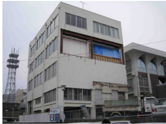
写真 5.3-12 事務所の外装材の脱落（水戸市）
