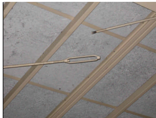
写真 5.3-28 ターンバックルの破断(MIT-25)
