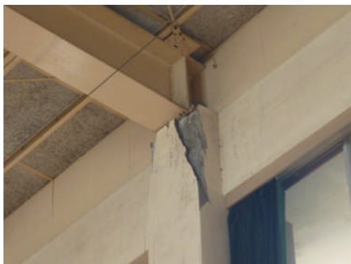
写真 5.3-21 仕上げモルタルの剥落 (MIT-25)
