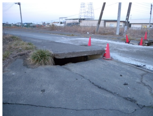
写真 4 2 周辺歩道部分の被害(段差約 40cm)
