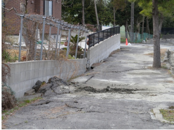
写真27 歩道部分の沈下に伴う塀の被害
