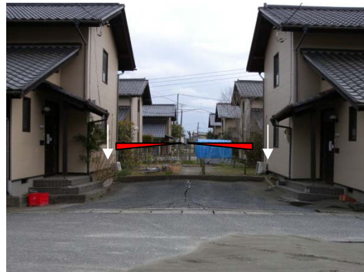
写真30 空地を挟んだ2棟の沈下
