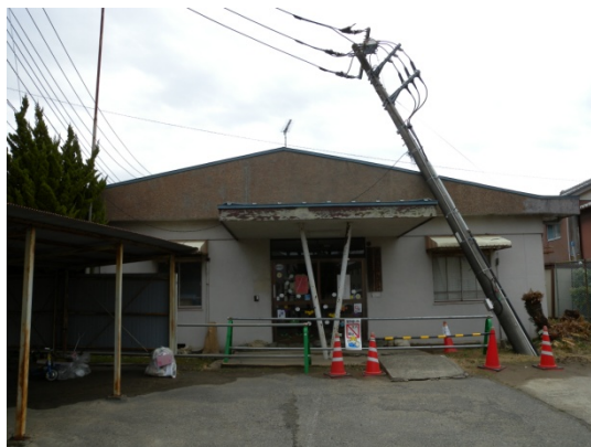
写真3 保健センター入口付近の状況
