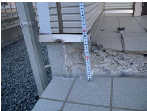
写真 4 1 建築物入口付近の段差
