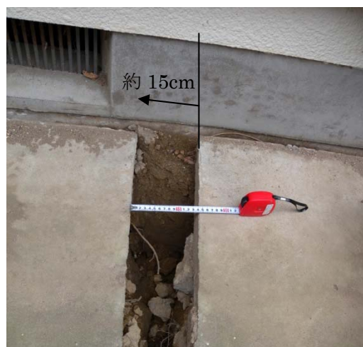
写真8 離間 (基礎は外観上ひび割れ等なし)
