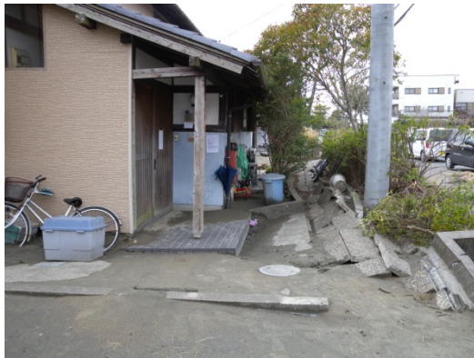
写真29 住宅玄関付近の沈下
