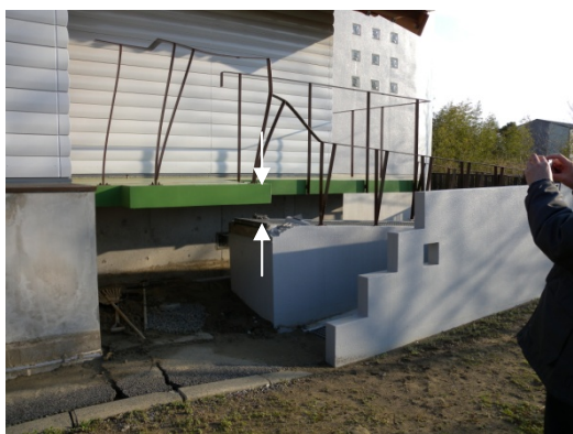
写真 3 5 スロープ部の段差
