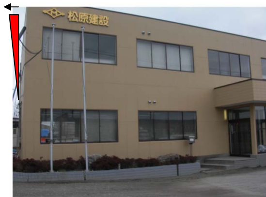
写真15 沈下・傾斜した事務所ビル (同) (長辺方向 5.6/100、短辺方向 1.2/100)
