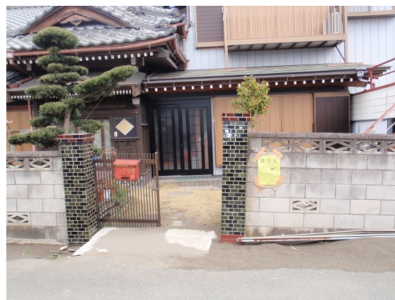
写真6 ブロック塀の段差
