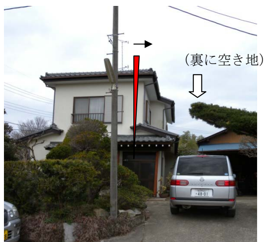
写真7 傾斜 4/100 程度の建築物
