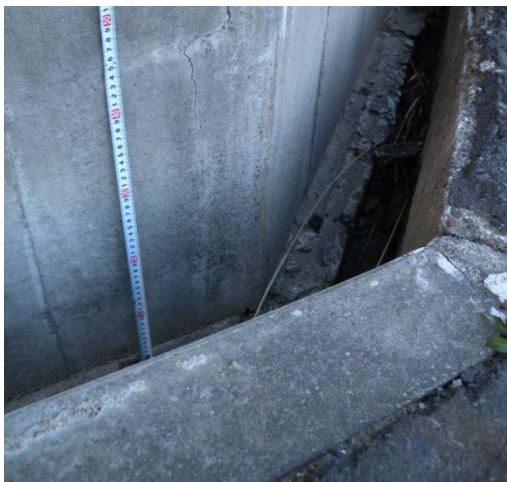
写真 3 9 外周部塀と前面道路との段差
