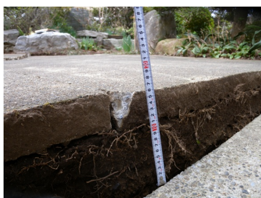
写真9 入口付近の沈下
