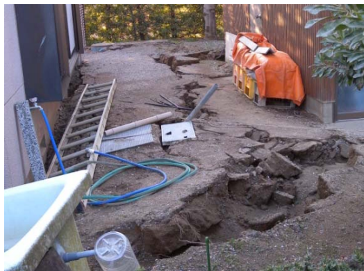
写真 3 7 敷地内の地割れ
