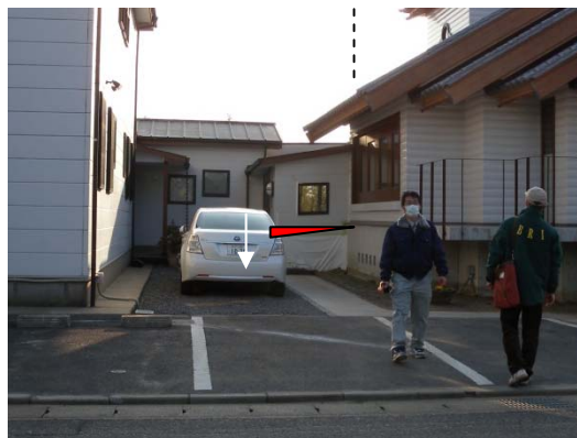
写真 3 6 接続部分の損傷及び駐車場
