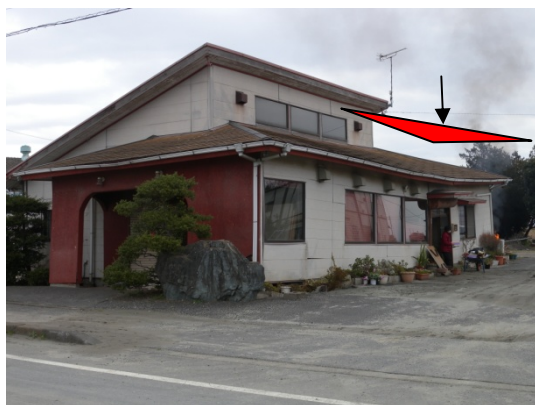
写真17 中央が不同沈下した建築物 (手前側が県道11号)
