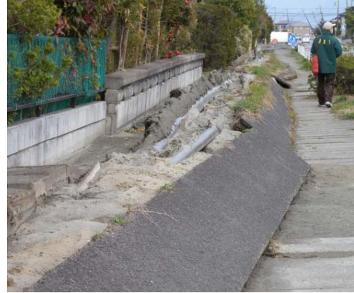
写真28 歩道脇の埋設配管の浮き上がり
