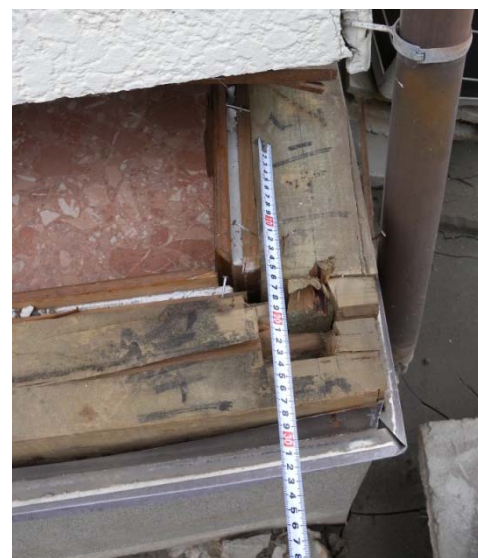
写真18 約25cmのずれを生じた土台 (手前側が県道11号)
