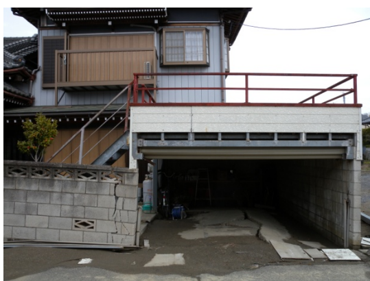
写真5 周囲の住宅被害(土間コンクリート破損)
