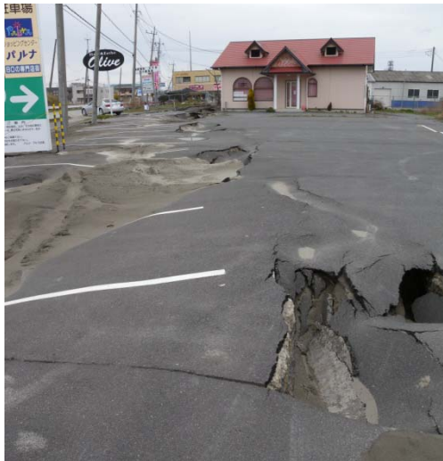
写真13 駐車場路面の変状 (左側が県道11号)
