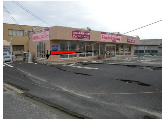
写真14 片側が不同沈下した建築物 (同)
