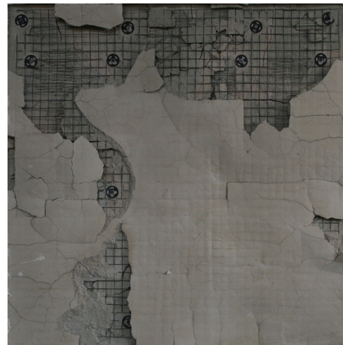
写真-3.2.6 耐火試験後の状況 (No. 5) [P3] (耐火試験後の損傷状態… IV : 部分的な内部の爆裂)
