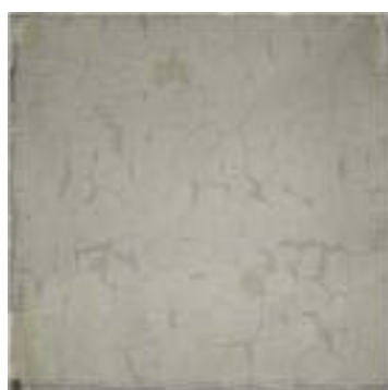
状態Ⅰ：ひび割れ
