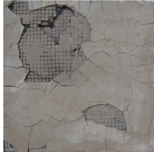
写真-3.2.8 耐火試験後の状況(No. 6) [E3-A] (耐火試験後の損傷状態…IV : 部分的な内部の爆裂)
