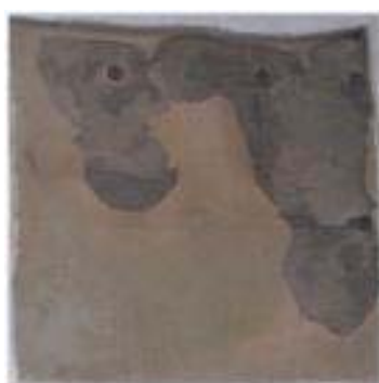
状態Ⅳ：部分的な内部の爆裂
