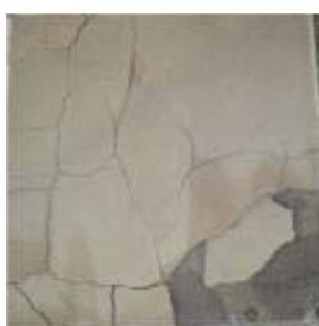
状態Ⅱ：金網より表層のみの剥落
