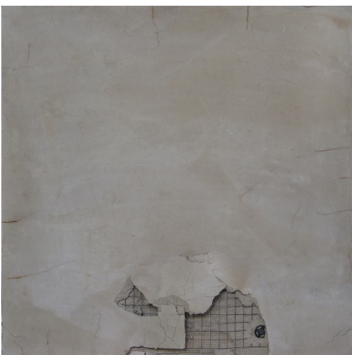
写真-3.2.11 耐火試験後の状況(No. 8) [E3-C] (耐火試験後の損傷状態…II : 金網より表層のみの剥落)
