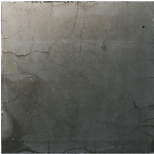
写真-3.2.3 耐火試験後の状況 (No. 1) [P1] (耐火試験後の損傷状態… I : ひび割れ)
