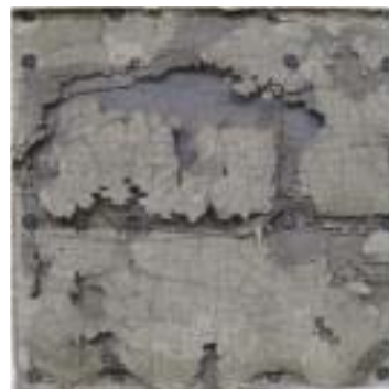
状態Ⅴ：全面的な内部の爆裂
