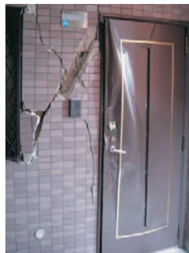
写真2 2005年福岡県西方沖地震において壁部材が損傷し、ドアの開閉が困難となったマンション
