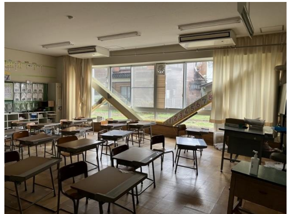
写真 5.4.2-36 1 階での床面の盛り上がり (教室棟)
