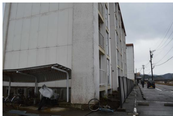
写真 5. 4. 2-40 周辺地盤の沈下による 駐輪場ポートの被害
