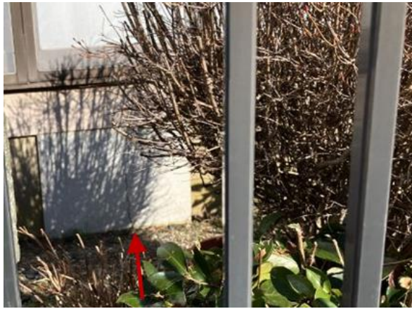
写真 5.4.2-3 住宅の基礎立上り部のひび割れ
