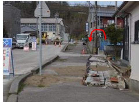
j) 擁壁の転倒
