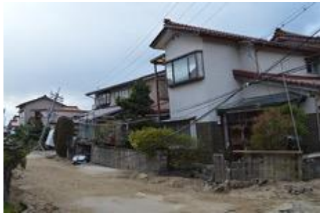
m) 住宅の沈下
