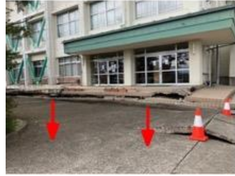
f) 周辺地盤が沈下した建物
