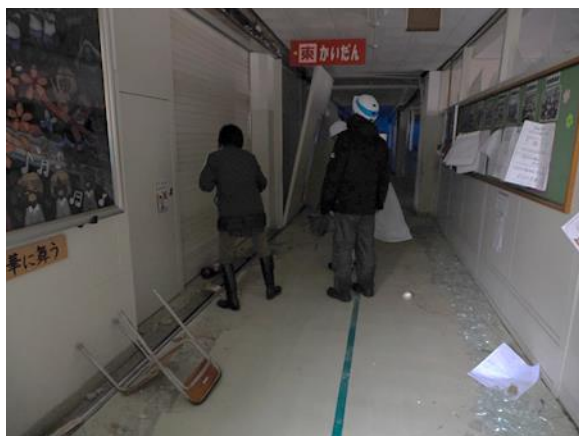
写真 5.4.2-37 建物内部のガラスの散乱状況
