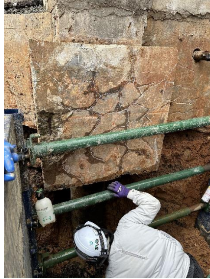
写真 5. 4. 2-54 杭④パイルキャップの被害状況
