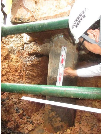
写真 5. 4. 2-53 杭④の被害状況
