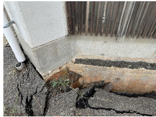
写真 5.4.2-50 基礎ばり周囲の沈下 (X4-Y15位置)
