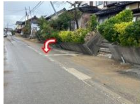
h) 傾斜した擁壁
