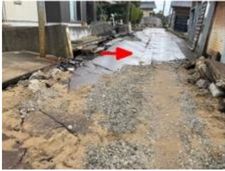
e) 側方流動した地盤
