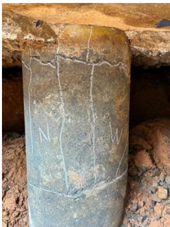
写真 5.4.2-51 杭③の被害状況
