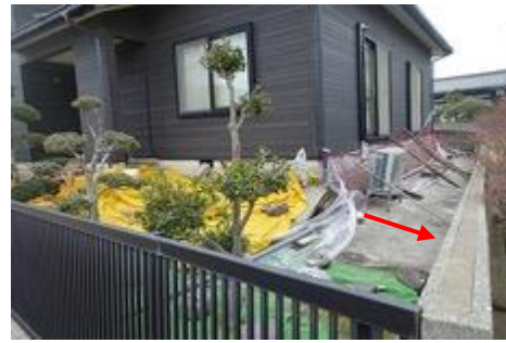
n) 住宅周辺の地盤変状
