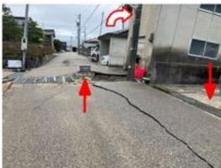
c) 浮き上がった地下埋設物と傾斜した建物
