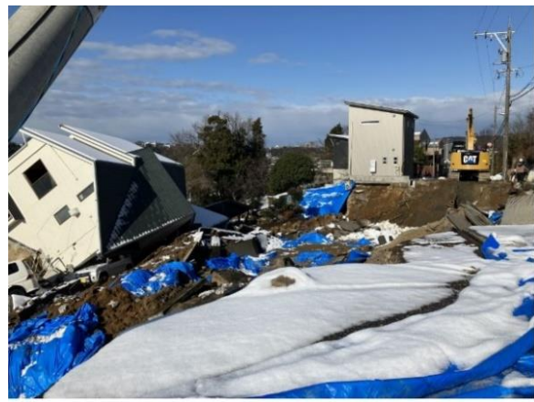
写真 5.4.2-2 崩壊した斜面の状況②
