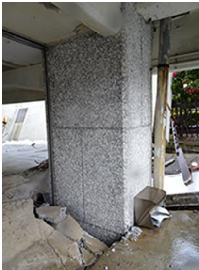
c) 北東隅柱の沈下状況
