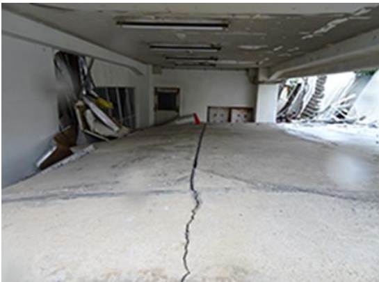
a) 駐車スペース床面の盛り上がり
