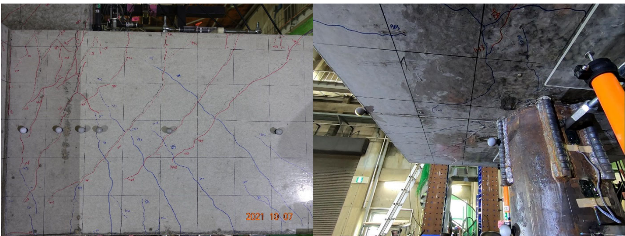
図・写真 3. 2. 3-27 試験体 DR-2 ひび割れ状況 (7Cycle)
