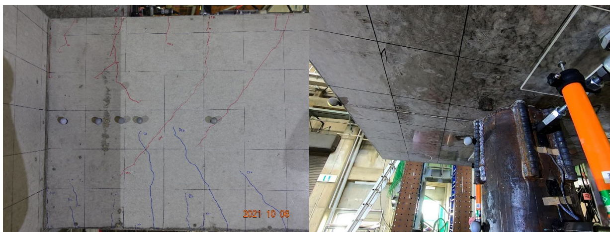
図・写真 3. 2. 3-23 試験体 DR-2 ひび割れ状況 (3Cycle)
