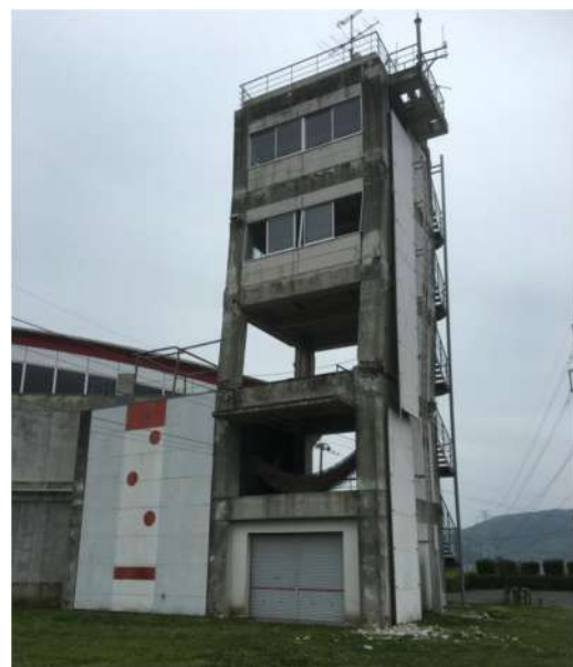
(b) 本震後の被害 (Ya2 構面)
