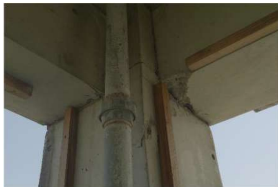
(d) 前震後の4階大梁の損傷 (Ya2 構面, 図 3.2.4 における A 部分)
