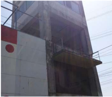
(a) 前震後の被害 (Ya2 構面)
