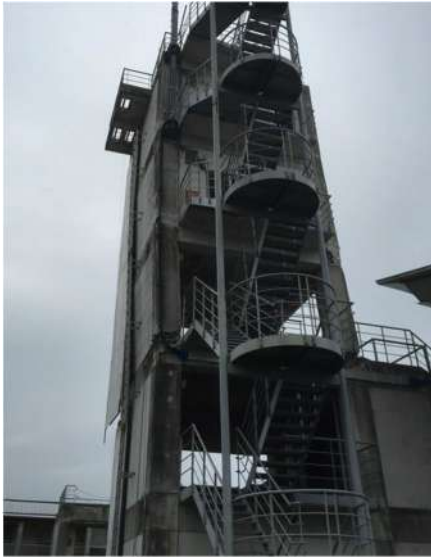
(c) 本震後の被害 (Ya1 構面)
