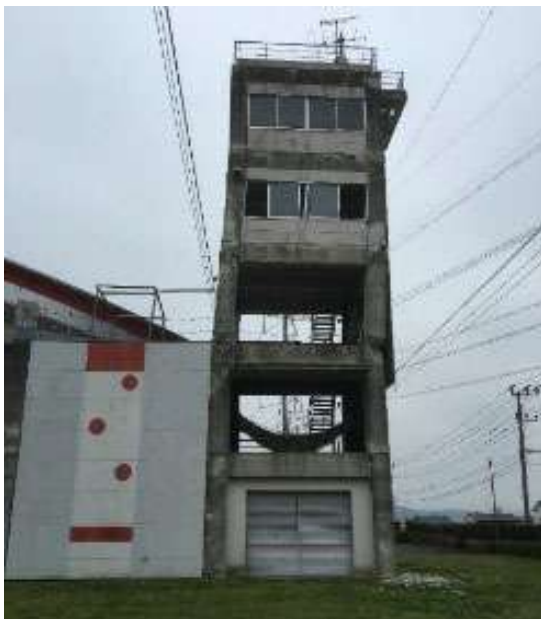
(a) 本震後の被害 (Ya2 構面)
