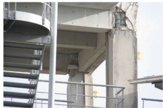
(f) 4階柱梁接合部の損傷 (Ya1 構面, 図 3.2.4 における H 部分)
