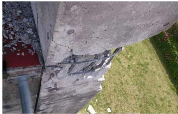
(b) 前震後の3階柱脚接合部周辺の損傷 (Ya2 構面, 図 3.2.4 における A 部分)
