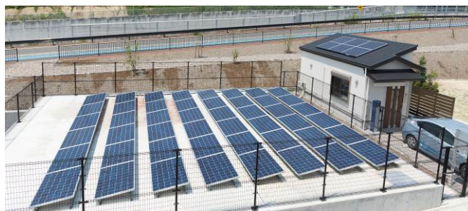
公共施設用地上に設置した共用の太陽光発電
