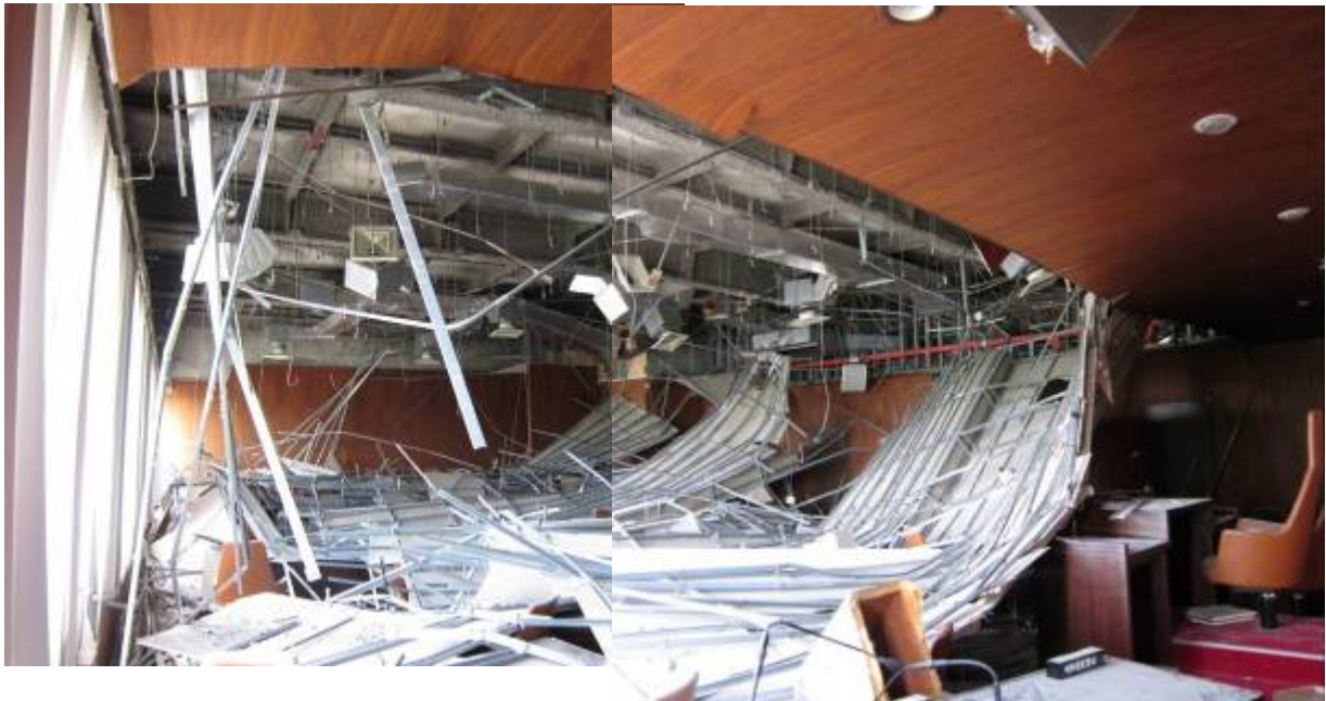
写真 I.1 天井脱落被害（3階議場）
