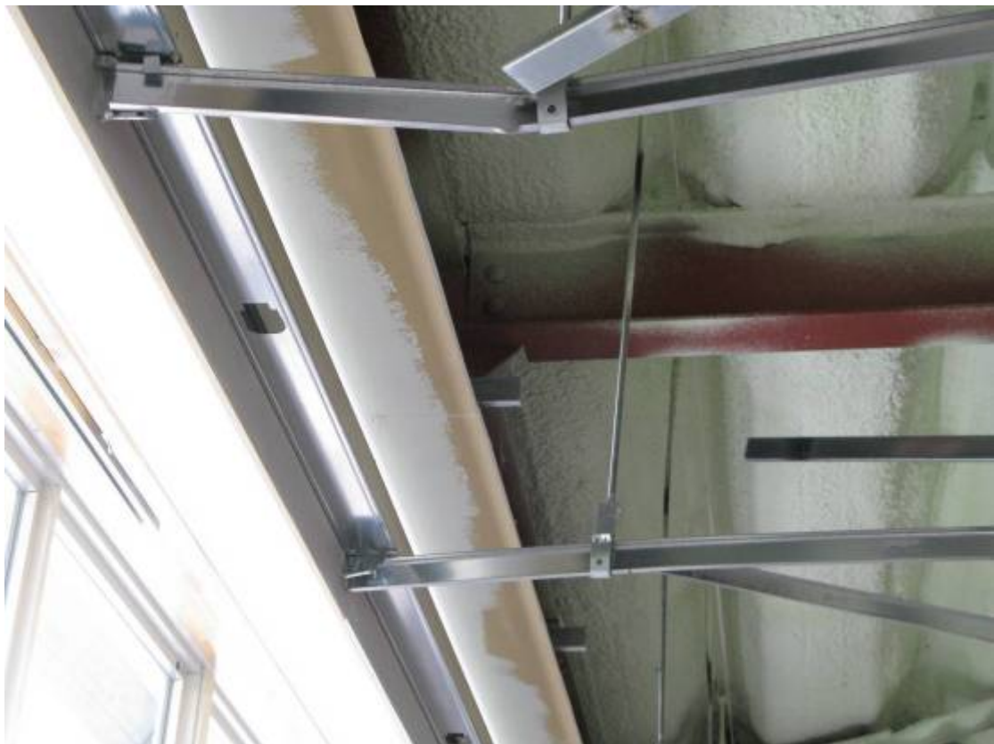
写真E.8 野縁受け方向端部の状況（窓側の天井と、アリーナ天井端部の折り上げ部の間に隙間）
