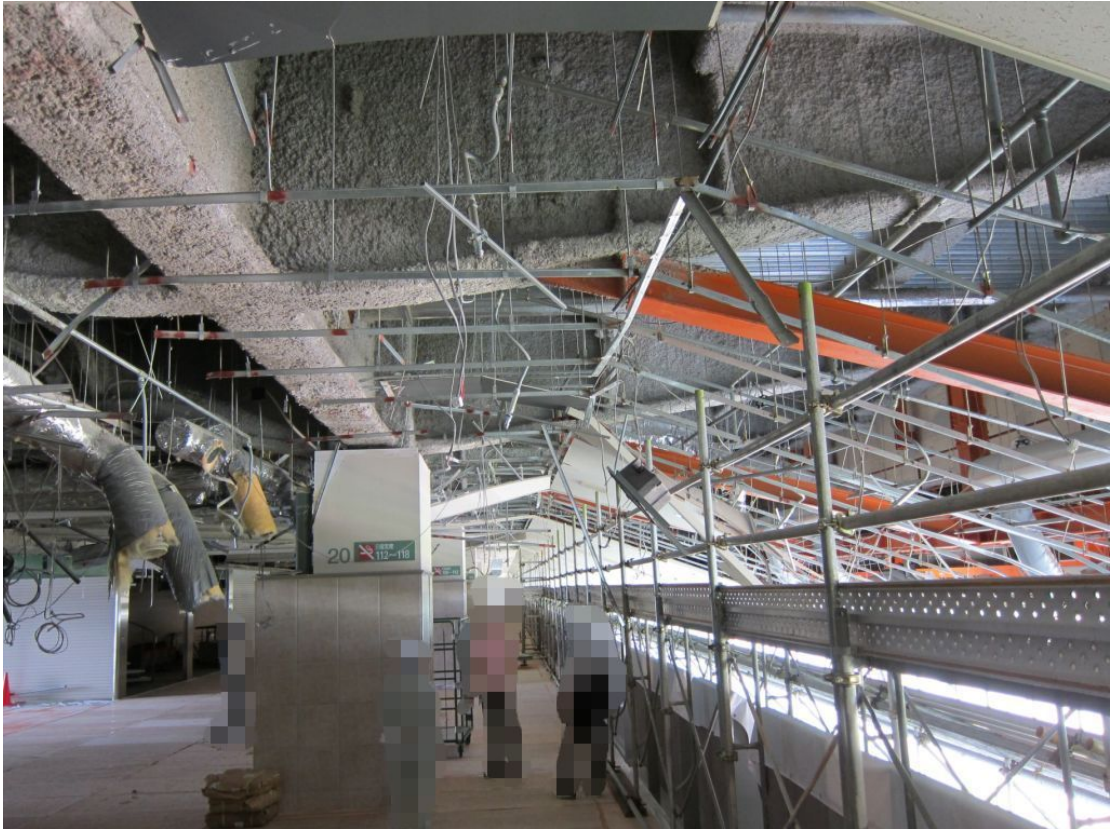
写真 H.5 5階の天井脱落被害
