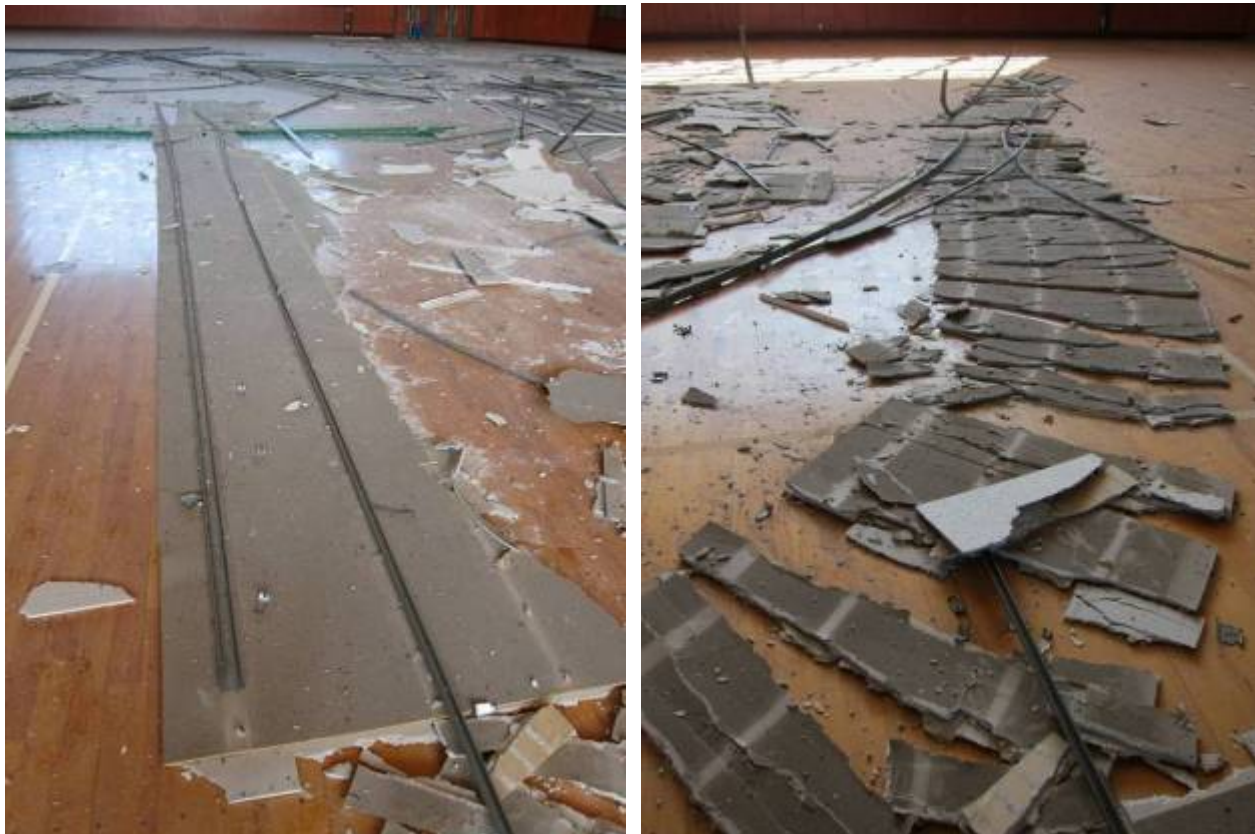
写真B.10 床面に落下した天井
