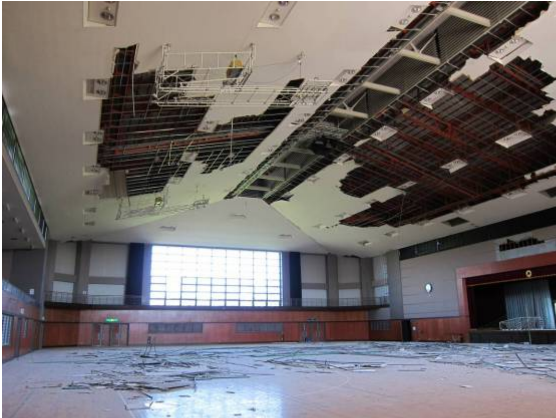
写真 B.1 脱落した天井
