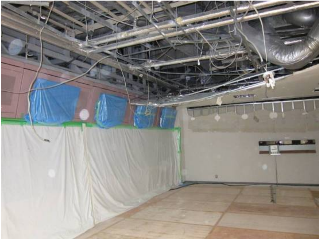
写真 H.1 6階における天井脱落
