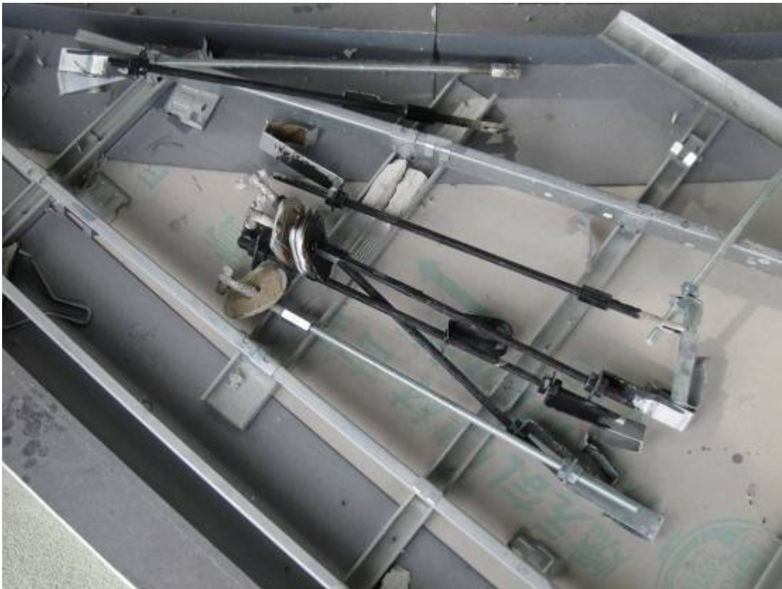
写真 G.6 落下した天井に使われていた部材
