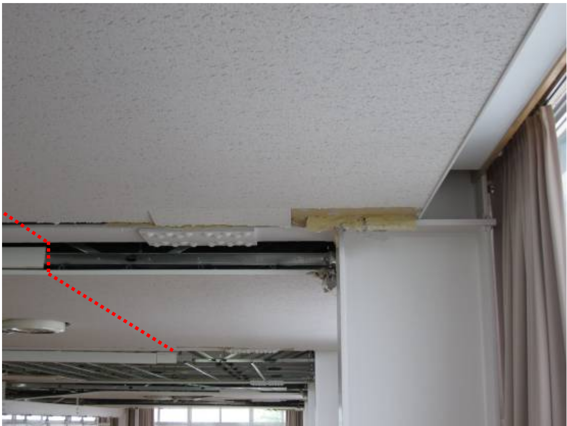
写真 E.2 天井面を桁行方向、南方向に見通した様子 (東西方向に架かる梁の下フランジに、南側の天井面は下がり壁で接し、北側の天井面は端部で接する)
