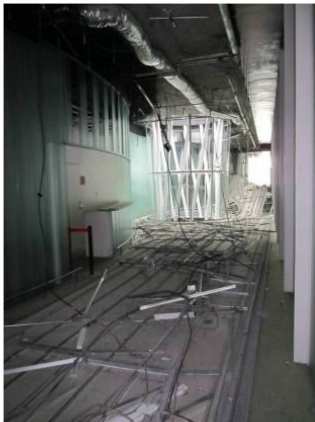
写真 G.4 天井被害の状況（施設提供写真）
