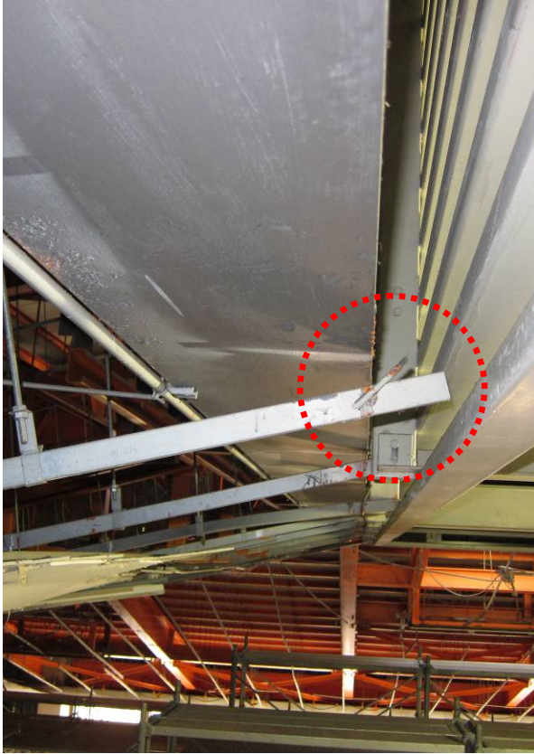
写真 B.3 天井上端部の取り合い（北側） （円内の溶接部分は損傷している）
