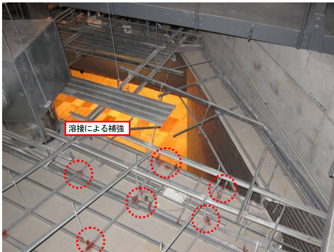
写真 C.7 損傷した天井端部の下地の状況
