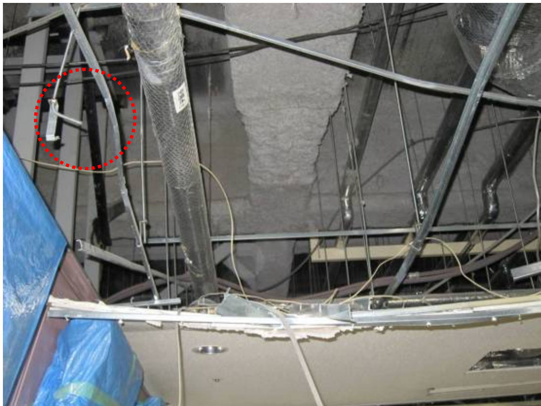
写真 H.2 上記被害箇所の詳細 (赤点線円内でハンガーの開きと野縁受けからの外れ)
