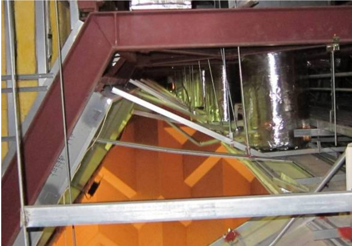
写真 C.5 シーリングスポット室周りの天井の被害
