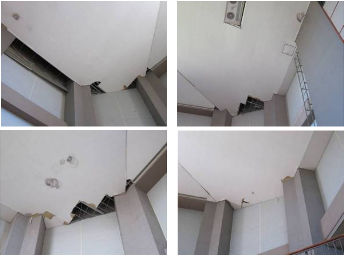
写真 B.2 隅部での天井の損傷
