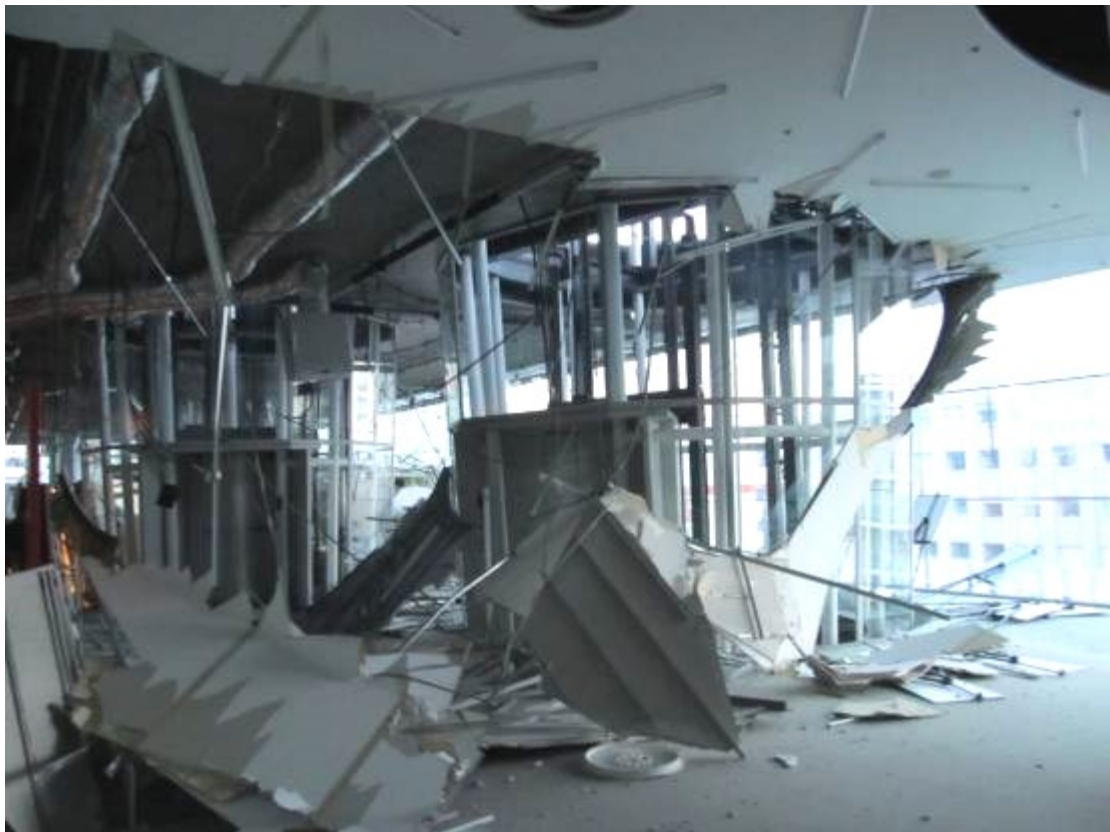
写真 G.2 天井脱落の状況（施設提供写真）
