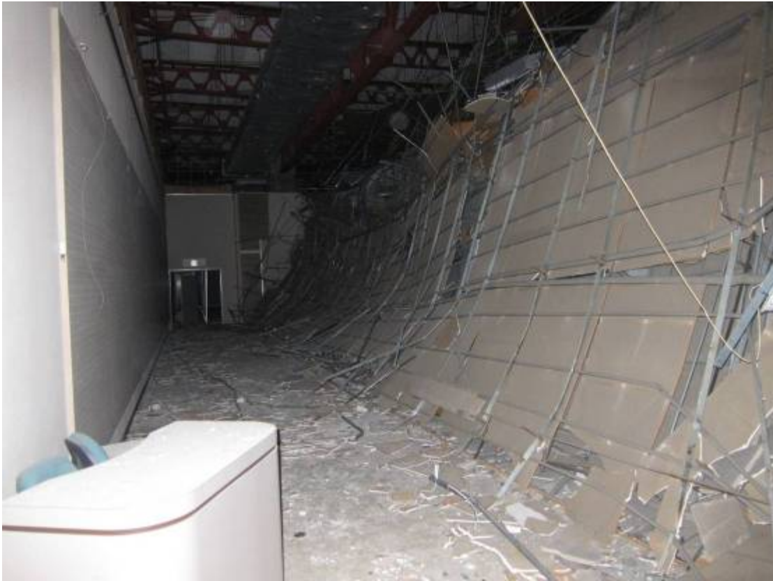
写真 J.7 展示室の天井脱落
