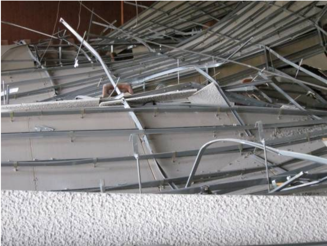
写真 I.3 天井脱落状況（3階議場）
