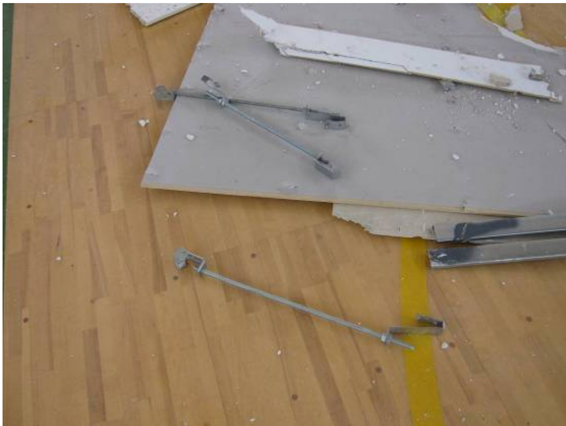
写真E.6 被害により床面に落下した吊り金具、吊りボルト、ハンガー
