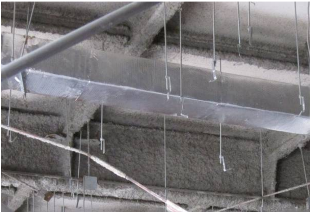
写真 I.2 天井脱落被害状況 (ハンガーの開きが多数確認される)
