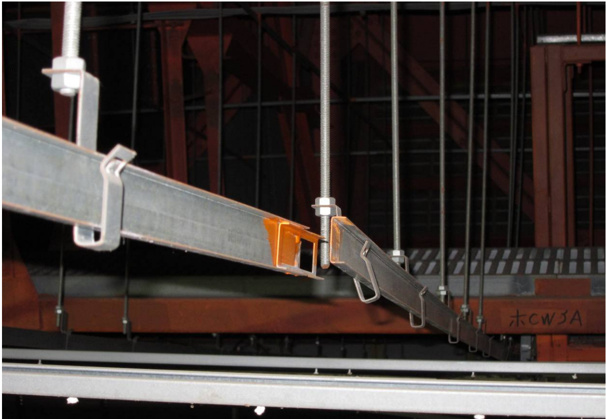
写真 B.8 天井脱落箇所のハンガーと野縁受けの接合箇所の状況 (ハンガーが軒並み外れており、溶接接合された野縁受け同士の接合箇所が損傷している)
