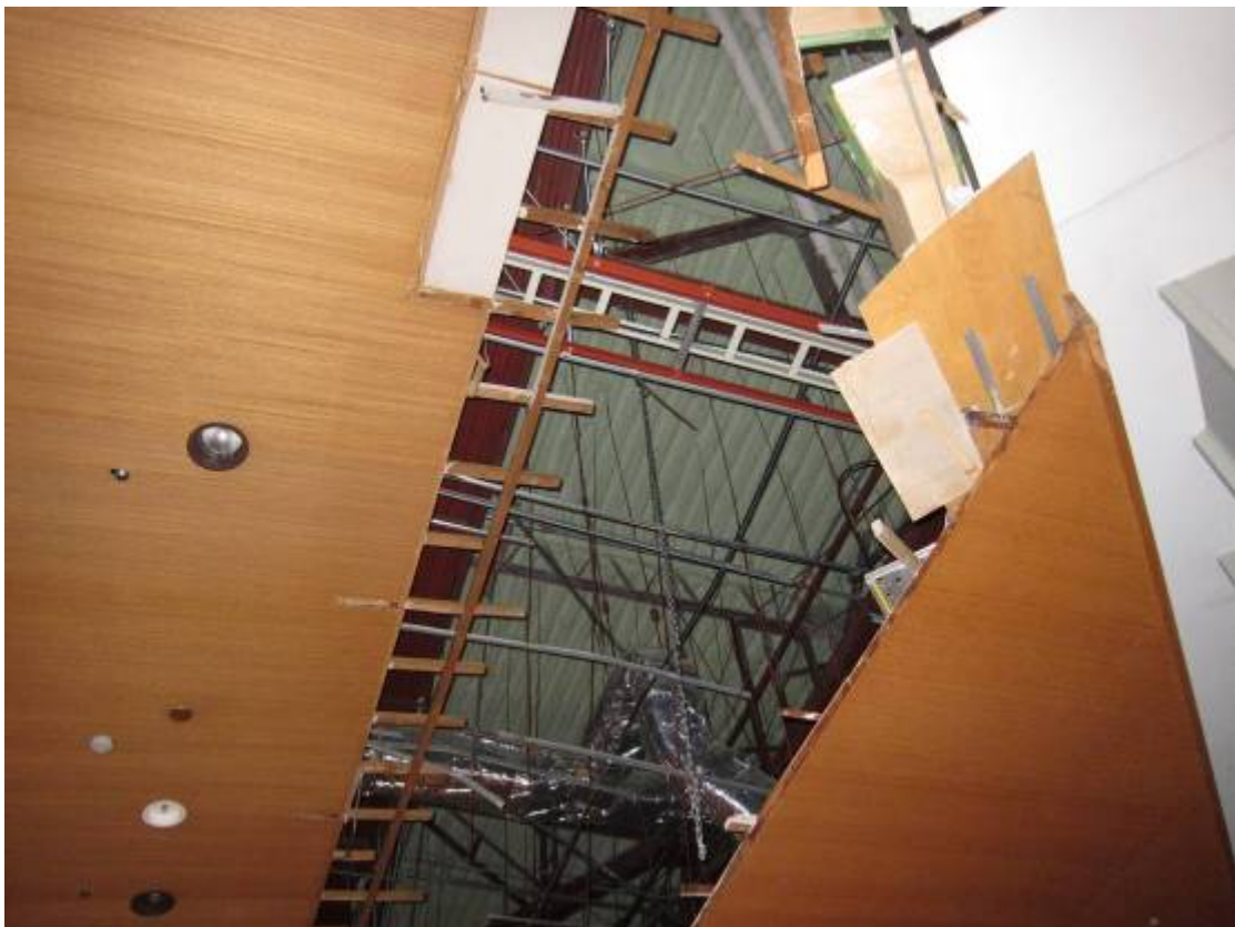
写真 J.2 上記の落下部分を見上げた様子
