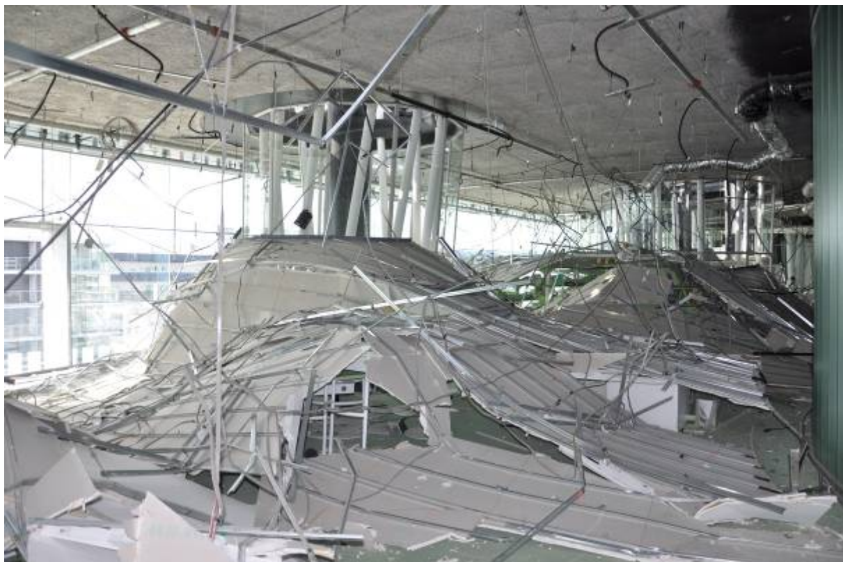
写真 G.1 天井脱落の状況（施設提供写真）
