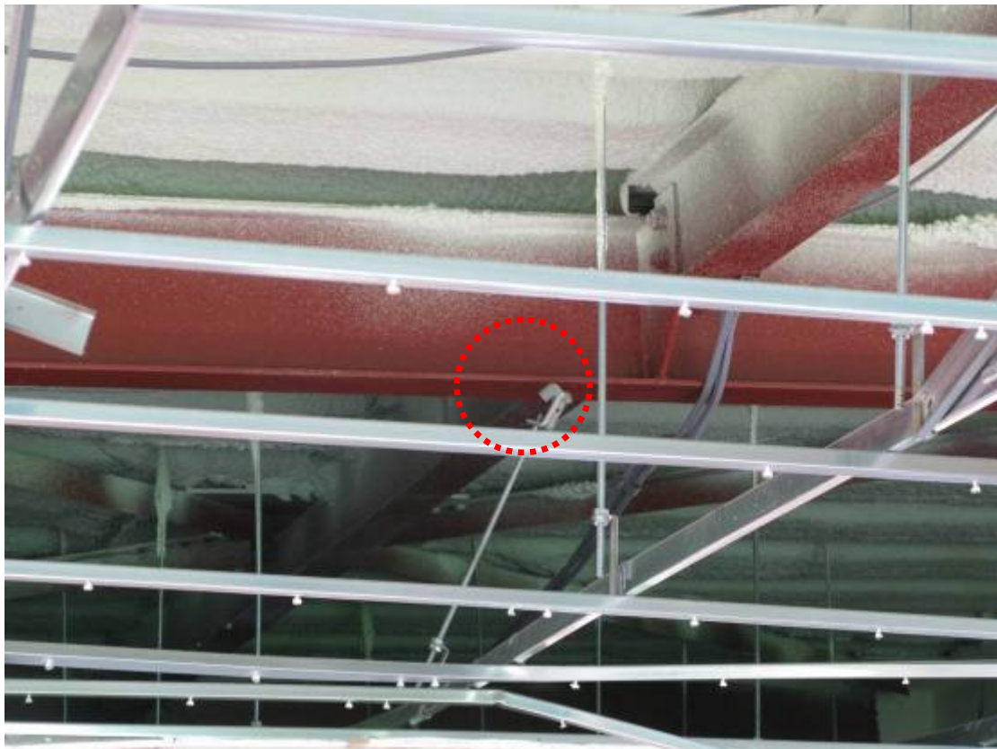
写真E.5 H形鋼梁への吊り金具が外れた被害
