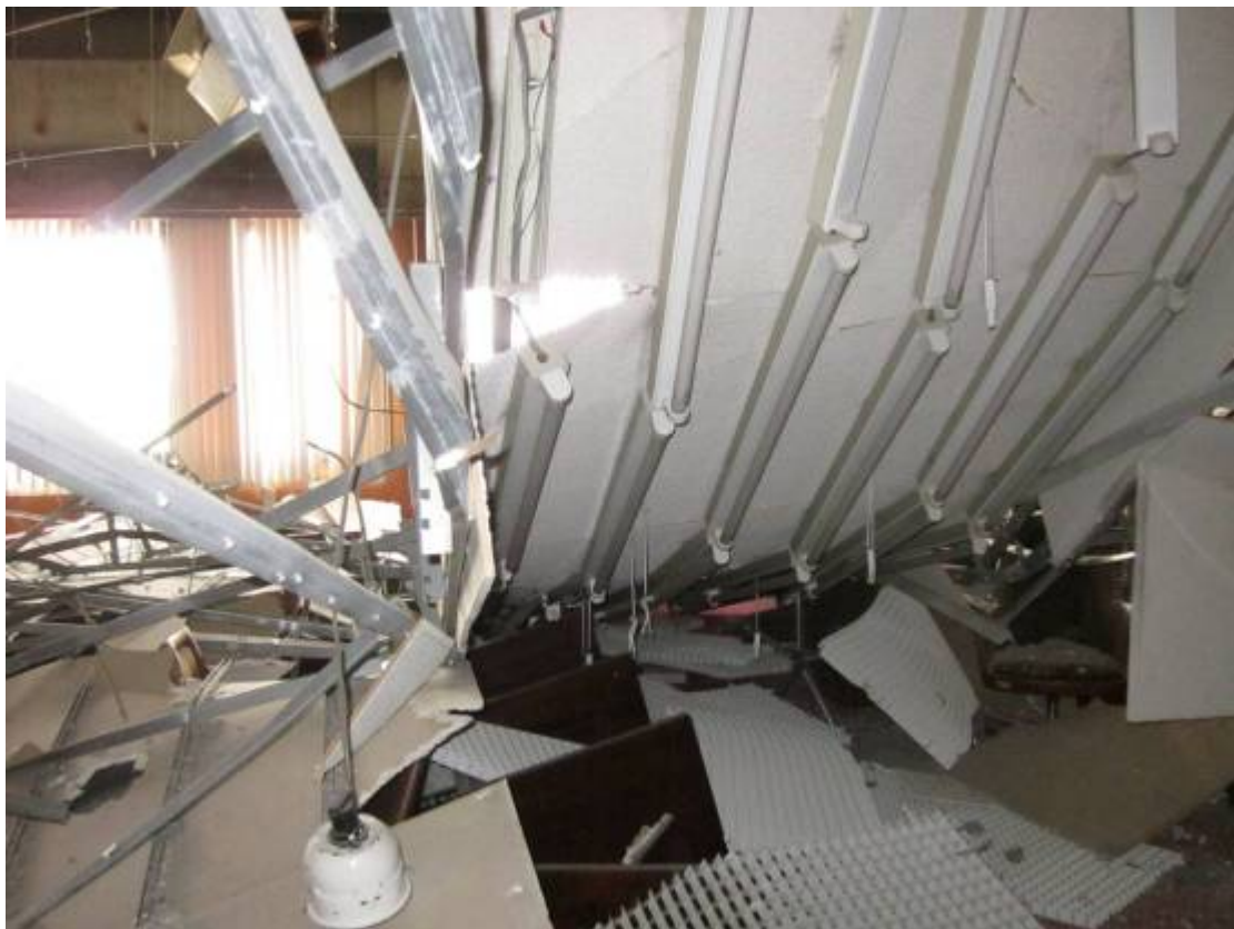
写真 I.4 落下した天井の下面の状況
