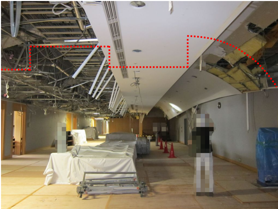
写真 H.3 6階の通路部分の天井脱落 (左側が段差天井、右側が曲面天井。赤点線は天井の断面形状)
