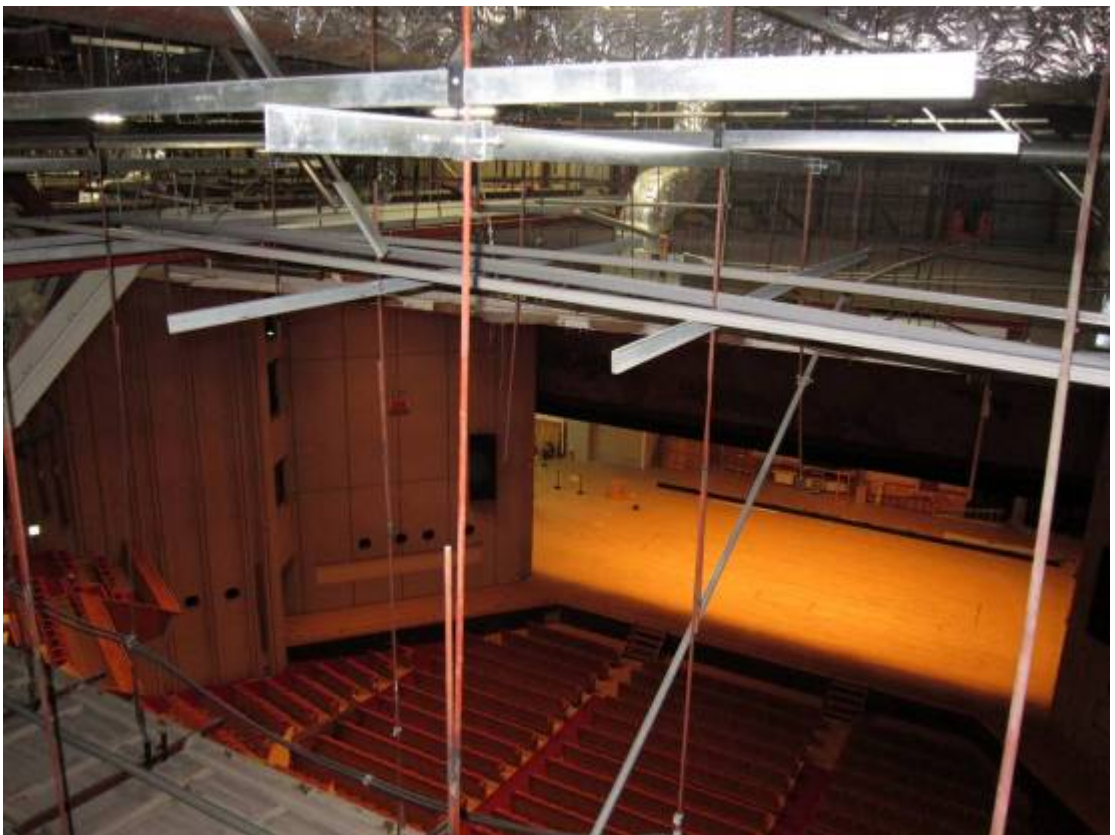
写真 J.4 天井落下箇所の天井裏からの様子
