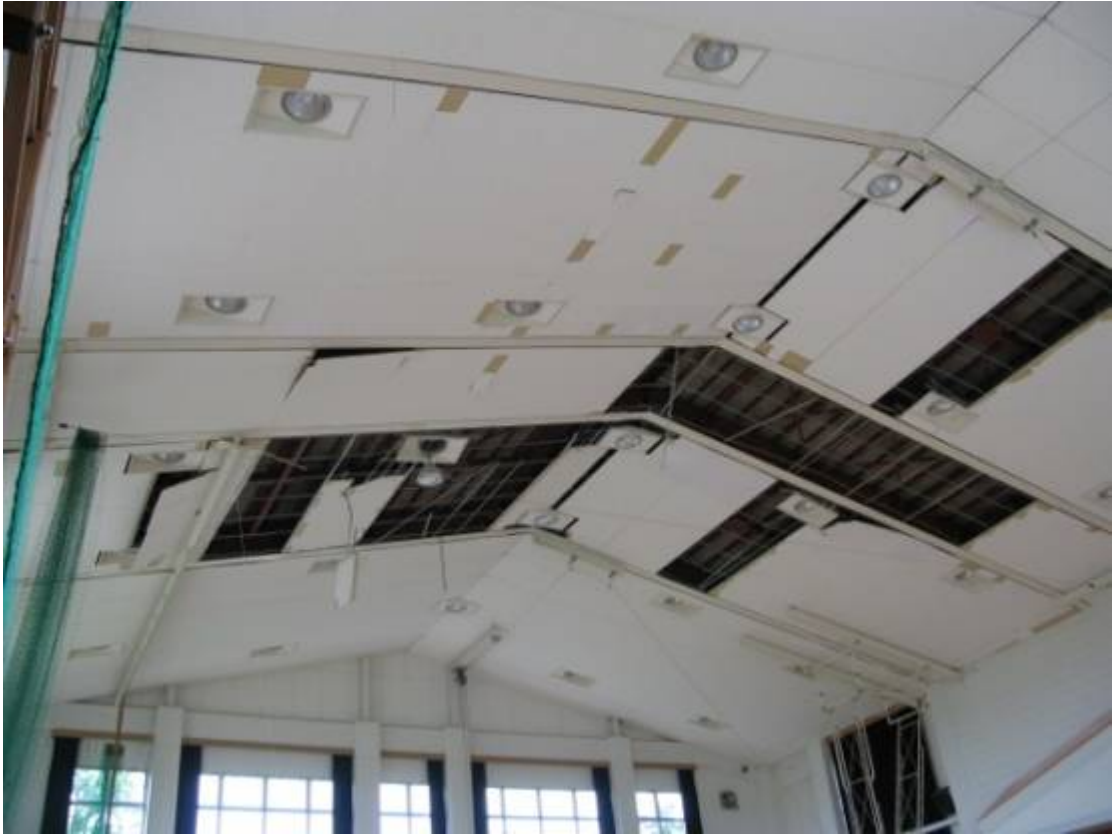
写真 F.1 天井被害の状況
