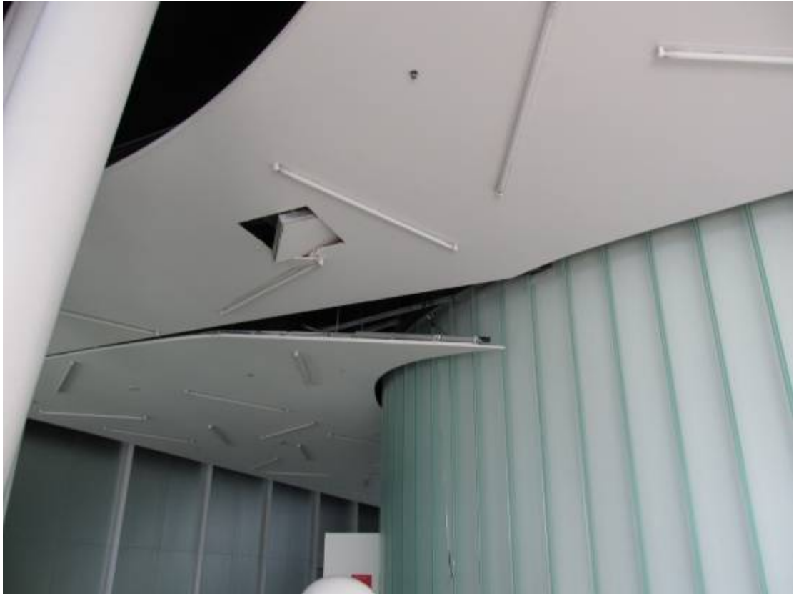
写真 G.3 天井被害の状況（施設提供写真）
