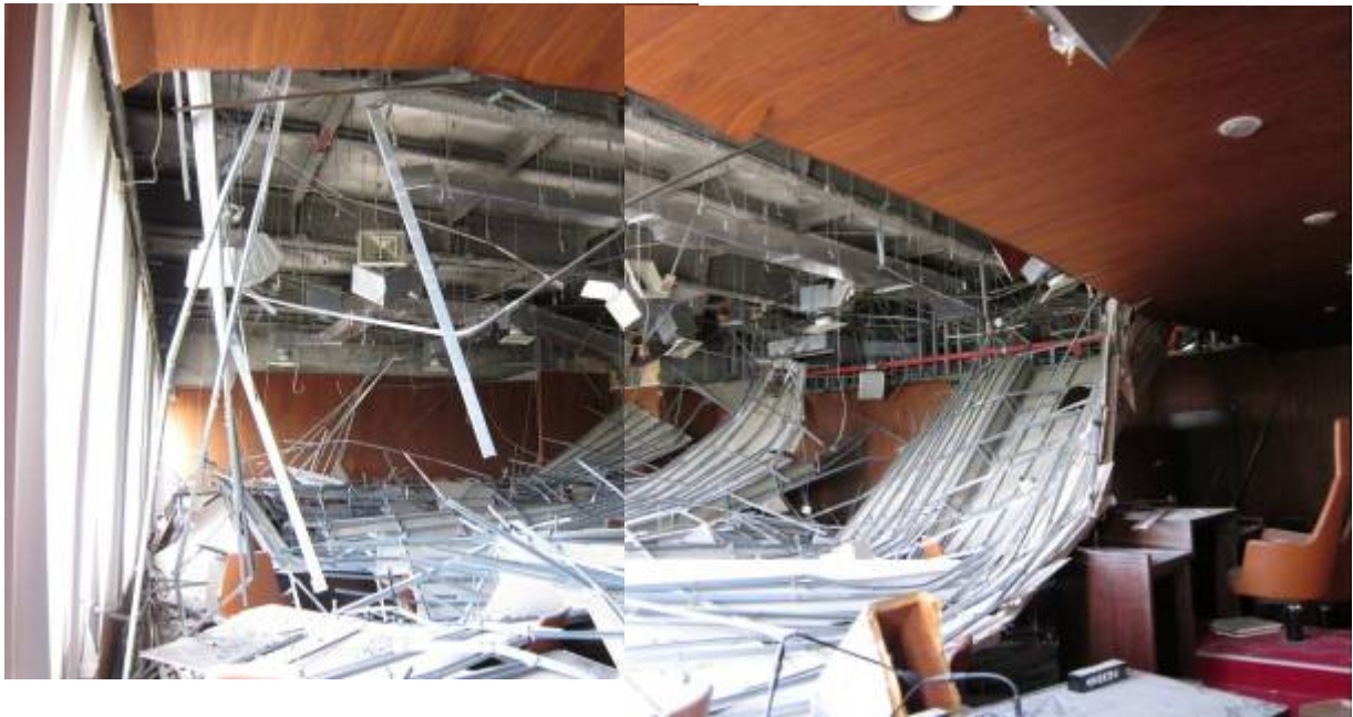
写真 I.1 天井脱落被害（3階議場）
