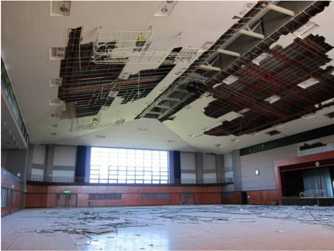
写真 B.1 脱落した天井
