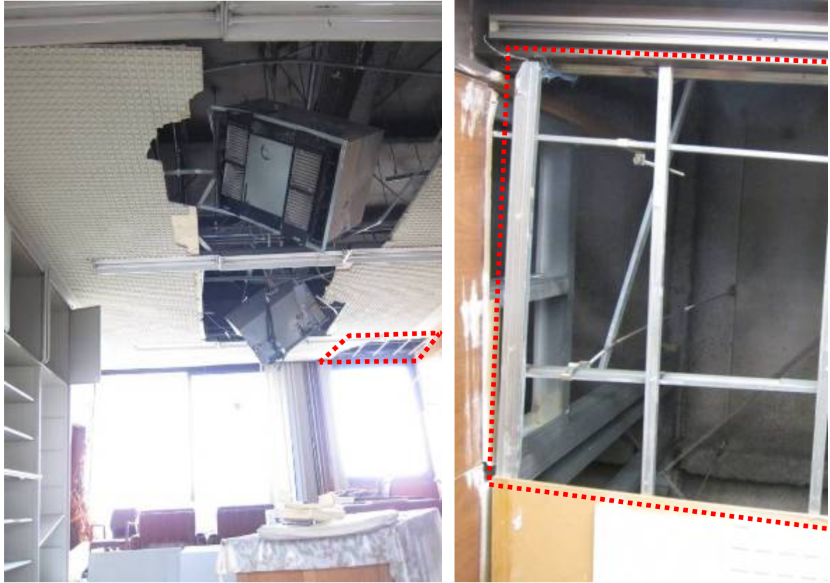
写真 I.5 3階議場隣室の被害状況
