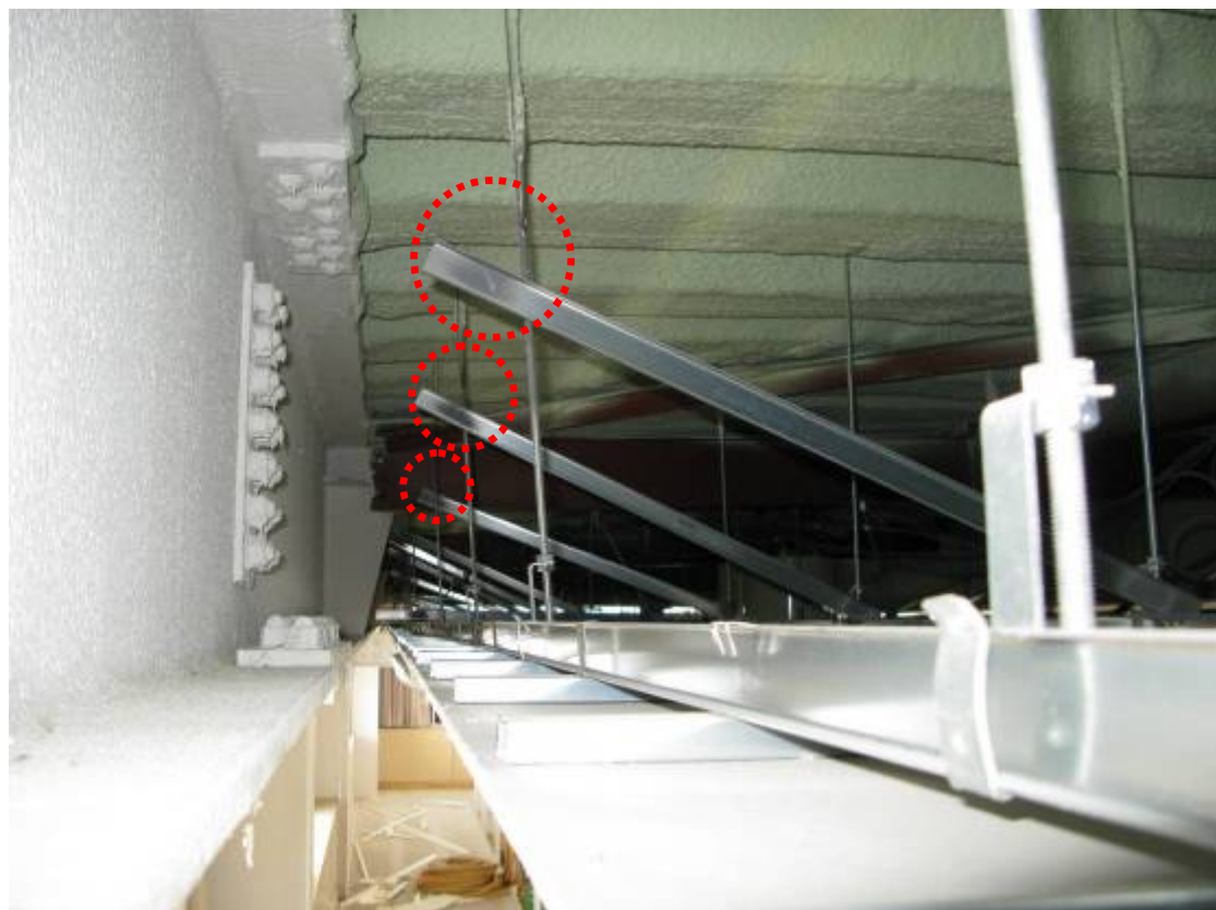
写真 E.4 斜め部材の溶接が外れた被害
