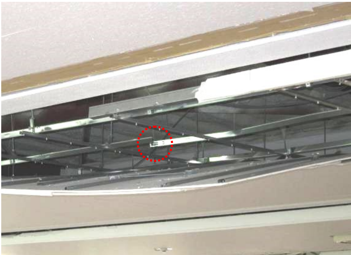
写真 E.10 天井面の端部での垂れ下がり (赤点線円内で野縁受け継手(金物接合)の外れ)
