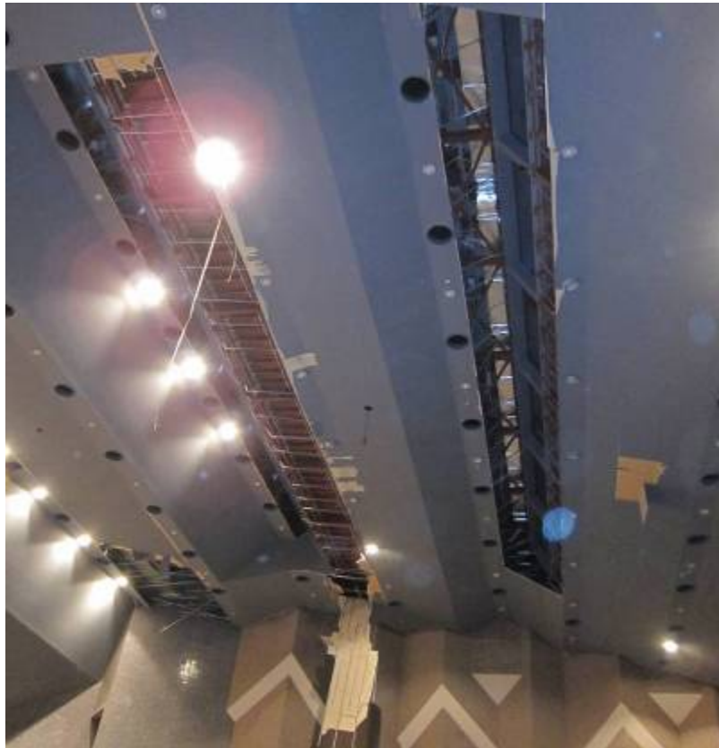
写真C.1 ホール上部の天井脱落
