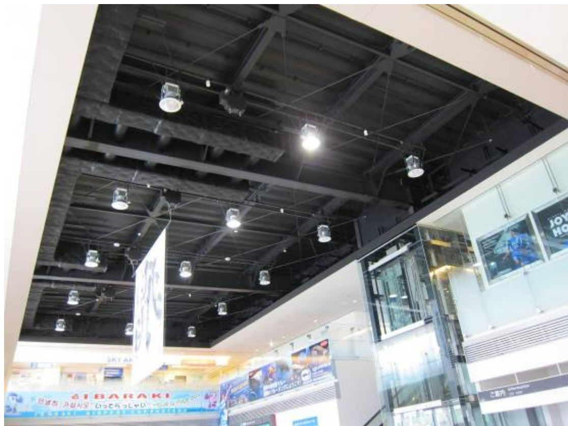
写真 A.2 被災後に天井面を張らなくした状況（平成 23 年 6 月 28 日撮影）
