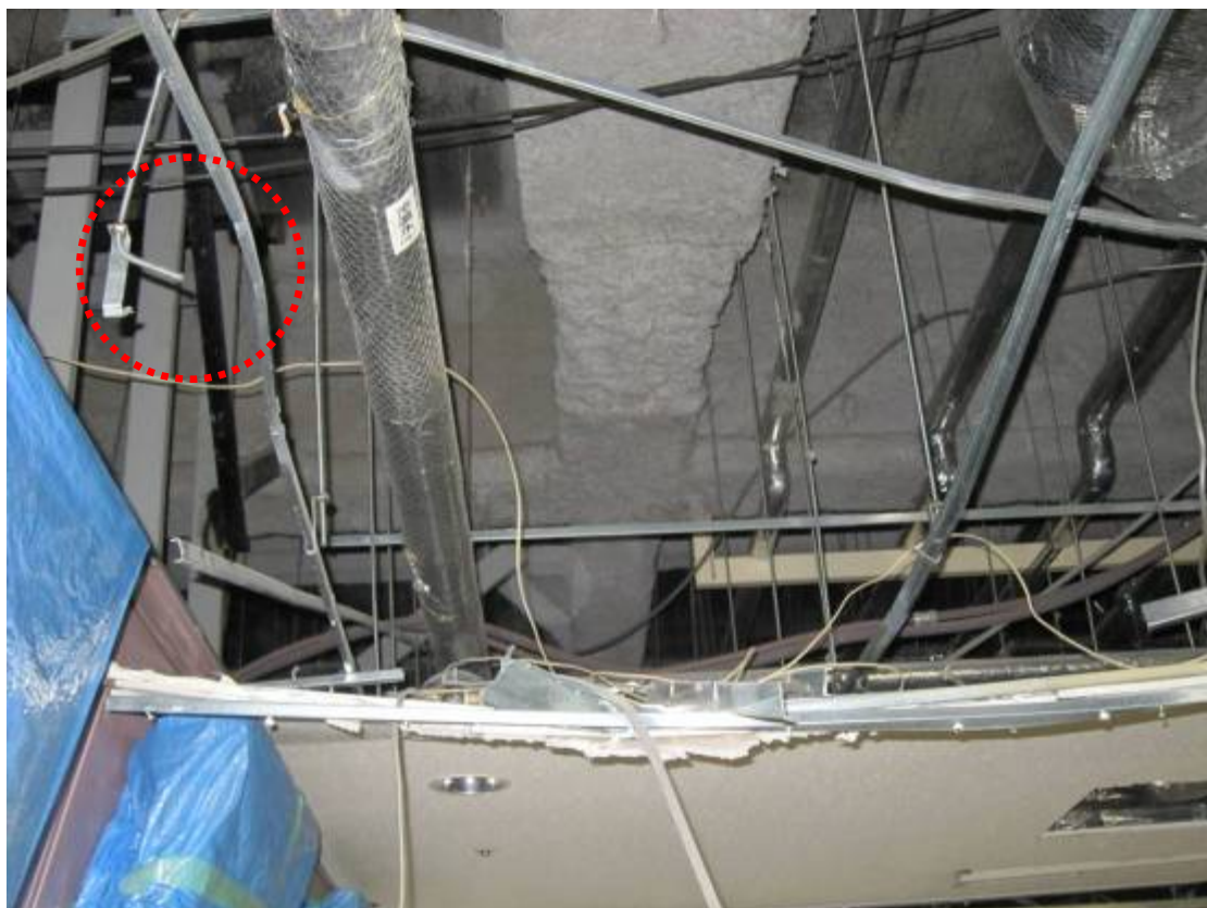
写真 H.2 上記被害箇所の詳細
