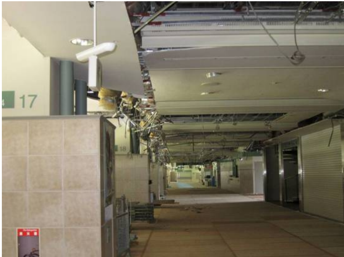
写真 H.7 5階通路での天井脱落被害
