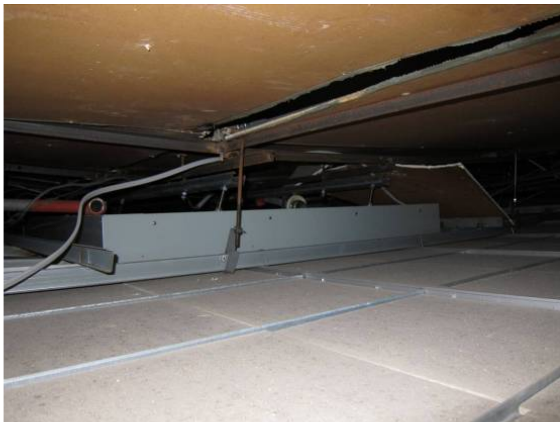
写真 J.10 展示室の上の天井と下の天井の間の様子 (脱落した天井を撮影)
