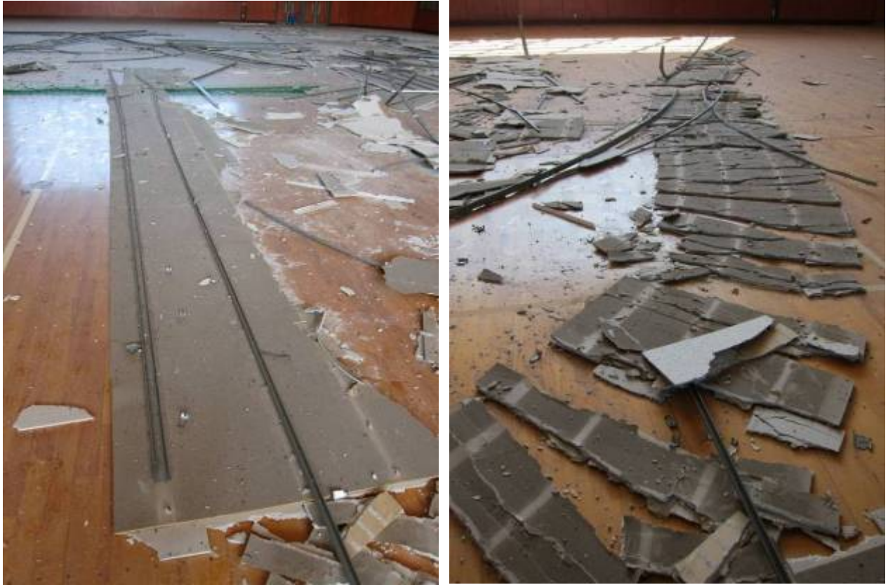
写真B.10 床面に落下した天井
