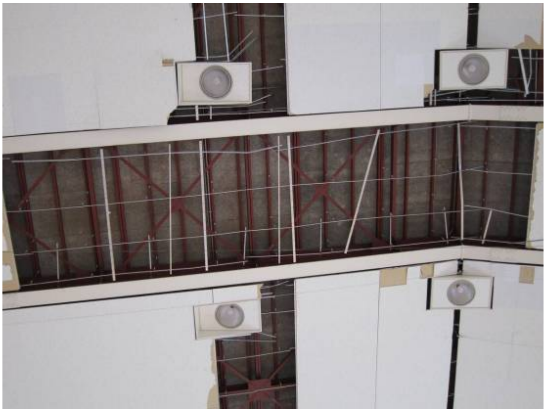
写真 F.4 天井被害状況
