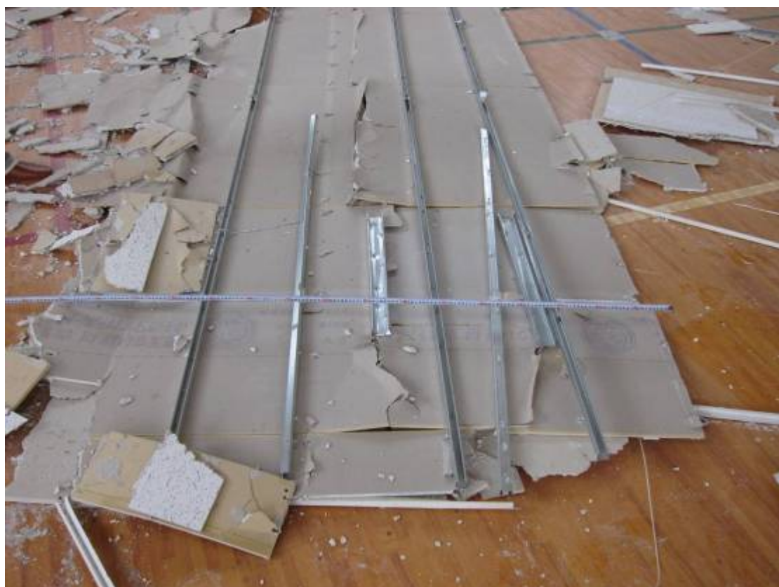
写真 F.6 落下した部材
