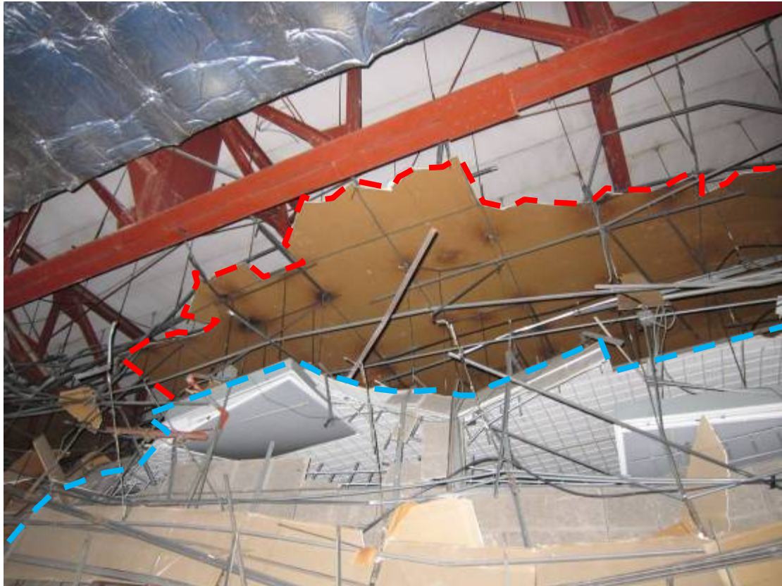
写真 J.9 展示室の天井の詳細写真 (青破線が下の天井の破断面、赤破線が上の天井の破断面)
