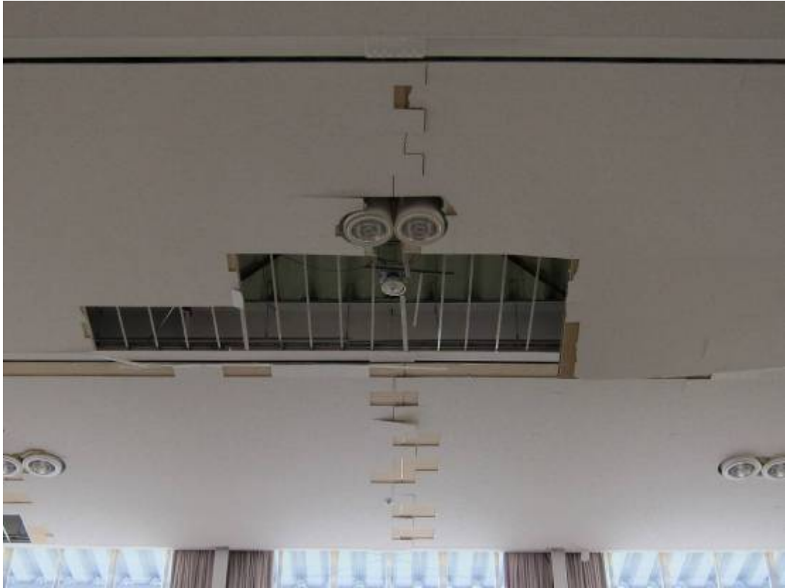
写真 E.9 天井板が野縁から外れて落下
