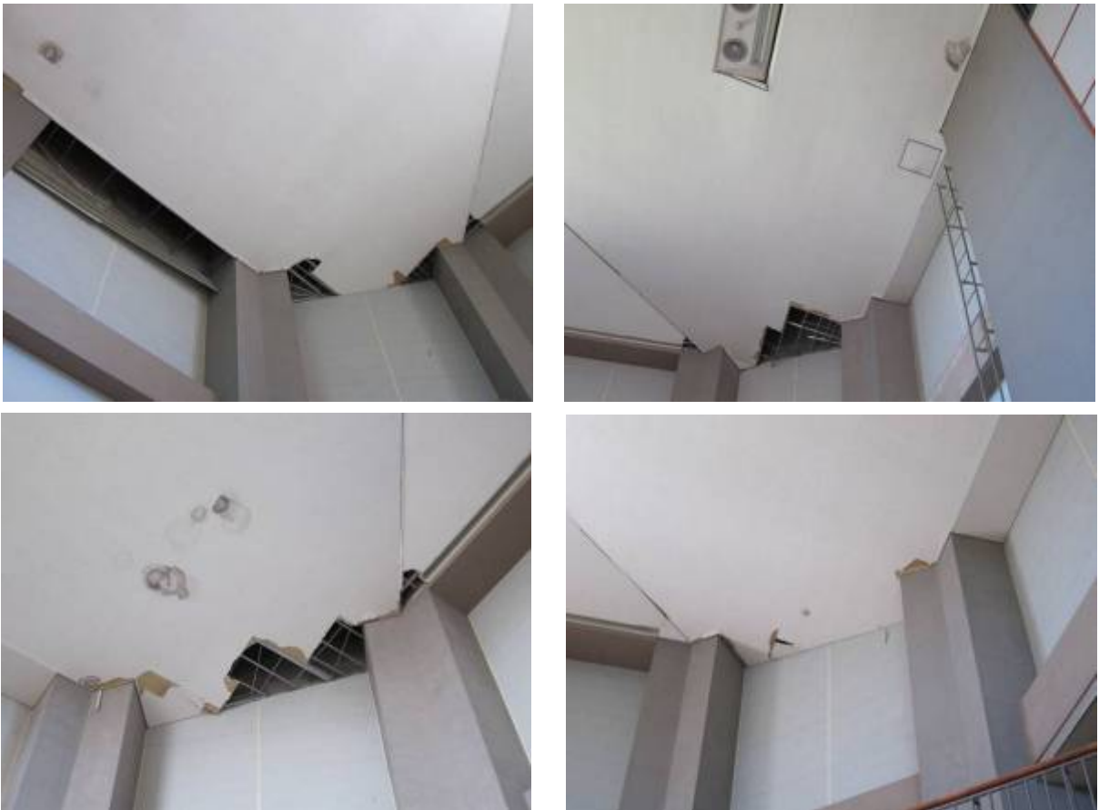
写真 B.2 隅部での天井の損傷
