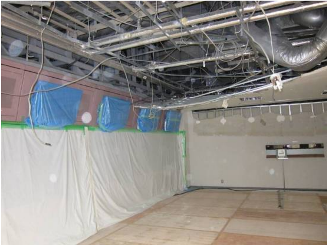
写真 H.1 6階における天井脱落
