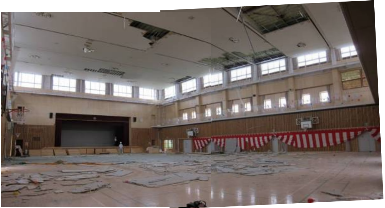
写真 E.1 天井脱落被害の状況（北側を見る）
