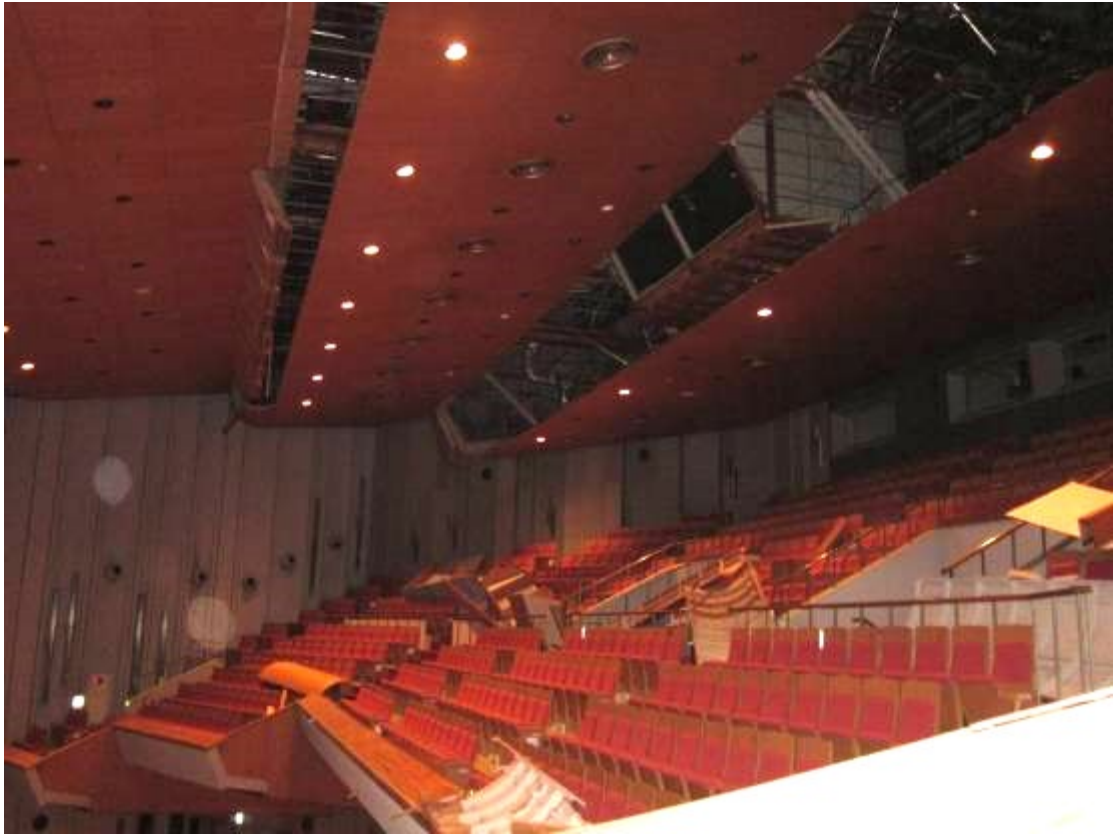
写真 J.1 ホールの天井脱落被害の状況
