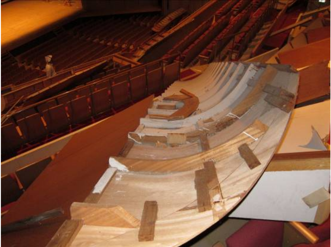
写真 J.3 上記被害箇所からの落下物
