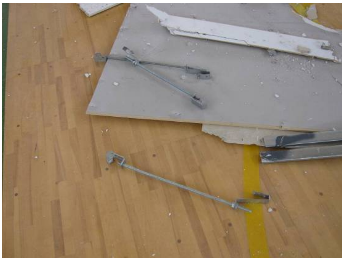
写真E.6 被害により床面に落下した吊り金具、吊りボルト、ハンガー
