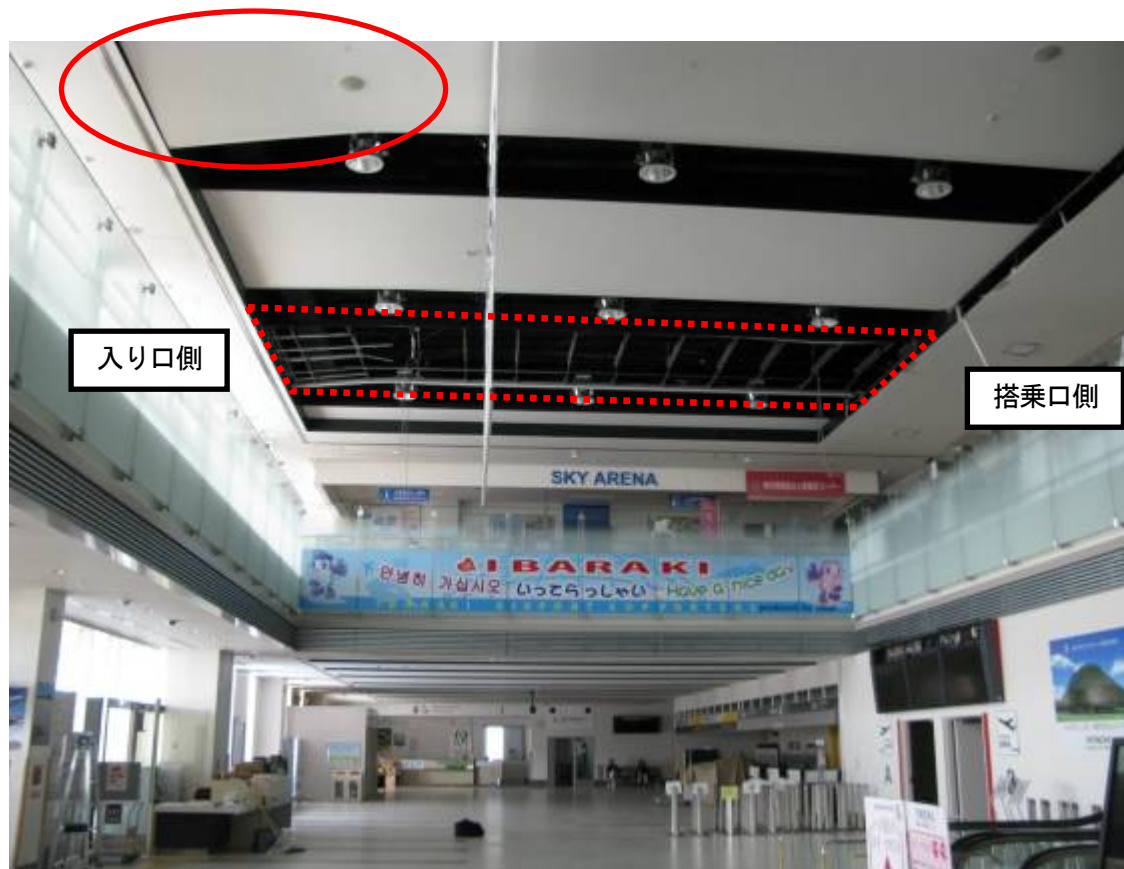
写真 A.1 天井が脱落した後の状況（平成 23 年 3 月 12 日撮影） 赤点線台形内が天井脱落箇所、赤楕円内が天井面が垂れた箇所
