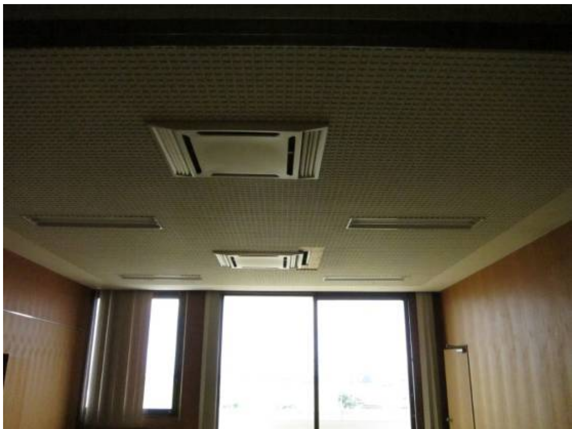
写真 I.6 3階議場の2つ隣の室の状況
