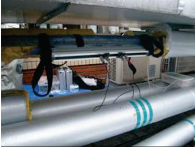
図Ⅲ. 2. 2. 3 超音波流量計による冷温水配管流量測定状況（断熱材復旧前）
