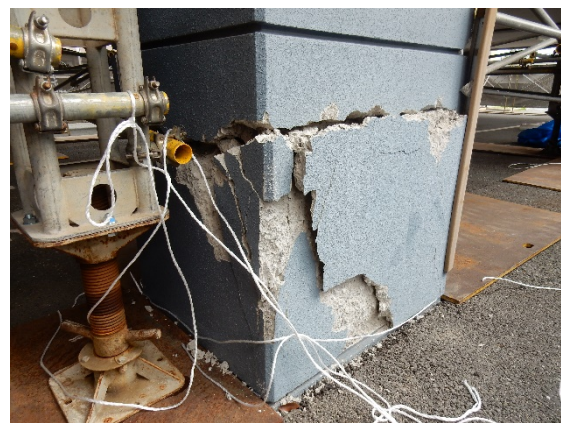
写真5.5-10 1階柱の水平ひび割れ
