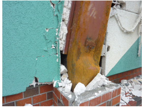
写真 5.4-12 柱の局部座屈
