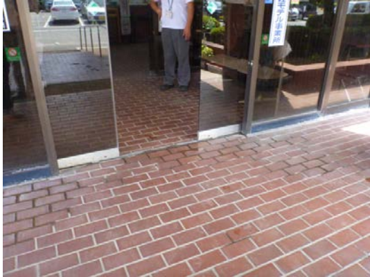
写真5.5-277 自動ドアレールの変形
