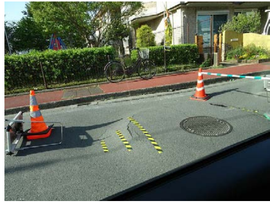
写真5. 5-295 周辺道路の地盤沈下
