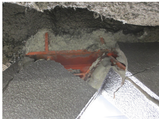
写真 5.4-198 ブレース交差部の耐火被覆の剥離
