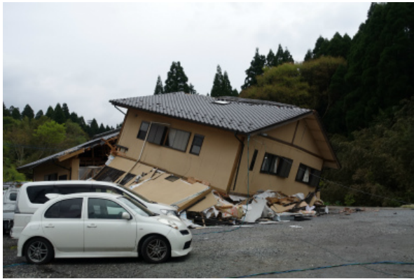
写真 5.3-64 倒壊した木造住宅
