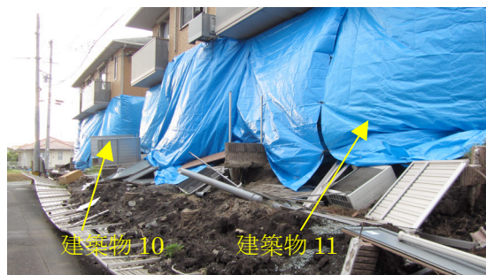
写真 5.4-24 宅地擁壁部分の崩壊
