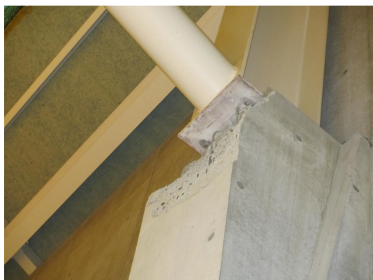
写真 5.4-57 支承部のコンクリートの側方破壊
