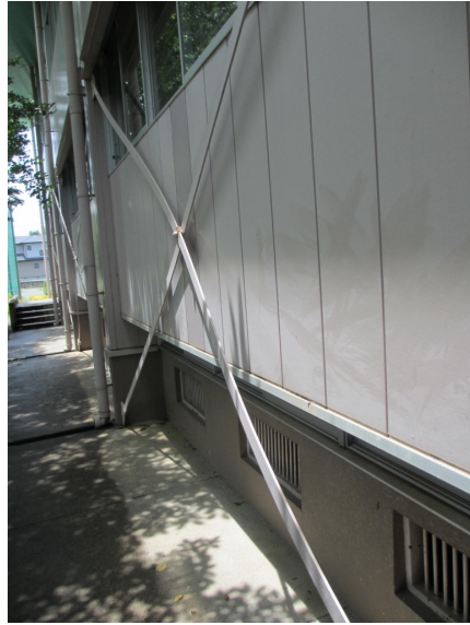
写真 5.4-86 平鋼ブレースのたわみ
