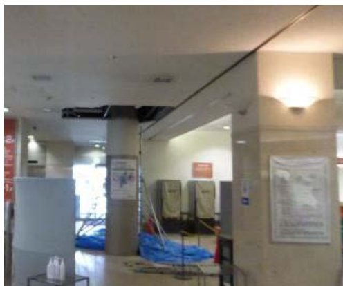
写真 5.8.2-23 天井仕上げ材の脱落 (南側病棟)
