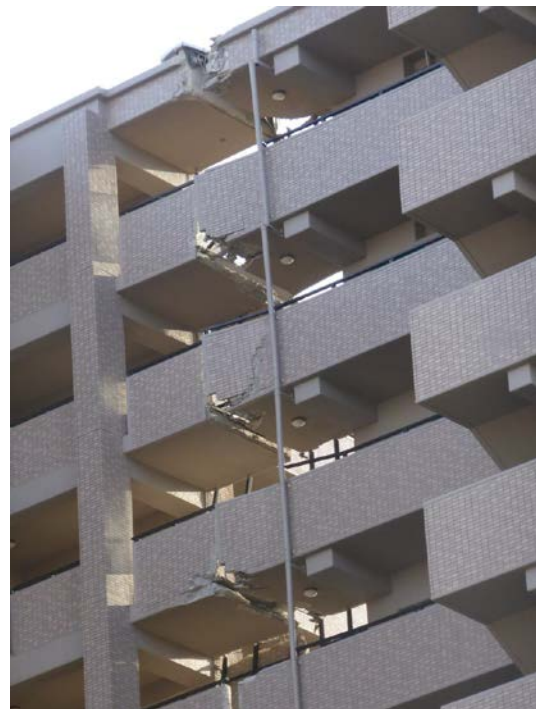
写真5.5-102 エキスパンションジョイント部の破壊
