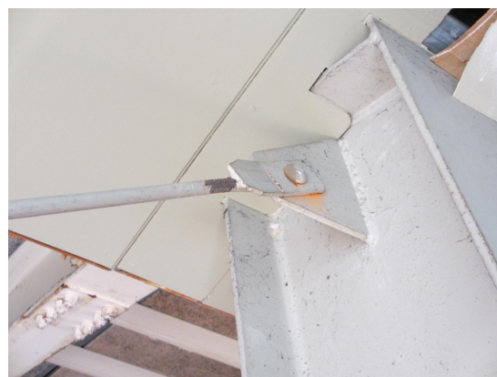
写真 5. 4-46 ガセットプレートの曲がり
