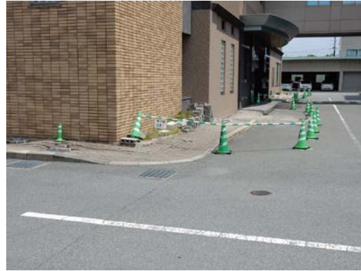
写真5.5-142 建築物周辺の地盤変状
