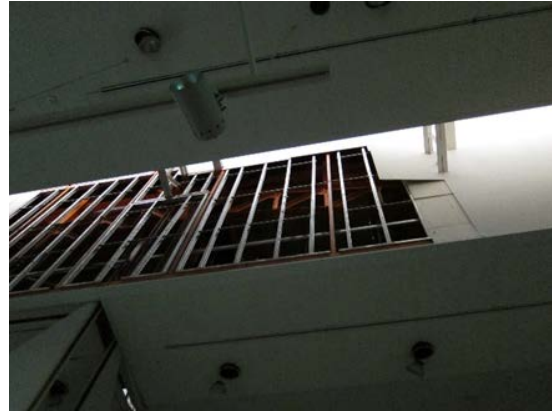
写真 5.8.2-40 吹き抜け部の立ち上がり壁の仕上げ材の脱落
