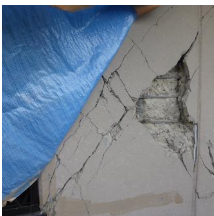
写真5.5-31 共用廊下側柱のせん断破壊
