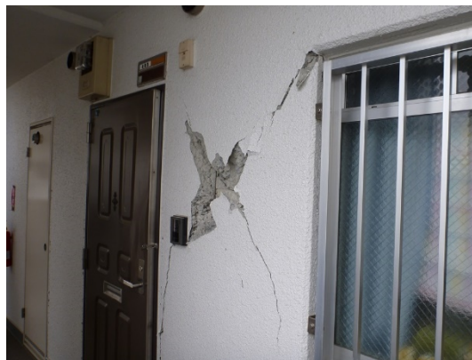
写真5.5-65 桁行方向の共用廊下側の構面における方立壁の被害
