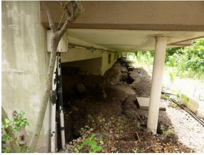
写真5.5-92 建築部外周部の地盤の亀裂
