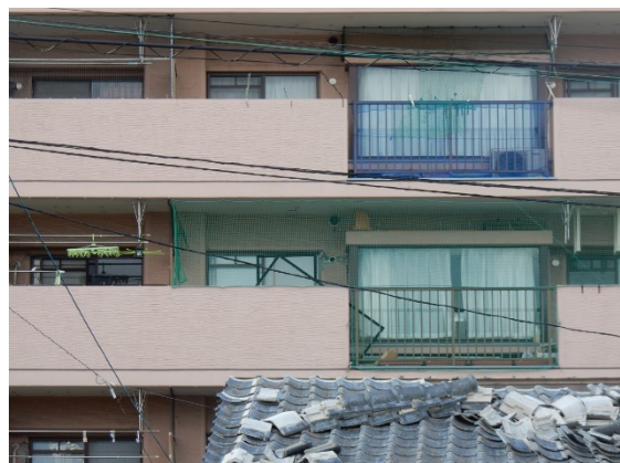
写真5.5-100 バルコニー側の方立壁の損傷
