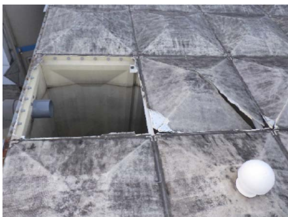
(a) 空港旅客ターミナルにおける被害
