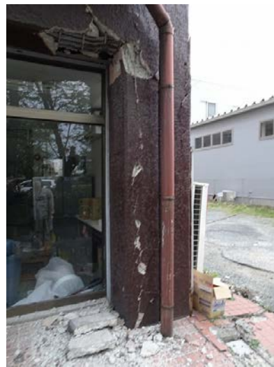
写真5.5-257 1 階柱 (北東側) の主筋付着割裂ひび割れと 2 階梁端部の破壊
