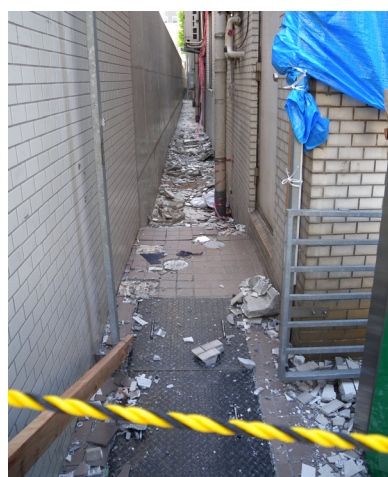
写真 5.7.2-16 隣接建物（右側）の外装材落下被害
