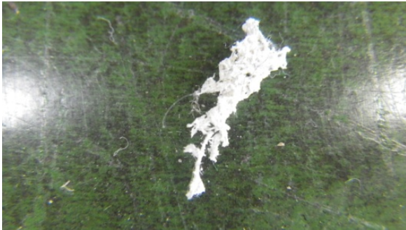
写真 5. 8. 2-83 2階ギャラリー床面落下物
