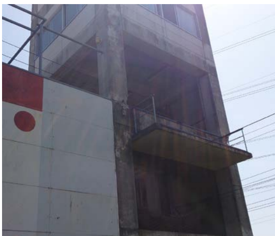
写真5.5-20 前震後の主訓練塔の被災状況
