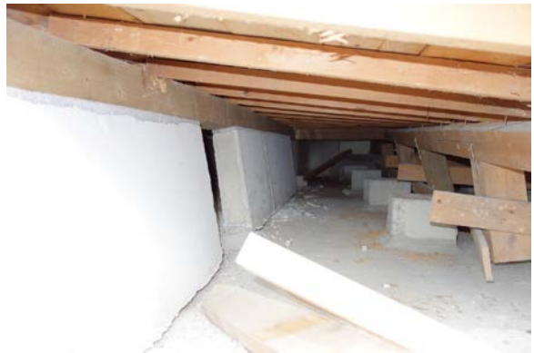
写真 5.6-33 写真 5.6-32 の建築物の基礎。床束は全て外れ、基礎は立ち上がり部で曲げ破壊が生じている。
