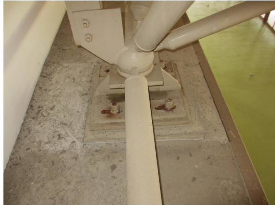
写真 5.4-187 体育館Nの桁行き構面の屋根支承部（長孔の端までボルトが移動）
