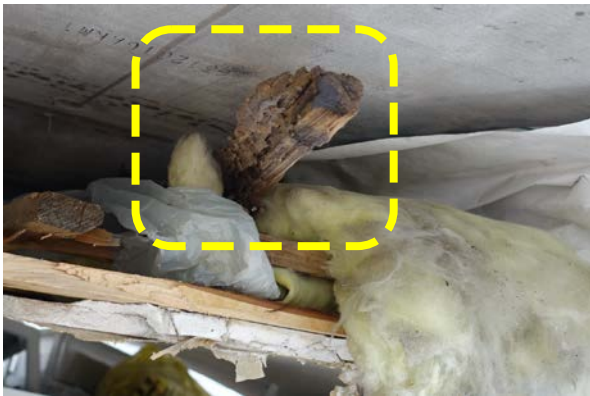
写真 5.3-48 アパート A の筋かい端部 (蟻害による著しい断面欠損)
