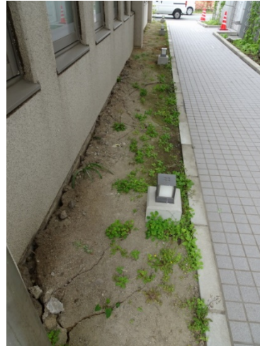
写真5.5-125 建築物に接する地盤のひび割れ
