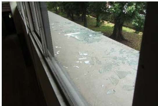
写真 5.8.2-30 剣道場ガラス破損
