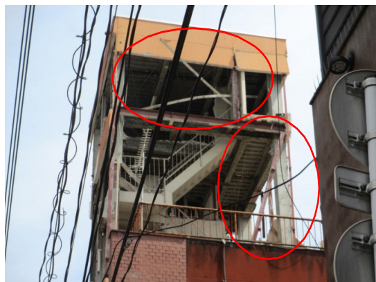
写真 5. 4-200 塔屋のブレースの破断
