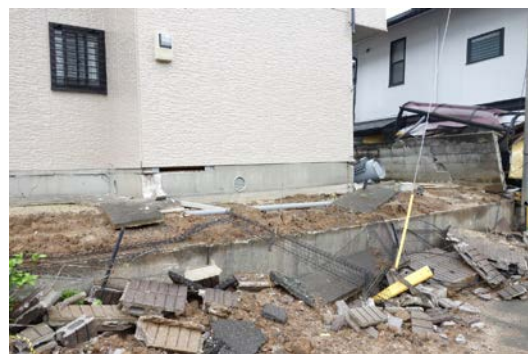
写真 5.6-41 写真 5.6-40 の建築物の基礎。ひび割れが認められるが、破壊はしていない。地盤変状は認められる。
