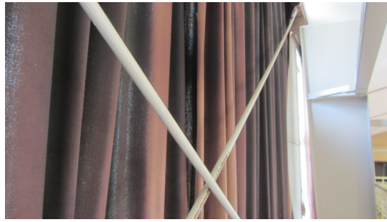
写真 5.4-112 2階鉛直ブレース (交点での擦れ)
