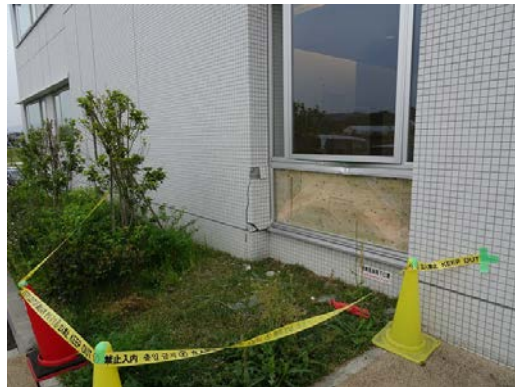
写真5.5-110 耐力壁脚部の損傷
