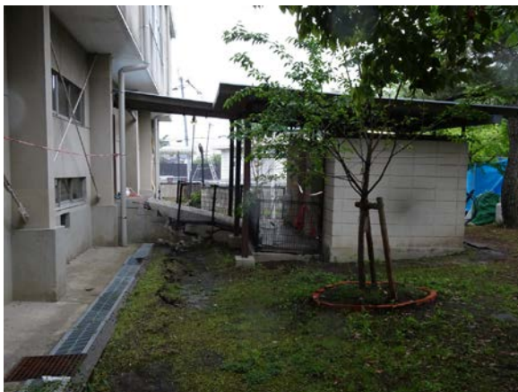
写真 5.6-59 写真 5.6-58 の小学校の体育館の周辺地盤の沈下状況
