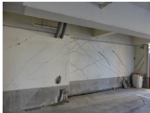
写真5.5-49 桁行方向構面外の非構造壁 のせん断ひび割れ
