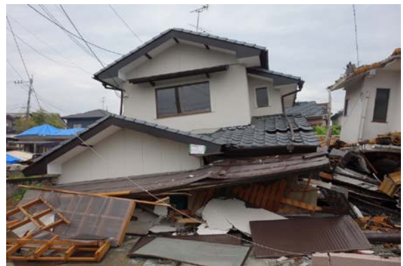
写真 5.6-26 倒壊した建築物
