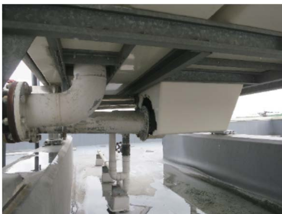
(a) 破断箇所の様子
