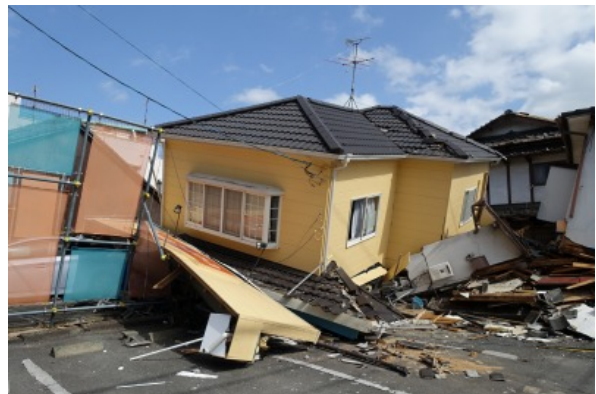
写真 5.3-11 倒壊した木造住宅
