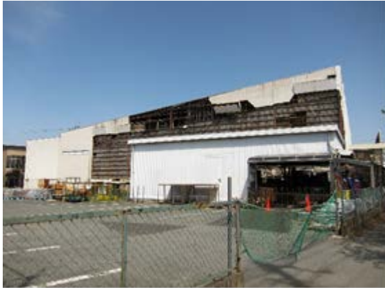
写真 5.8.2-50 湿式工法による壁の脱落
