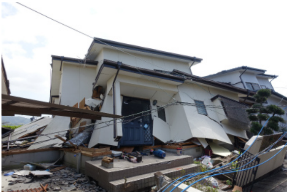
写真 5.3-8 倒壊した木造住宅
