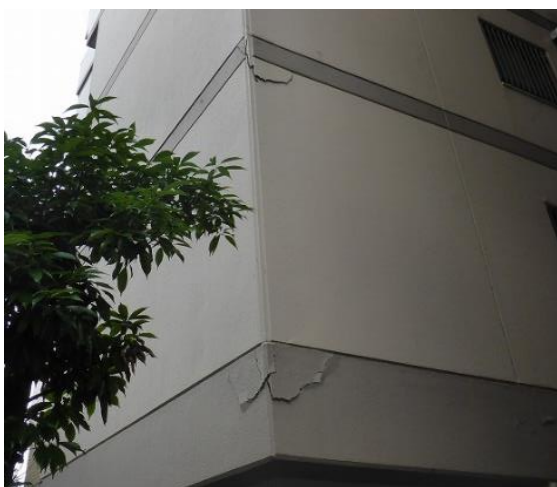
写真5.5-56 出部屋を支持する片持ち梁先 端周辺のひび割れ
