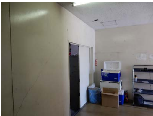
写真5.5-280 耐力壁のせん断ひび割れ
