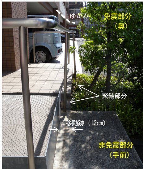
写真 5.7.2-56 エキスパンション部の変状（手すりの変形、移動跡）
