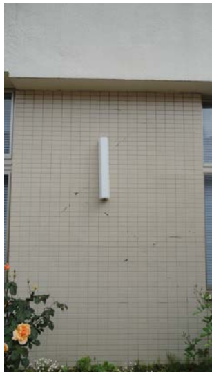
写真5.5-153 非構造壁のひび割れ
