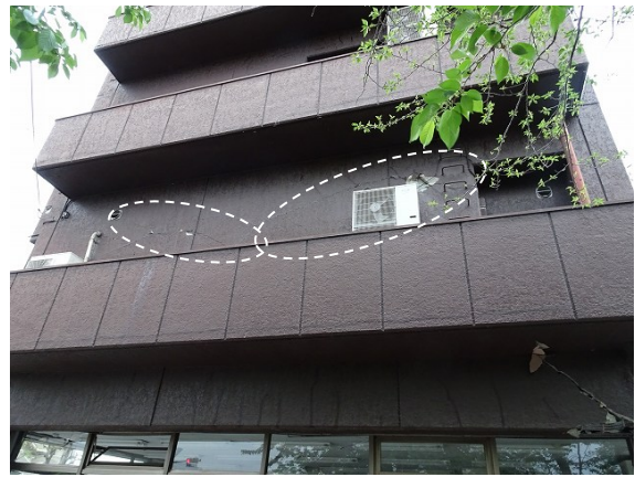
写真5.5-255 耐力壁のせん断ひび割れ (東側)
