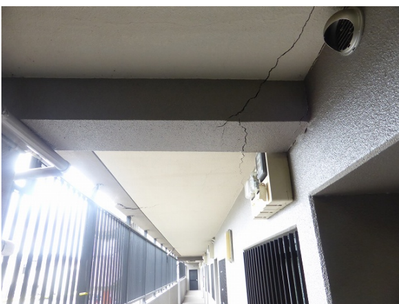
写真5.5-82 1階エントランスホールと住棟本体をつなぐ小梁およびその周辺スラブに生じた曲げひび割れ
