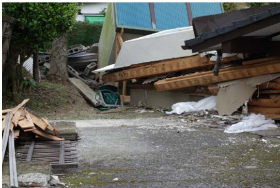
写真 5.6-3 写真 5.6-2 の基礎のひび割れを確認。地盤変状は確認できなかった。
