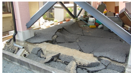
写真 5.4-38 宅地の地盤変状
