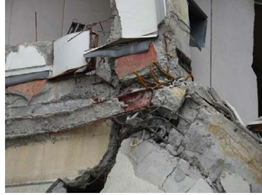
写真5.5-221 柱頭部の破壊（南面）
