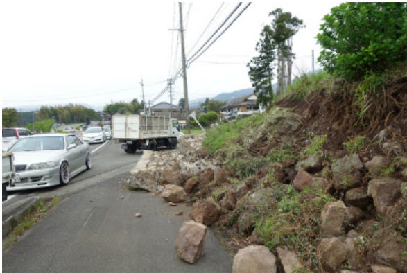
写真 5.3-30 崩壊した擁壁
