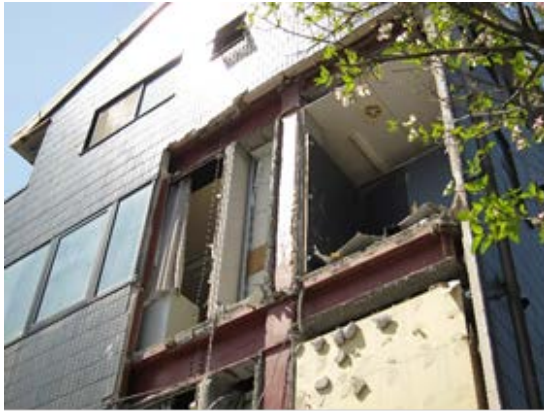
写真 5. 8. 2-54 乾式工法による外壁の脱落
