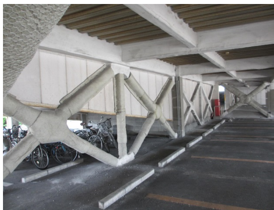
写真 5.4-189 建築物内のブレースの様子
