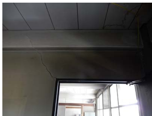
写真5.5-272 開口隅角部におけるひび割れ
