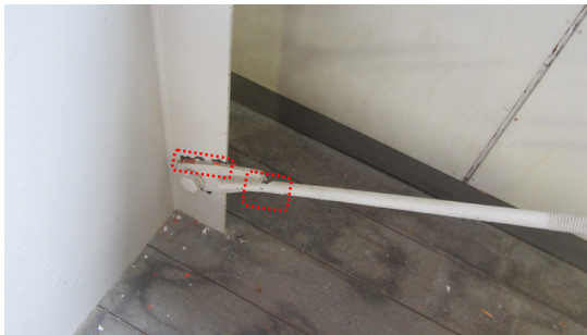
写真 5.4-113 2階鉛直ブレース下端接合部 塗料の剥げ、ブレースの若干の変形
