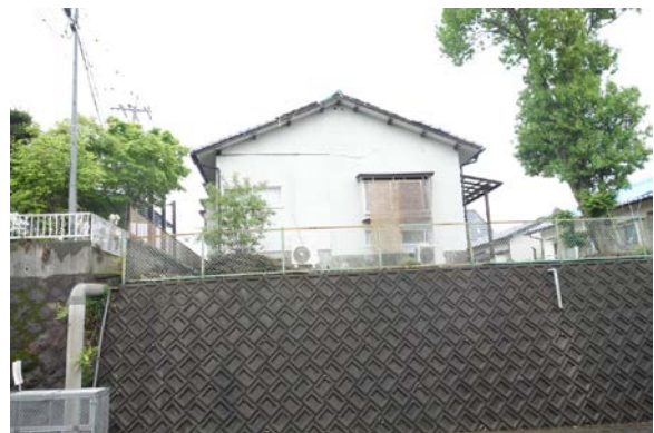
写真 5.6-22 軽微・無被害に見える建築物。 擁壁にも損傷が見当たらない。
