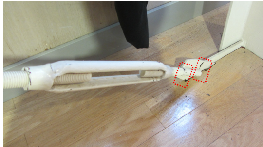
写真 5.4-76 鉛直ブレース（2階）の軸部及び羽子板の変形
