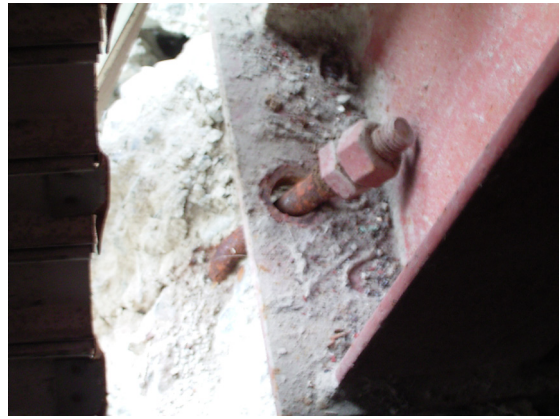
写真 5.4-17 柱脚部の損傷状況
