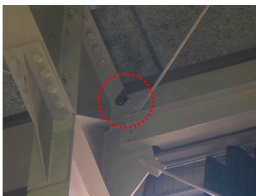
写真 5.4-135 取り替えられていない屋根面水平ブレースのボルト破断
