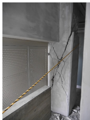
写真5.5-264 2階柱のせん断破壊
