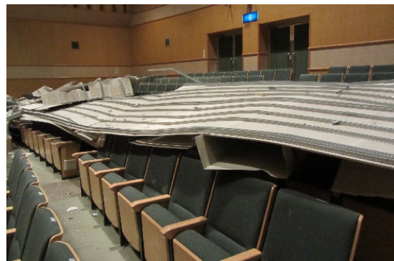
写真 5.8.2-6 脱落した天井面
