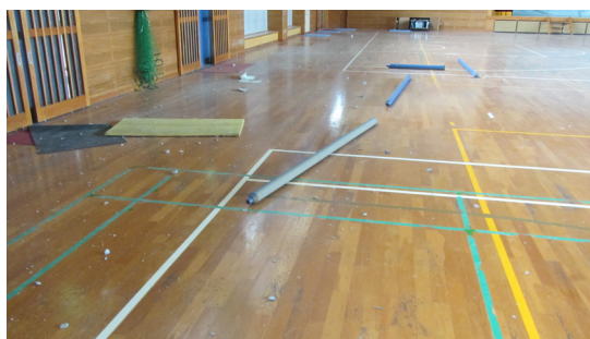
写真 5.4-142 落下した立体トラスの部材
