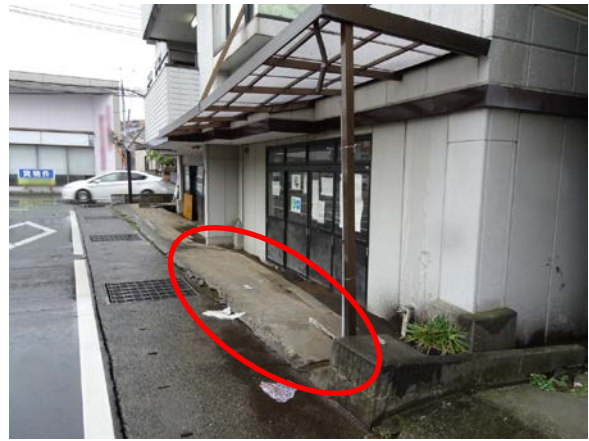
写真 5.6-61 写真 5.6-60 の建築物の 1 階部分の沈下状況
