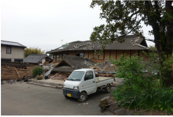
写真 5.3-44 倒壊した木造住宅
