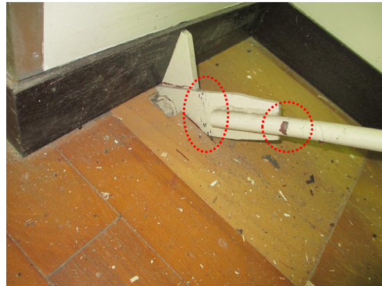
写真 5.4-96 2階ブレース端部の降伏とブレース端部羽子板のわずかな曲がりが見られた
