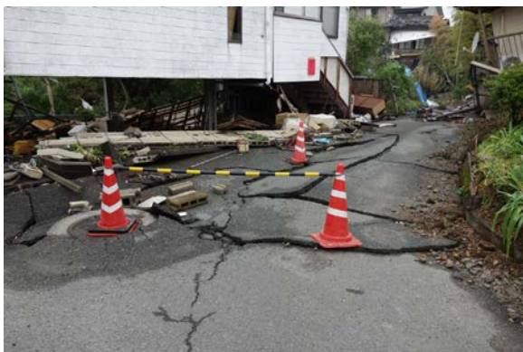
写真 5.6-21 B 通り・県道 28 号北側の道路の 舗装の様子（被害の大きい箇所）
