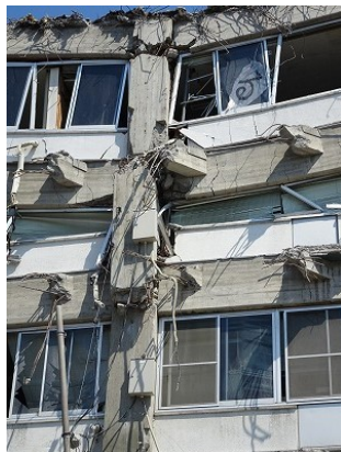
写真5.5-201 4、5階十字形柱梁接合部の損傷（南西側）
