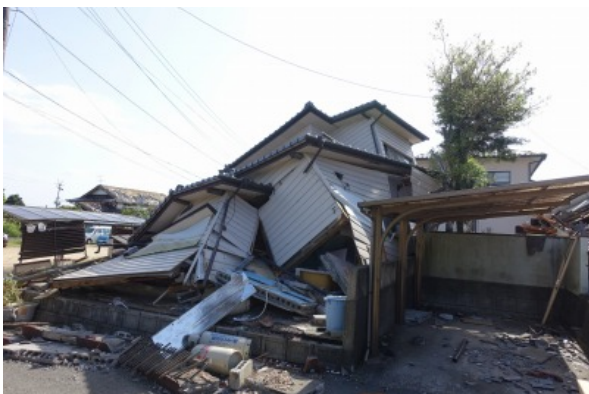
写真 5.3-12 倒壊した木造住宅
