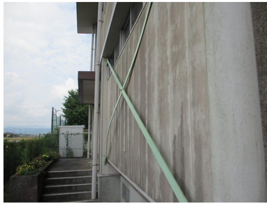
写真 5. 4-127 ブレースのわずかなたわみ
