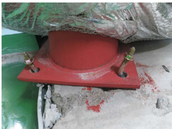
写真 5.8.3-8 屋上貯湯槽アンカー接合部の損傷
