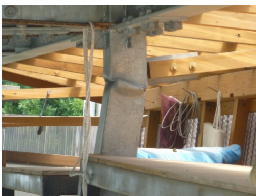
写真 5. 4-41 柱の局部座屈
