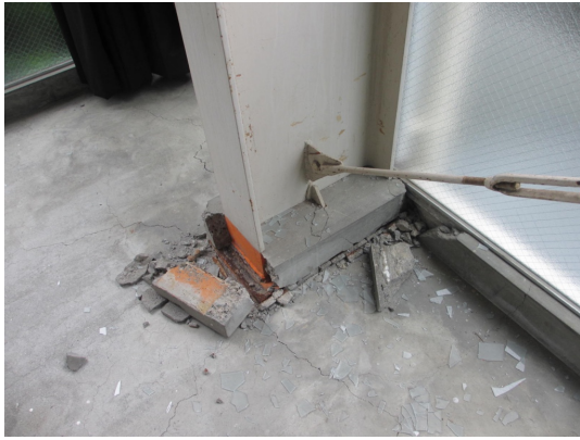
写真 5.4-82 柱脚部のコンクリート破壊
