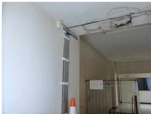
写真5.5-132 エキスパンションジョイント保護カバーの変形（内側）
