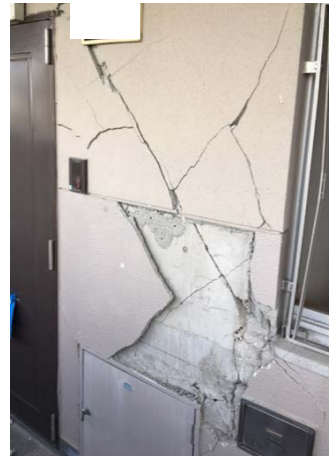
写真5.5-235 桁行き方向外廊下側玄関脇の方立て壁のせん断破壊
