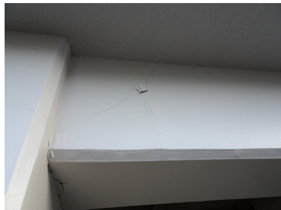
写真5.5-245 桁行方向の梁端のせん断ひび割れ
