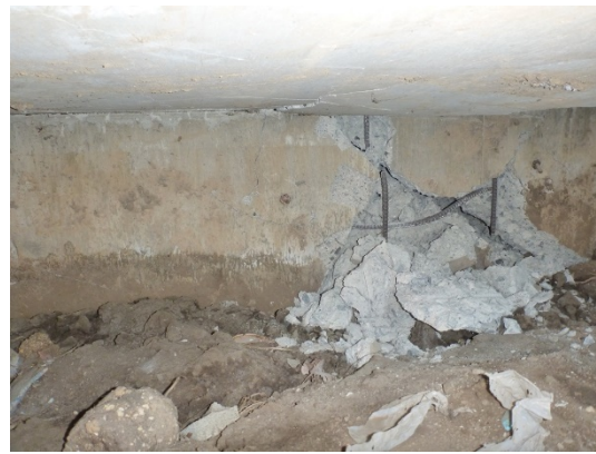
写真5.5-29 1階バルコニー下の基礎部分の損傷
