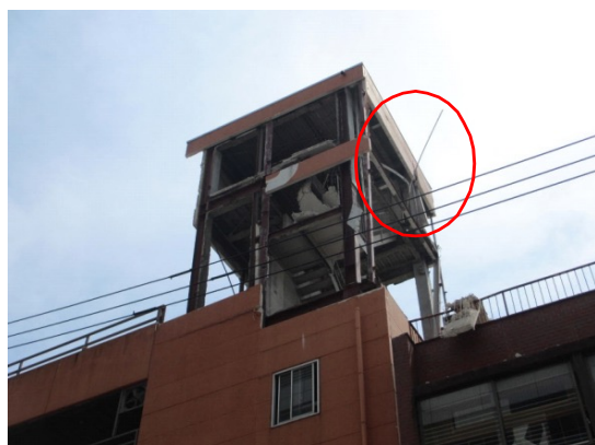
写真 5. 4-201 塔屋のブレースの破断
