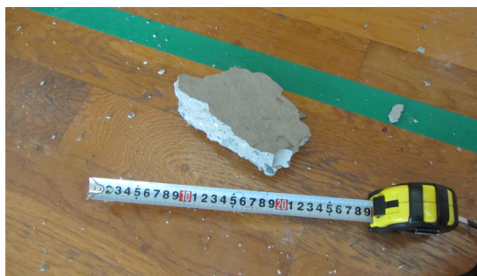
写真 5. 4-146 落下していたモルタル
