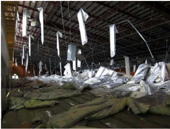
写真 5.8.2-19 天井脱落の状況
