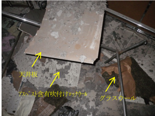
写真 5.8.2-75 2階床上落下物
