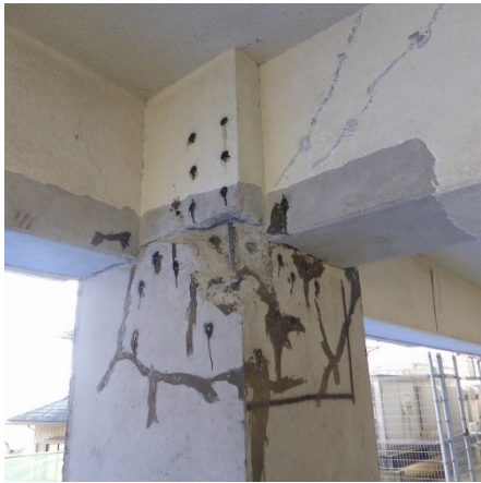
写真5.5-46 1階柱頭のコンクリート剥落 と鉄筋露出
