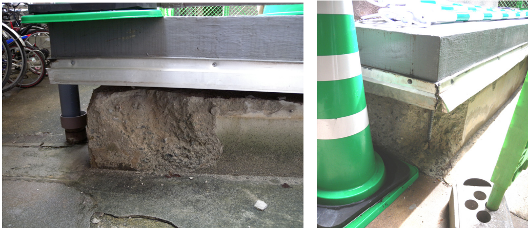
写真 5.7.2-42 鉛直クリアランス部分の変状
