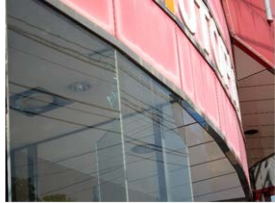
写真 5. 8. 2-36 大判ガラスの損傷
