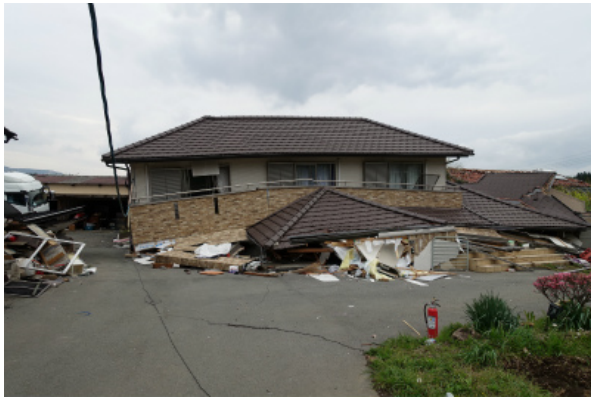
写真 5.3-70 倒壊した木造住宅（金物あり）
