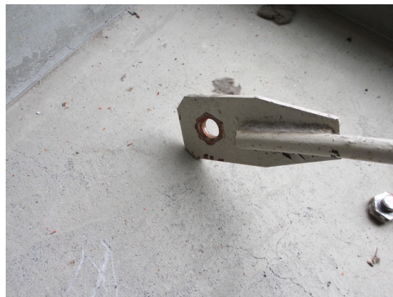
写真 5.4-81 鉛直ブレースのボルト破断
