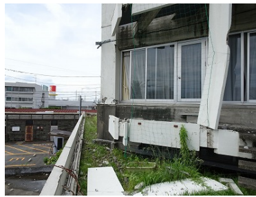
写真5.5-197 南側2階柱脚部の破壊
