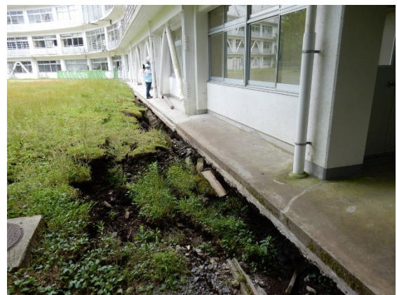
写真5.5-184 建築物北西側における地盤変状
