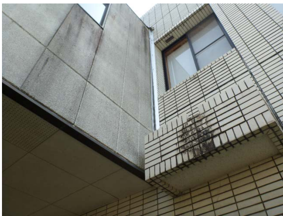
写真5.5-131 エキスパンションジョイント保護カバーの変形（外側）
