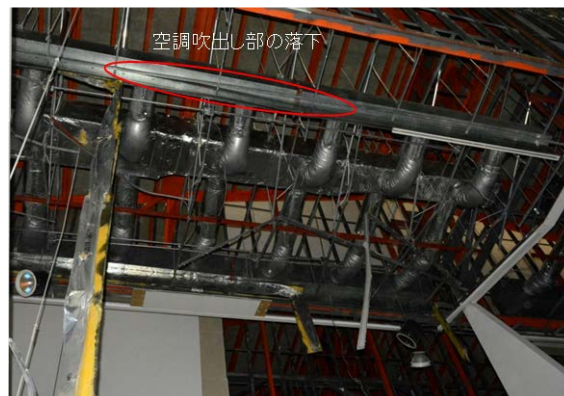
(b) 美術館（1992年改修/用途変更：熊本市中央区） における天井落下に伴う吹出し部の落下
