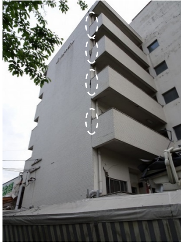
写真5.5-223 外観（北東側） バルコニー端部のひび割れ
