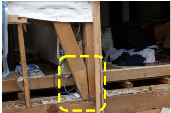
写真 5.3-57 アパート E の柱頭部 (柱脚、筋かい端部は釘打ちのみ)
