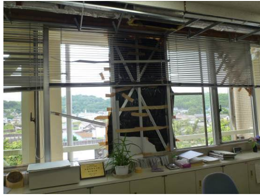
写真5.5-175 窓ガラスの破損
