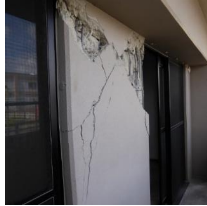
写真5.5-34 バルコニー側方立て壁のせん断破壊
