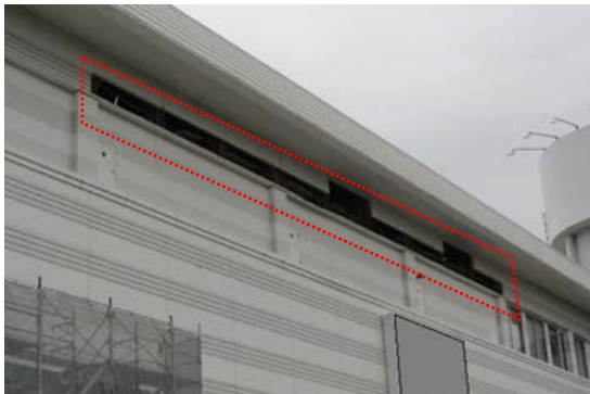
写真 5. 8. 2-58 商業施設における天井レベルでの ALC パネルの損傷
