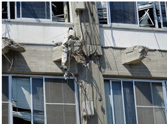
写真5.5-202 4階十字形柱梁接合部の損傷（南東側）
