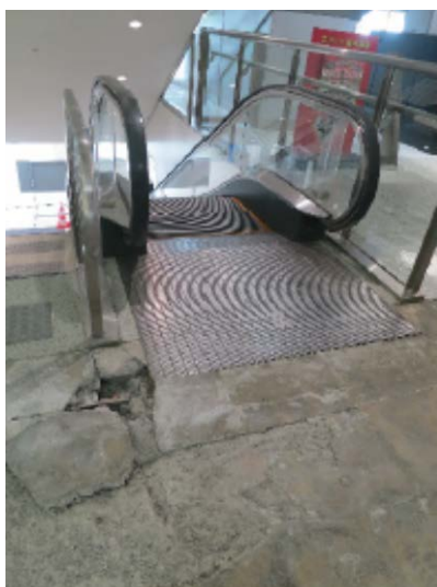
写真 5.8.3-14 エスカレーター接続部での被害
