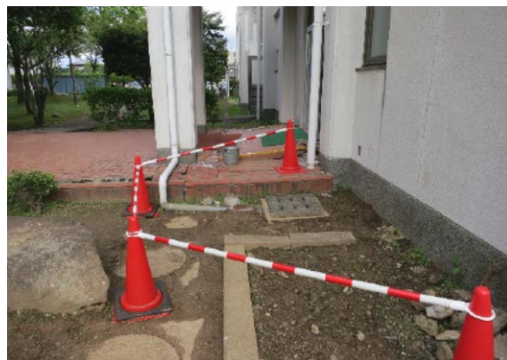
(b) 学校（1979年竣工：熊本市中央区）での破損箇所付近の様子
