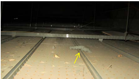
写真 5. 8. 2-85 アリーナ上部吊り天井裏落下物
