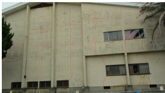
写真 5.4-107 舞台裏妻面（仕上げモルタルにひび割れ（赤線））
