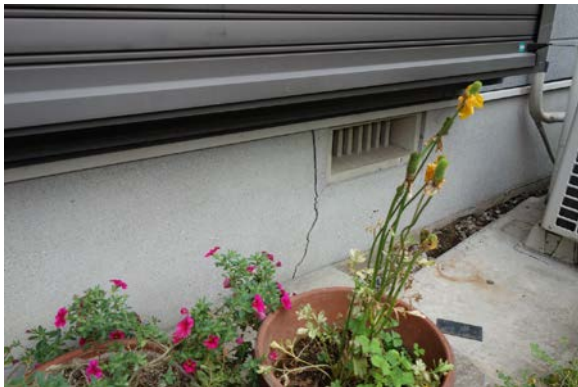
写真 5.6-16 写真 5.6-14 の建築物の基礎の様子。ひび割れを確認
