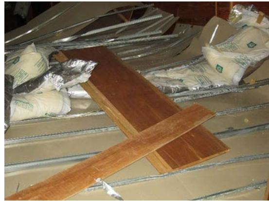
写真 5.8.2-20 脱落した天井材
