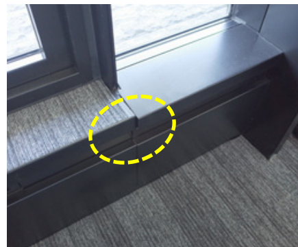
写真5.7.2-13 窓サッシ部金具のずれ
