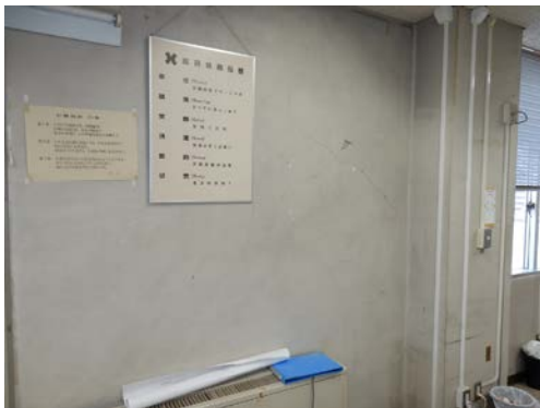
写真5.5-269 RC 造壁のせん断ひび割れ
