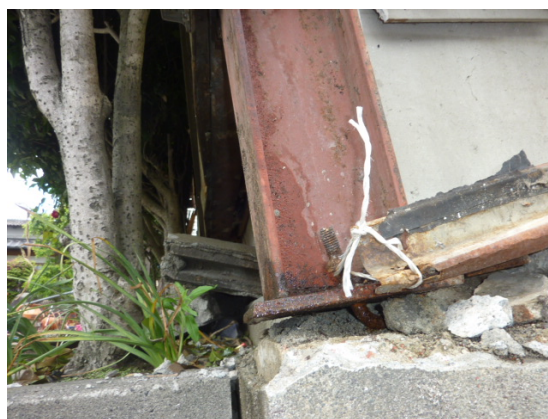
写真 5.4-8 柱脚部の損傷状況
