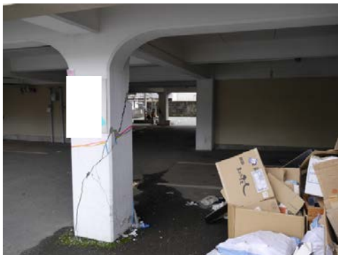
写真5.5-309 建築物北西構面における1階柱のせん断破壊
