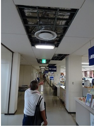
写真5.5-170 2階天井の脱落
