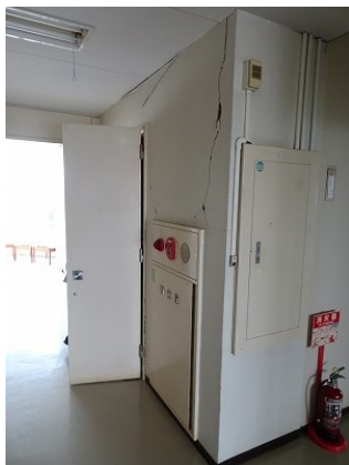
写真5.5-168 非構造壁の損傷
