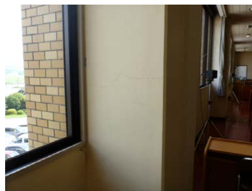
写真5.5-134 腰壁付き柱の曲げひび割れ
