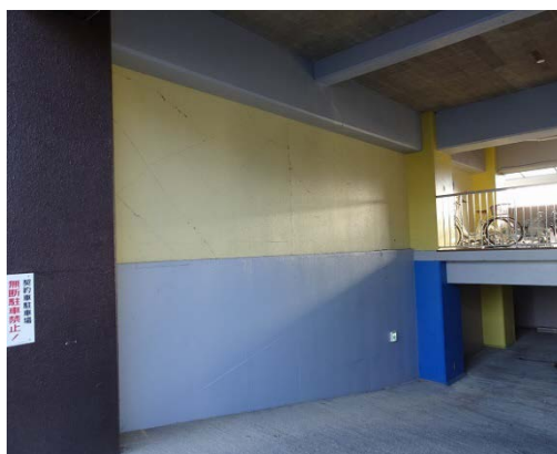
写真5.5-252 1階張間方向の耐力壁のせん断ひび割れ
