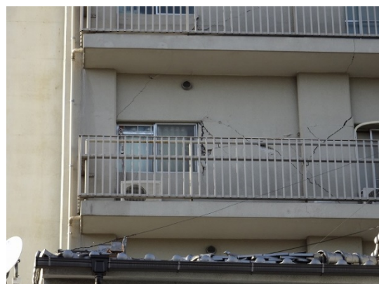
写真5.5-251 5階張間方向南側妻構面の袖壁付き柱せん断破壊
