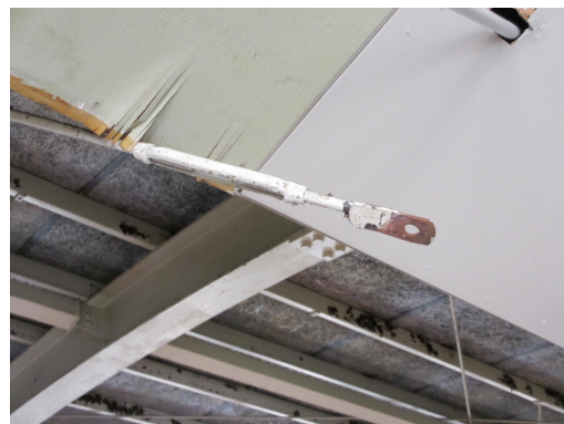
写真 5. 4-48 屋根面水平ブレースのボルト破断
