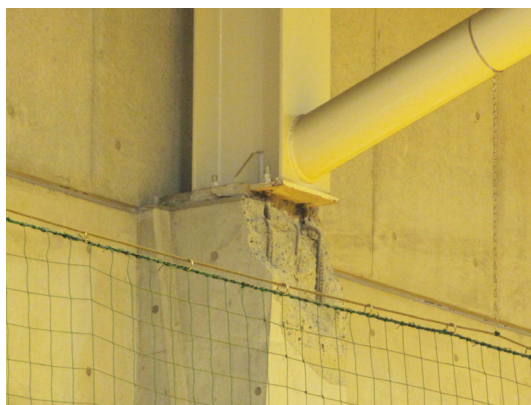
写真 5.4-56 支承部のコンクリートの側方破壊
