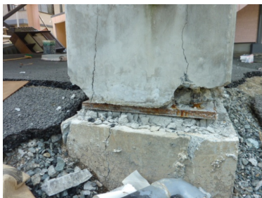
写真 5.4-37 柱脚部の損傷状況
