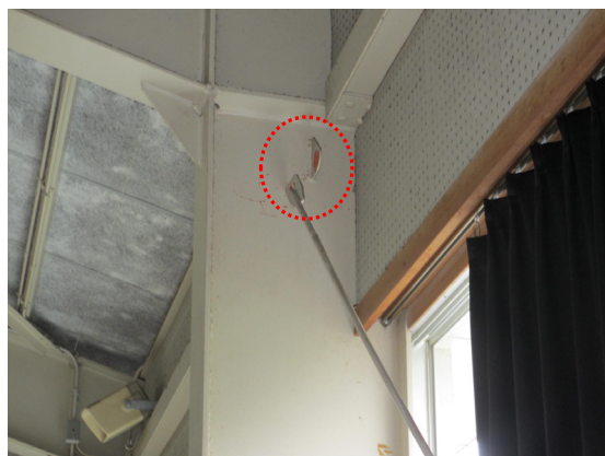
写真 5.4-80 鉛直ブレースのボルト破断
