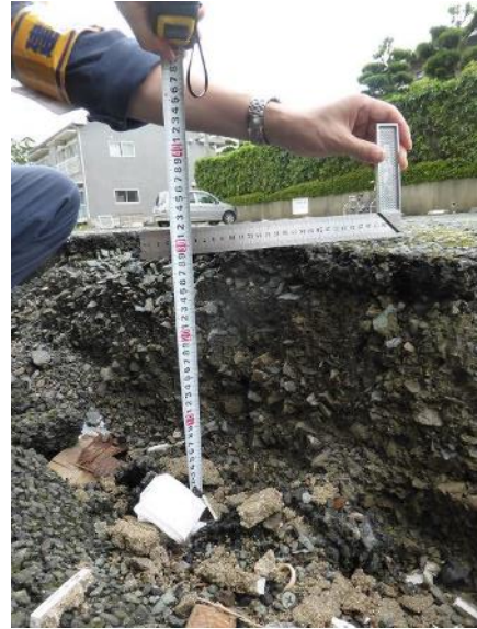
写真5.5-85 建築物と外周地盤の段差
