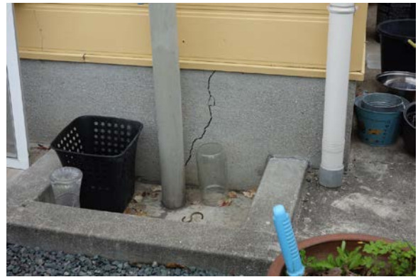
写真 5.6-8 写真 5.6-6 の建築物の基礎の様子。ひび割れを確認
