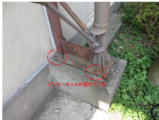
写真 5. 4-150 柱脚のアンカーボルトの破断
