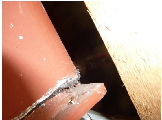
写真 5.4-21 パネルとダイアフラム間の溶接部の破断 (拡大)
