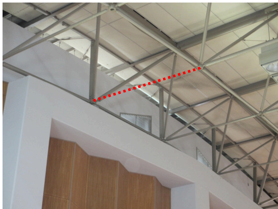
写真 5.4-182 体育館Nのトラス屋根の下弦材の落下
