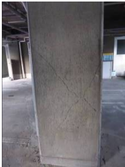
写真5.5-240 1階柱のせん断ひび割れ
