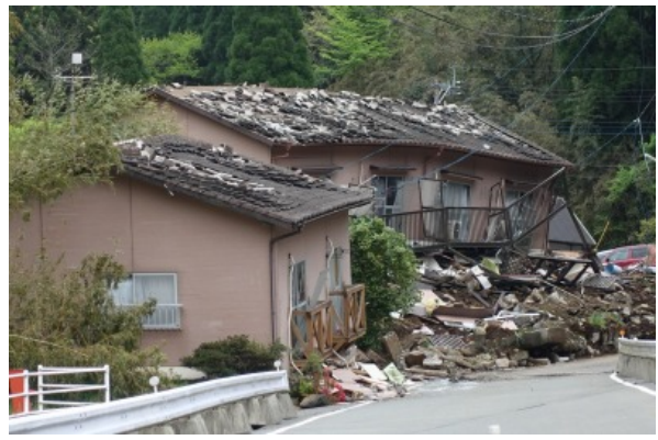
写真 5.3-63 倒壊した木造アパート
