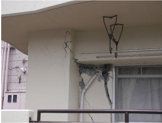
(a) 柱端部の圧壊
