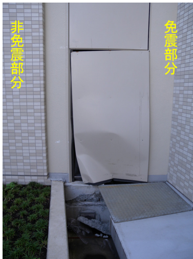
写真 5.7.2-3 エキスパンションカバー周囲の変状
