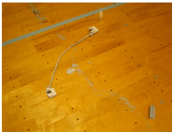
写真 5.4-60 落下した吊り金具
