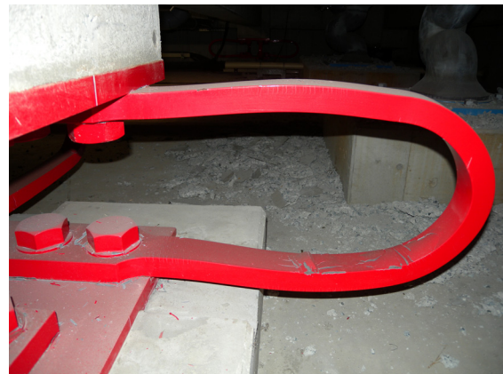
写真 5.7.2-19 鋼材ダンパーの変状
