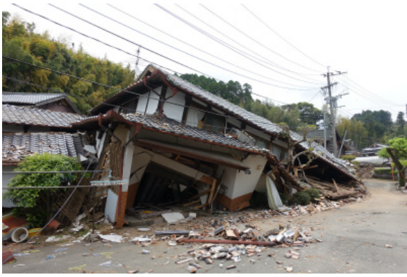
写真 5.3-36 倒壊した木造住宅
