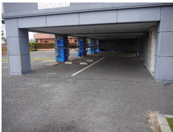
写真5.5-9 1階 (ピロティ層) の被害
