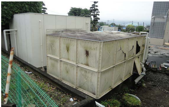
写真5.5-162 破損した設備機器
