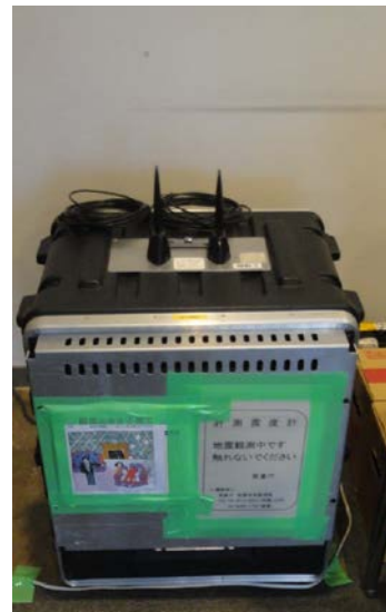
写真5.5-140 建築物内の地震計
