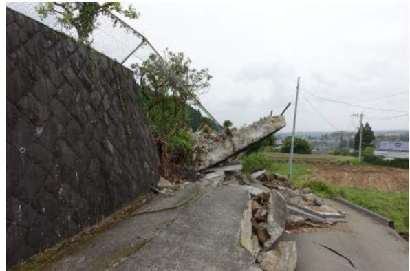
写真 5.3-31 崩壊した擁壁
