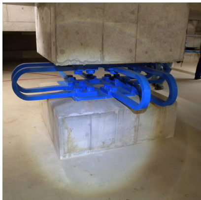
写真 5. 7. 2-26 U形鋼材ダンパーの状況
