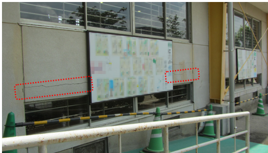
写真 5.4-115 1階外壁の水平なひび割れ
