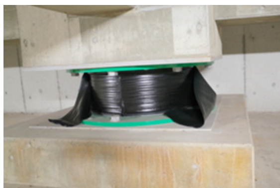
写真 5.7.2-20 積層ゴム化粧カバーの外れ
