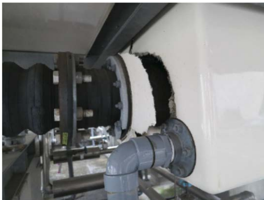
(a) 破断箇所の様子
