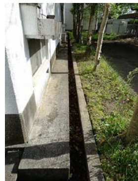
写真5.5-293 傾斜校舎の外構周辺部
