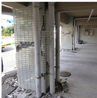
写真5.5-37 1階柱桁行方向のせん断破壊
