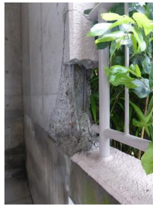
写真5.5-72 駐車場の桁行方向非構造壁の損傷
