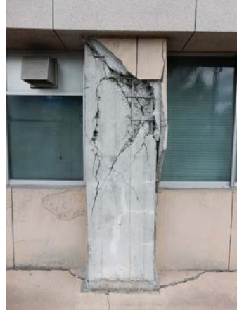
写真5.5-306 1階柱のせん断破壊
