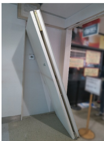
写真 5.8.2-60 ヒンジから脱落した防火戸（益城町、RC+S 造）
