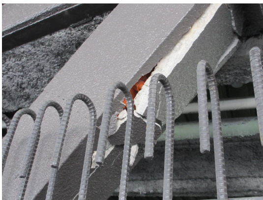
写真 5.4-197 ブレース端部の耐火被覆の亀裂
