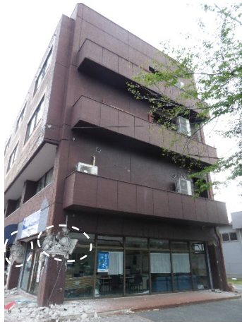
写真5.5-254 外観 (南東側) と大破した 2 本の柱
