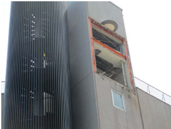
写真 5. 8. 2-56 駐車場の塔屋の被害
