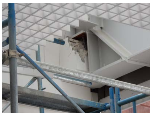
写真5.5-121 エントランス屋根上の鉄骨梁を支える RC 造コーベルの損傷
