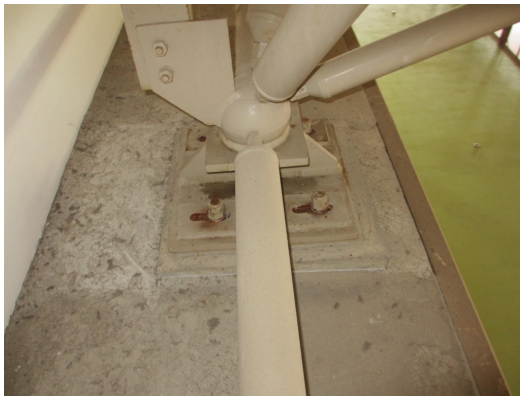
写真 5.4-159 建物桁行構面は長孔の支承部で長孔の端までボルトが移動
