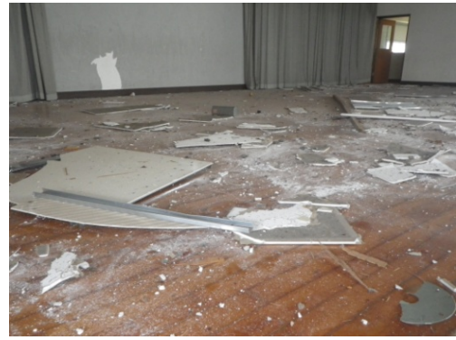
写真 5. 8. 2-90 ステージ床上落下物
