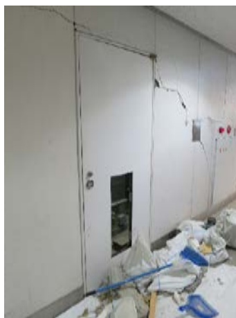
写真 5.8.2-61 戸枠の歪みにより開放できなくなった防火戸（益城町、RC+S 造）
