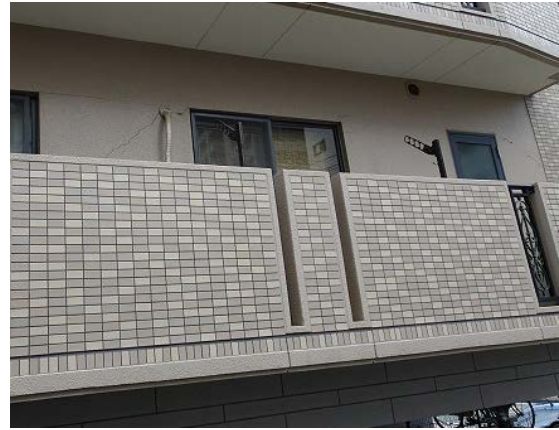
写真5.5-44 方立て壁のせん断ひび割れ
