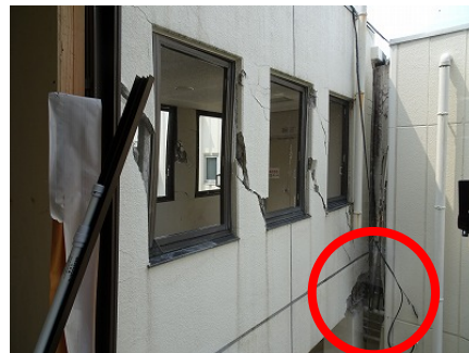
写真5.5-157 渡り廊下被害柱梁接合部被害
