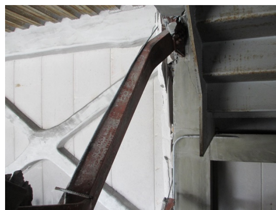
写真 5.4-193 溝形鋼ブレース端部の座屈
