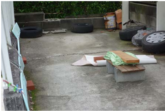
写真 5.6-7 写真 5.6-6 の建築物周辺の地盤変状
