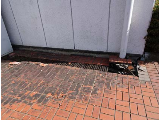
写真5. 5-294 校舎と外構の段差
