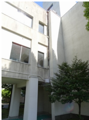
写真5.5-291 渡り廊下エクステンションジョイント部の破壊
