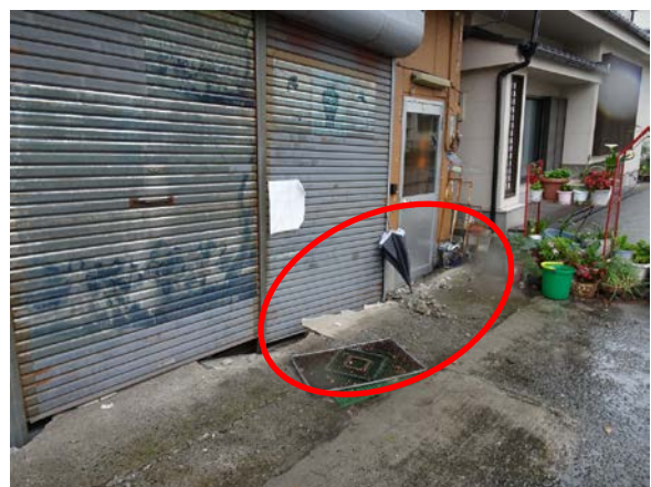
写真 5.6-54 写真 5.6-53 の建築物の1階部分の沈下状況
