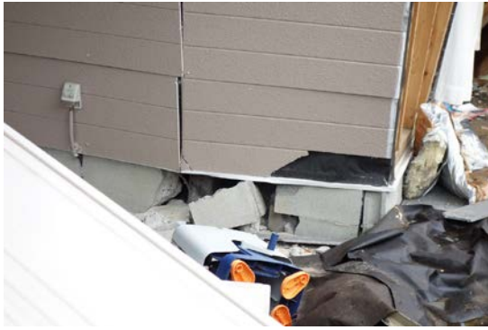
写真 5.6-36 写真 5.6-35 の建築物の基礎。破壊しているが打継があるようにも見える。
