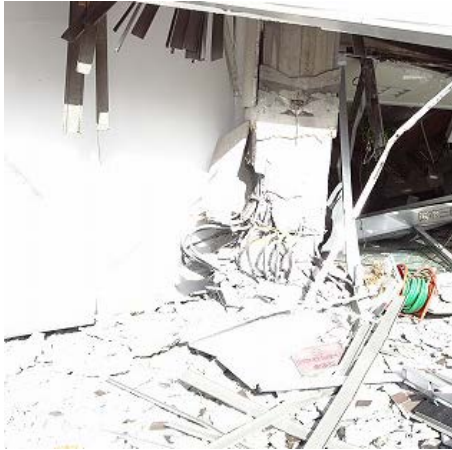
写真5.5-215 柱の軸崩壊、鉄筋座屈
