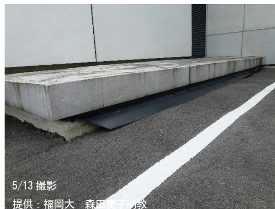
写真 5.7.2-60 免震スカートのはみ出し
