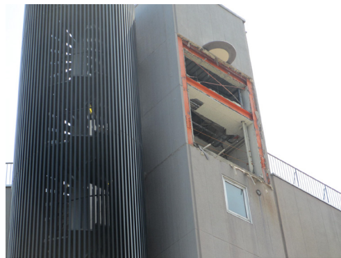
写真 5.4-196 塔屋の外装材の脱落
