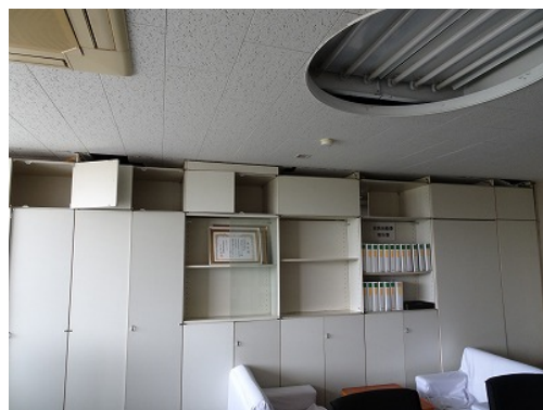
写真5.5-169 什器天端の天井材の被害
