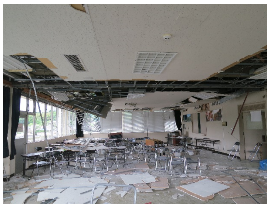
写真 5.8.2-24 天井材の被害
