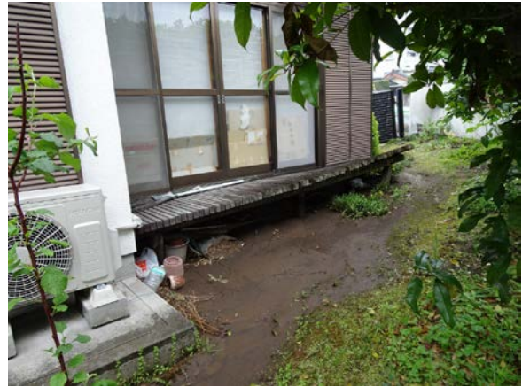
写真 5.6-50 写真 5.6-49 の建築物の縁側部分の沈下状況
