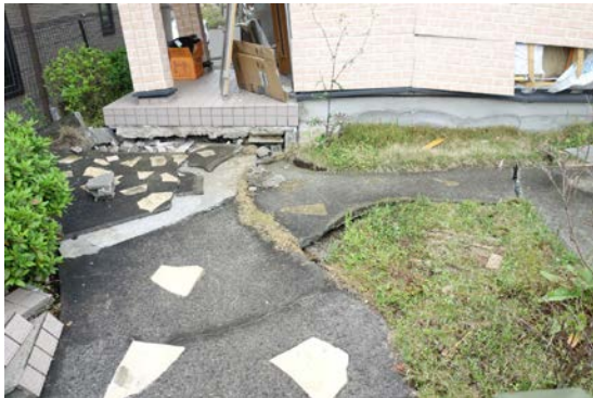
写真 5.6-38 写真 5.6-37 の建築物の周辺地盤。変状は認められるが、基礎の損傷は見えない。
