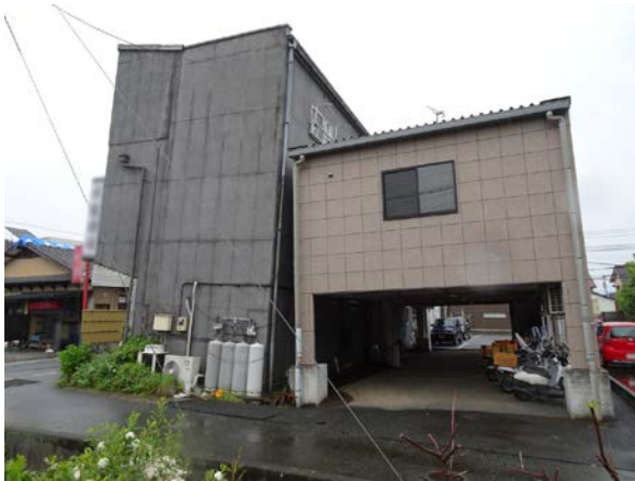
写真 5.6-62 地盤の液状化によると思われる隣接建築物同士が近づくような傾斜形態
