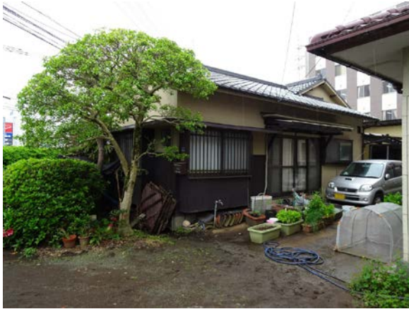
写真 5.6-49 地盤の液状化により基礎の損傷を伴って沈下したと思われる平家建木造住宅
