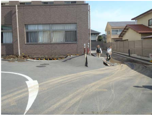
写真 5.6-57 写真 5.6-55 の建築物の周辺地盤の沈下状況（平成 28 年 4 月 15 日午前撮影）
