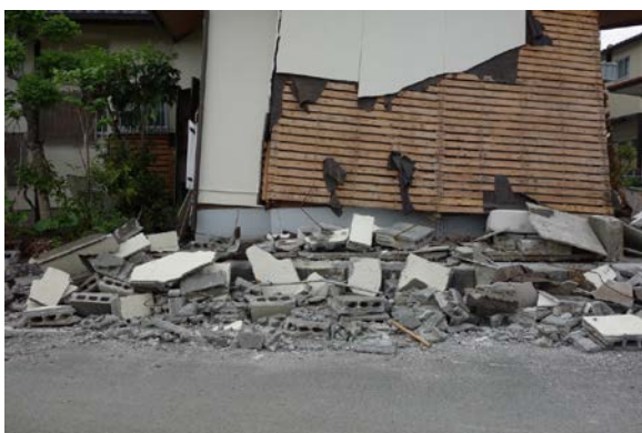
写真 5.6-18 写真 5.6-17 の建築物の基礎周りの様子。基礎にひび割れが見られ、地盤変状も認められる。
