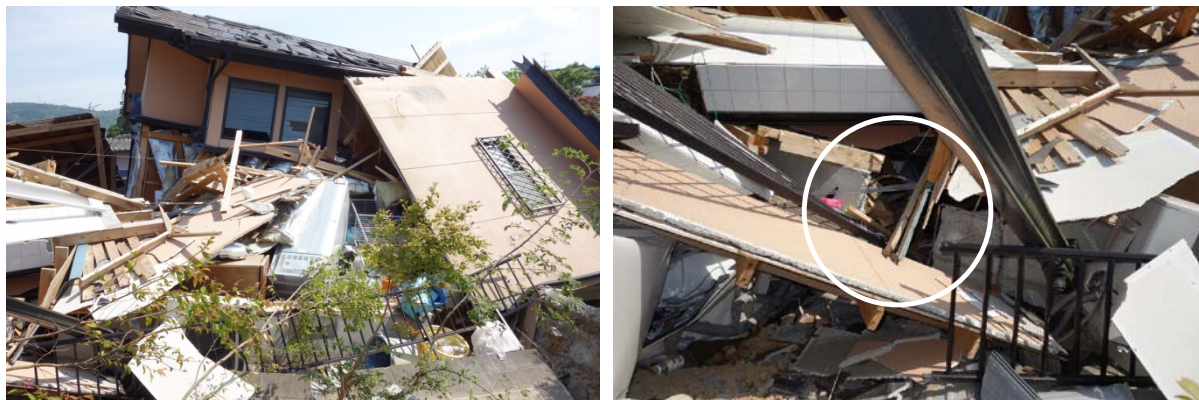
写真 5. 6-45 地盤変状が認められ、基礎に損傷が著しい事例 2
