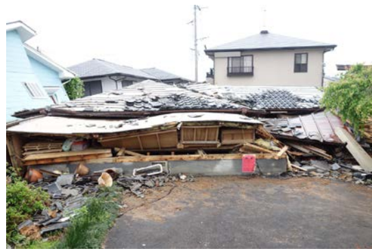
写真 5.6-39 被害の大きい建築物。周辺地盤の変状が認められ、基礎の損傷も認められる。
