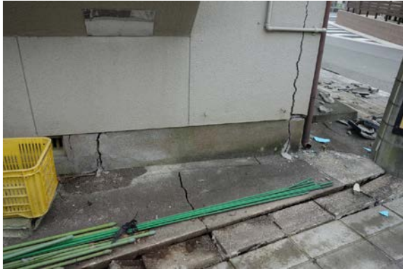
写真 5.6-5 写真 5.6-4 の基礎のひび割れ及び地盤変状を確認
