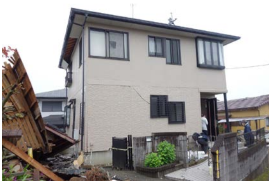
写真 5.6-40 大破と思われるが倒壊には至っていない建築物
