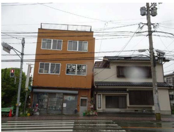
写真 5.6-53 地盤の液状化により沈下・傾斜したと思われる3階建て商用建築物
