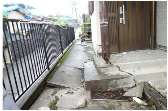
写真 5.6-24 写真 5.6-23 の建築物周辺地盤の様子。盛土擁壁に変位した形跡あり。
