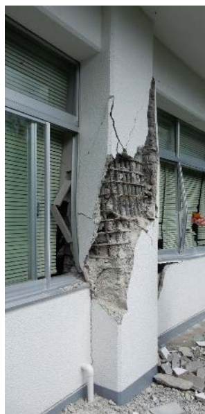
写真5.5-186 柱のせん断破壊
