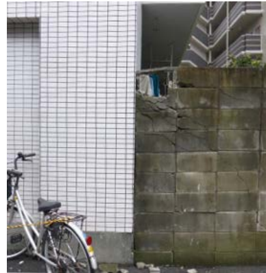
写真5.5-76 柱の傾斜方向 (写真矢印) にあるコンクリートブロックの破壊とせん断ひび割れ
