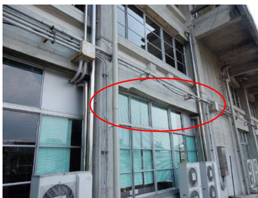
写真5.5-274 大梁下端のコンクリートの剥落
