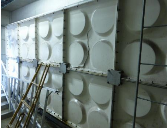
写真5.5-69 FRP 受水槽の破損
