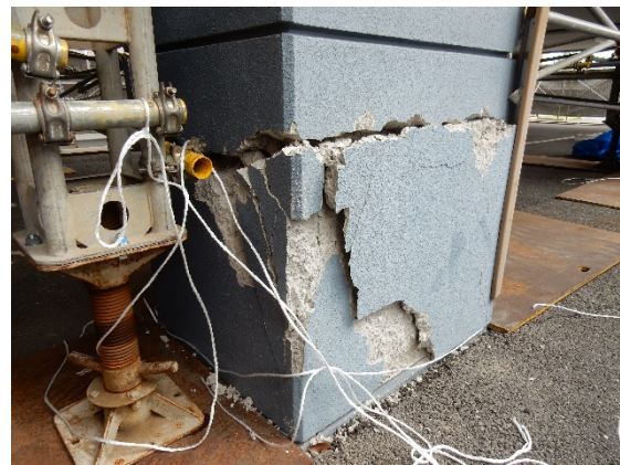
写真5.5-10 1階柱の水平ひび割れ
