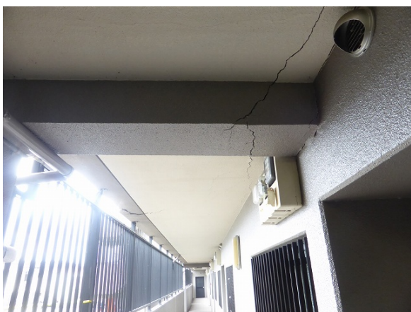
写真5.5-82 1階エントランスホールと住棟本体をつなぐ小梁およびその周辺スラブに生じた曲げひび割れ
