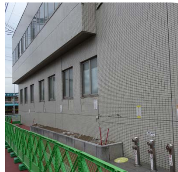
写真5.5-106 外壁タイルの剥落 (管理棟南側)
