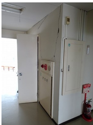
写真5.5-168 非構造壁の損傷
