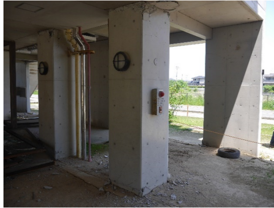
写真5.5-6 X5-Y3 柱（曲げ降伏、損傷度Ⅲ）
