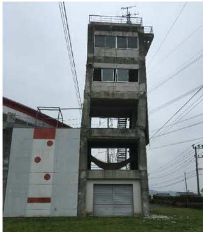
写真5.5-24 本震後の主訓練塔の被災状況
