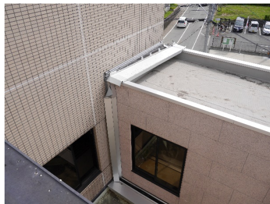
写真5.5-116 エキスパンションジョイントの破損
