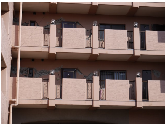
写真5.5-99 共用廊下側の方立壁の損傷
