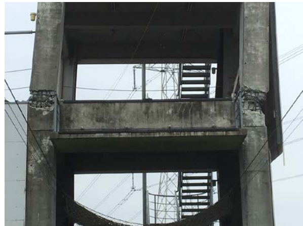
写真5.5-25 本震後の主訓練塔の 3階柱梁接合部周辺の被災状況
