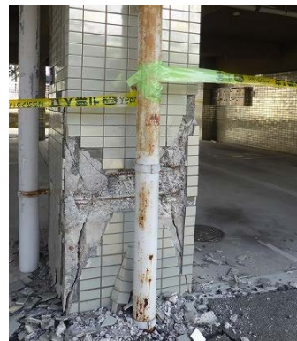
写真5.5-38 1階柱張間方向のせん断ひび割れ
