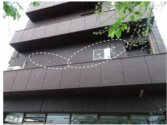
写真5.5-255 耐力壁のせん断ひび割れ (東側)
