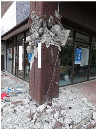
写真5.5-256 1 階柱の大破 (南東側)
