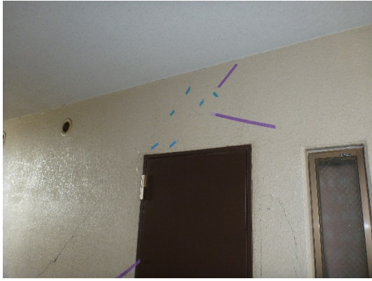
写真5.5-62 ドア開口上の大梁のひび割れ
