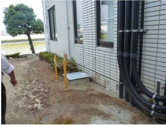
写真5.5-129 地震計の設置状況
