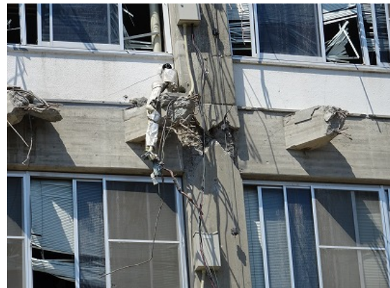
写真5.5-202 4階十字形柱梁接合部の損傷（南東側）
