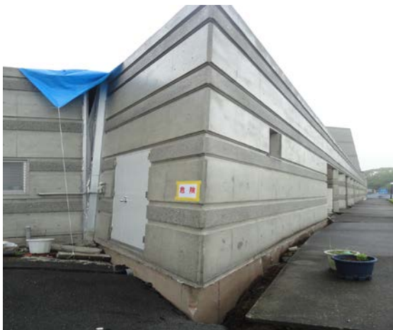
写真5.5-139 建築物北東面の地盤沈下
