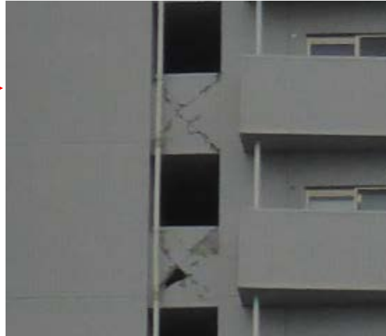
写真5.5-104 廊下手摺壁のせん断破壊
