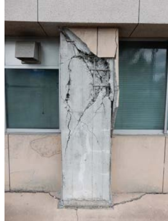
写真5.5-306 1階柱のせん断破壊
