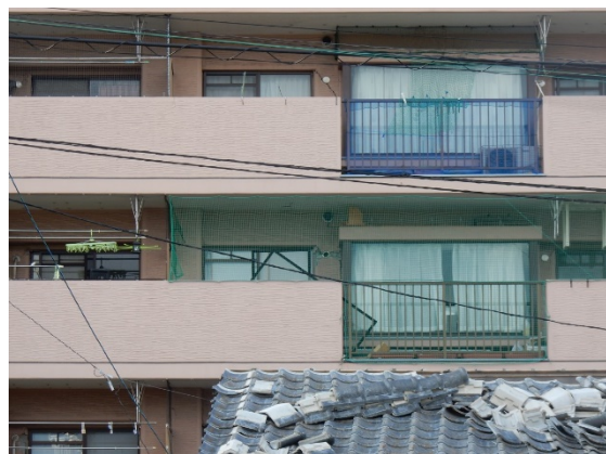
写真5.5-100 バルコニー側の方立壁の損傷
