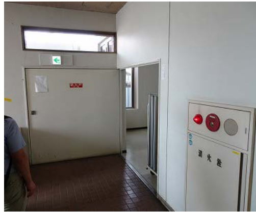
写真5.5-171 応急措置された防火戸
