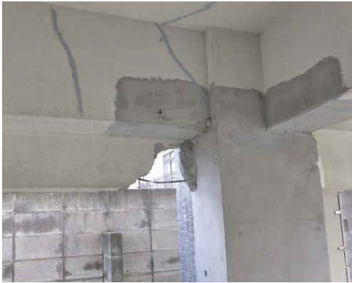
写真5.5-48 垂れ壁端部のコンクリート剥 落、鉄筋露出
