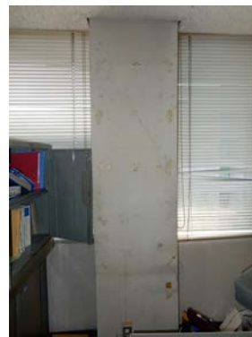
写真5.5-268 柱のせん断ひび割れ
