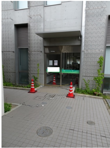
写真5.5-124 南側外構のひび割れ
