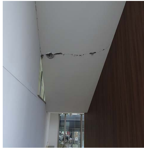
写真5.5-127 階段底面に見られたひび割れ
