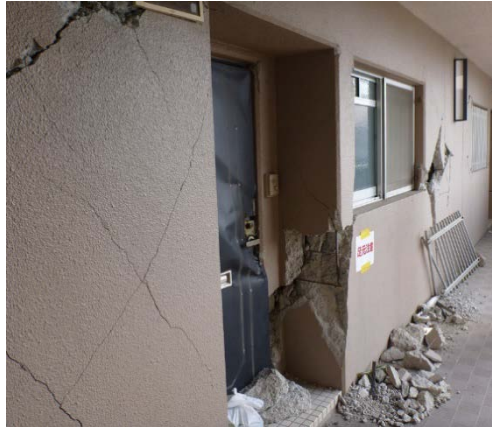
写真5.5-19 2階共用廊下側の方立壁の被害
