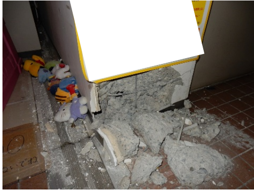
写真5.5-265 2階耐力壁の曲げ圧縮破壊
