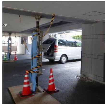
写真5.5-42 支保工による張間方向大梁のたわみ対策
