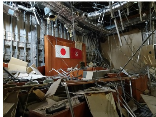
写真5.5-161 議会棟議場の崩落した天井
