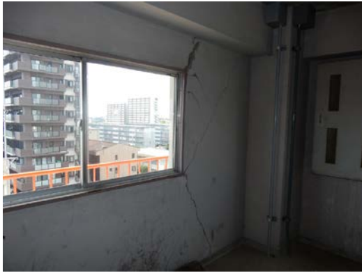
写真5.5-281 訓練塔の非構造壁のひび割れ
