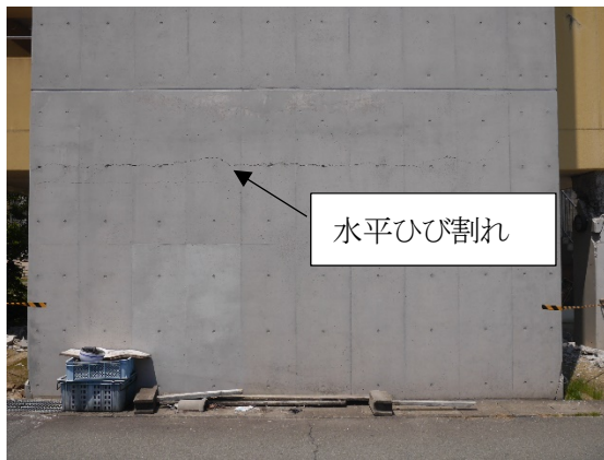
(a) 桁行外柱連層耐力壁（水平ひび割れ）
