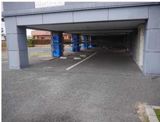
写真5.5-9 1階（ピロティ層）の被害
