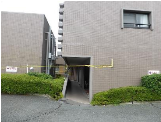
写真5.5-86 建築物と外周地盤の段差
