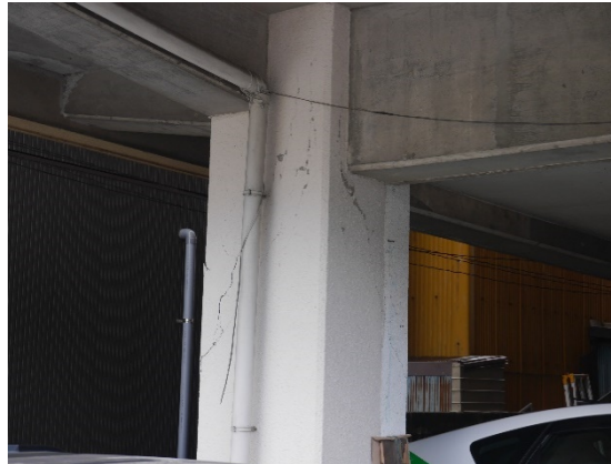
写真5.5-229 隣接建築物のピロティ柱のせん断ひび割れ
