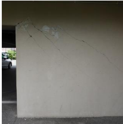
写真5.5-35 1階桁行方向耐力壁のせん断ひび割れ
