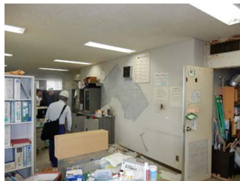
写真5.5-270 仕上げモルタルの剥落
