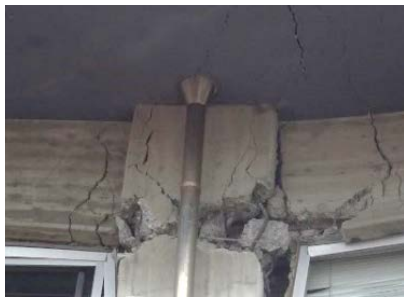
写真5.5-196 5階柱頭部の破壊
