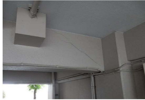
写真5.5-63 1階駐輪場内の桁行方向の大梁のせん断ひび割れ
