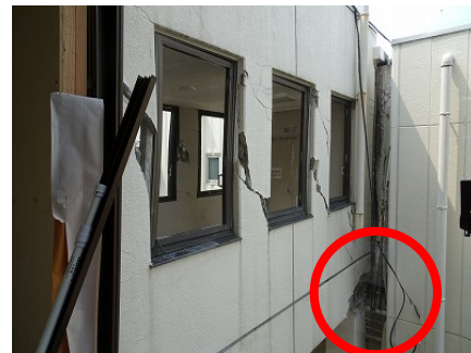
写真5.5-157 渡り廊下被害柱梁接合部被害
