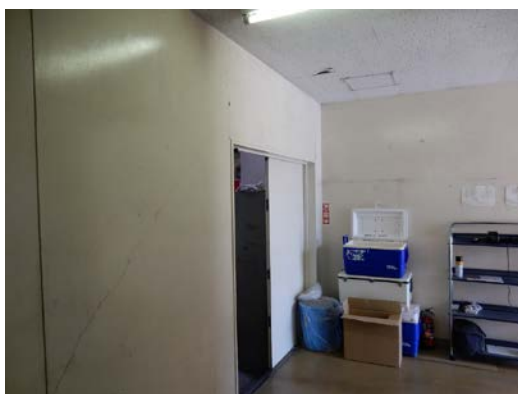
写真5.5-280 耐力壁のせん断ひび割れ
