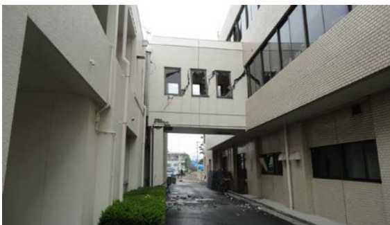
写真5.5-156 渡り廊下被害
