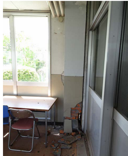
写真5.5-286 エキスパンションジョイント部の破壊
