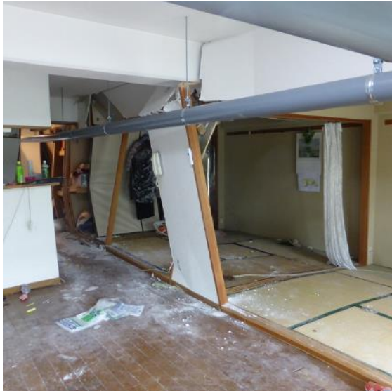
写真5.5-84 1階住戸木間仕切り壁の損壊
