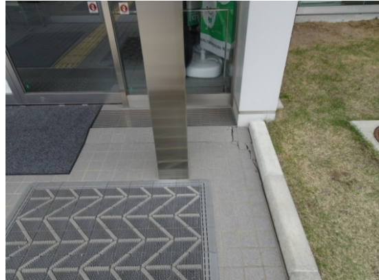
写真5.5-123 エントランス部分の床ひび割れ
