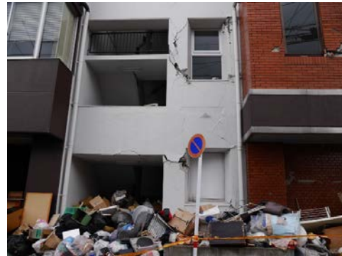
写真5.5-249 2階階段室の柱の損傷
