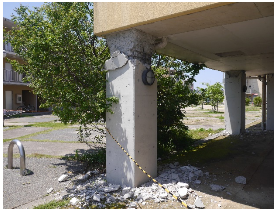
(a) 東側から見た柱全景
