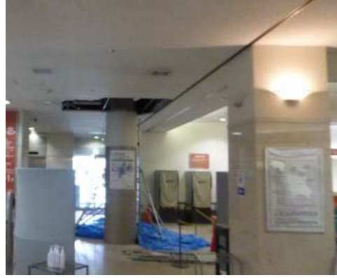
写真5.5-108 天井仕上げ材の脱落（南側病棟）
