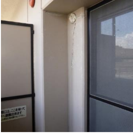
写真5.5-33 バルコニー側柱と袖壁の鉛直ひび割れ
