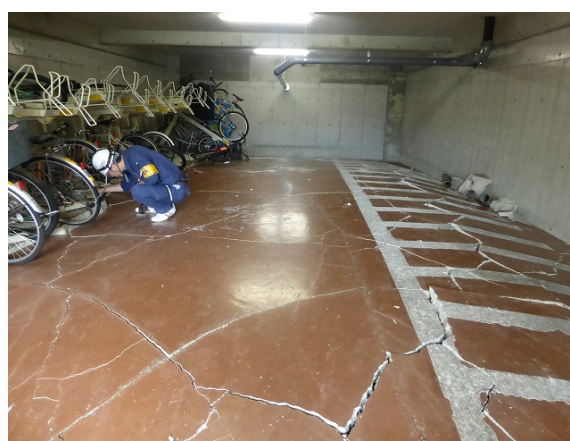
写真5.5-83 1階駐輪場土間スラブの上方向への残留変形と大きなひび割れ
