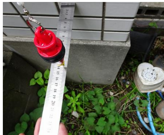
写真5.5-78 下げ振りによる柱の傾斜測定
