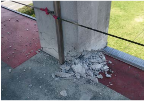
写真5.5-22 前震後の主訓練塔の 3階柱脚の被災状況
