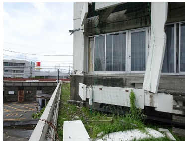
写真5.5-197 南側2階柱脚部の破壊
