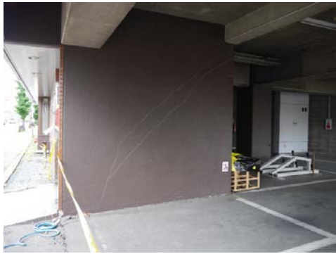
写真5.5-248 1階耐力壁のせん断ひび割れ
