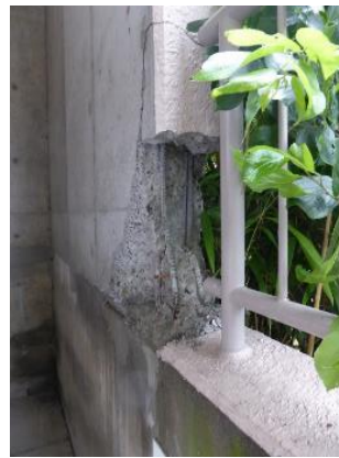
写真5.5-72 駐車場の桁行方向非構造壁の損傷
