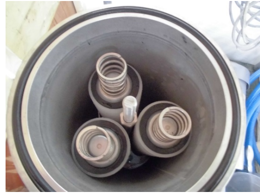
写真8 膜ろ過フィルターの支持部
