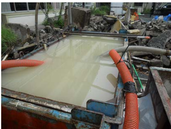
図2 石綿含有汚染水(原水)
