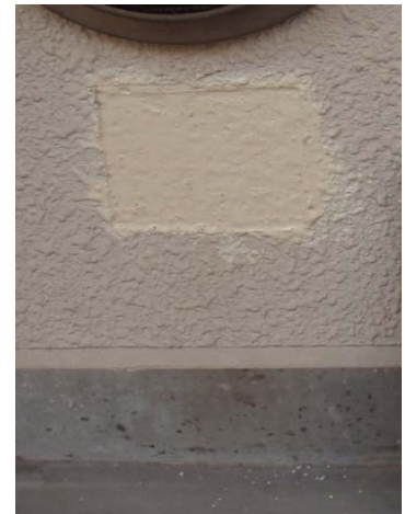
採取痕の簡易塗装補修例
