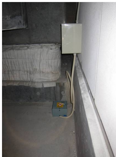
図1.2-23 加速度計#3(免震ピット階)
