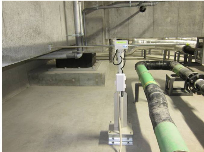
図 1.2-27 相対変位計(免震ピット階)
