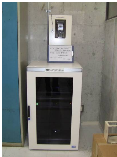
図1.2-10 収録装置(地下1階電気室)
