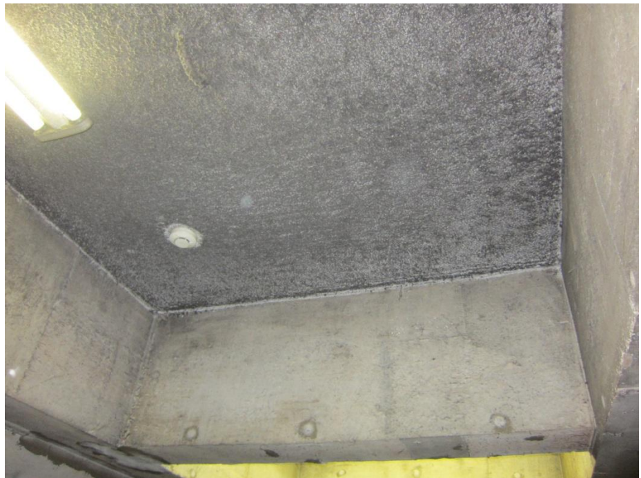
エレベーター機械室2 (No.5) 内
