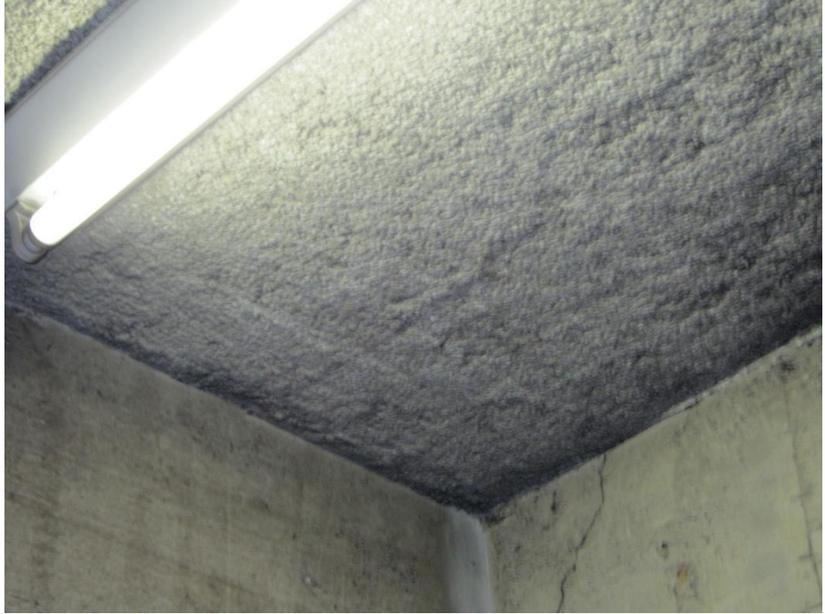
エレベーター機械室 3 (No. 6) 内
