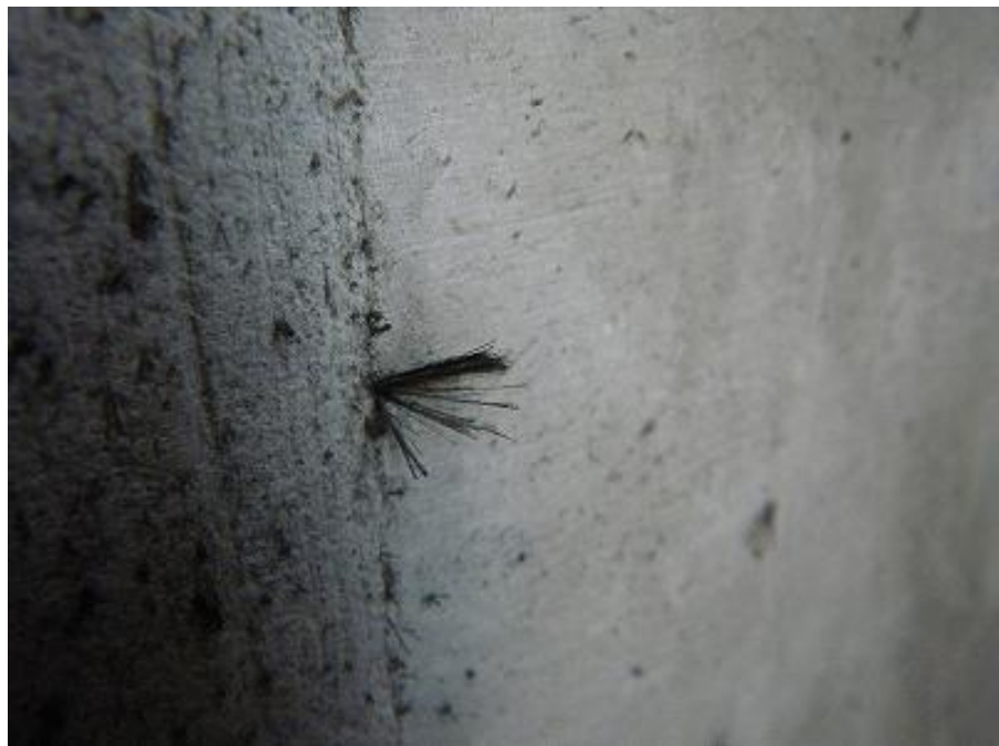
柱けい酸カルシウム板第2種（アモサイト繊維が露出している）
