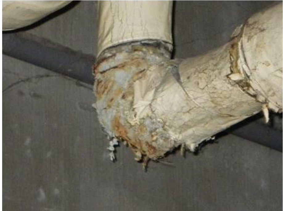
配管エルボ部
