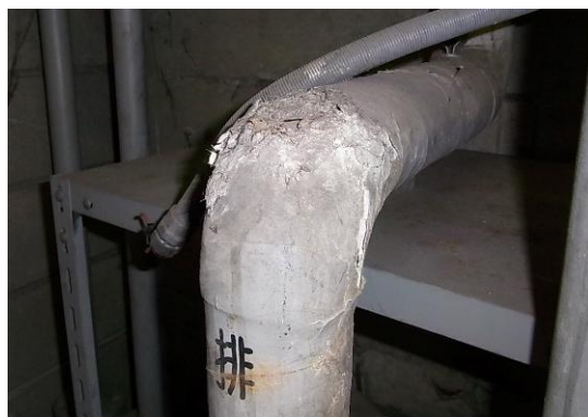
機械室内 配管エルボ
