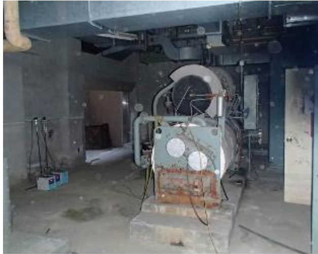
ボイラー室内
