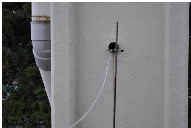
煙突内部 (ばい煙測定孔)
