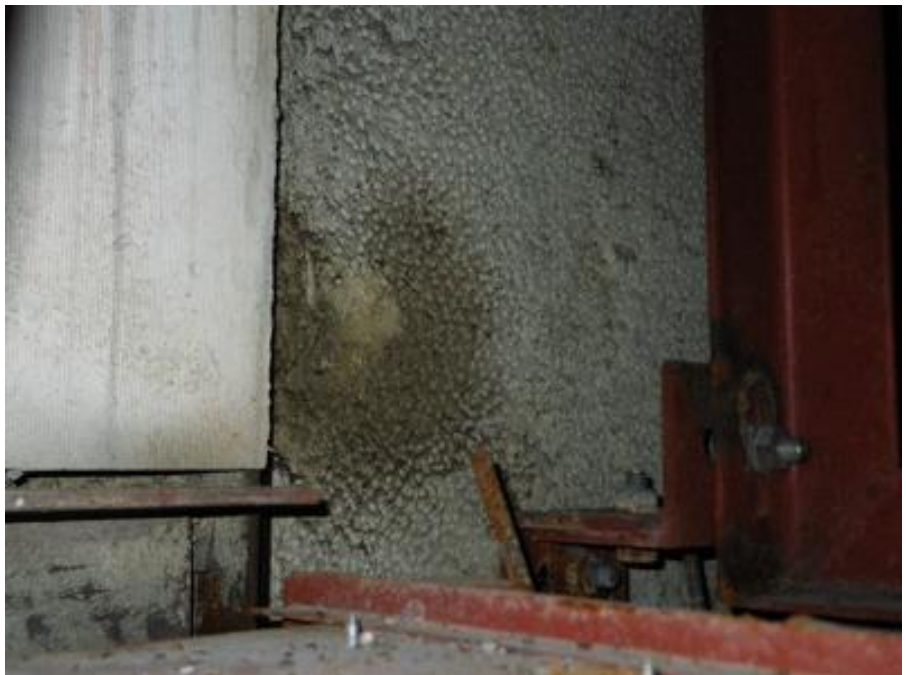
吹付けアスベスト
