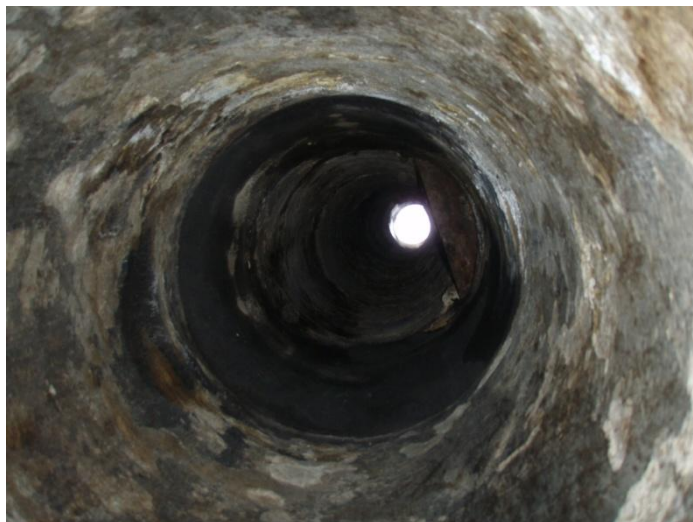
煙突ライニング部スレート
