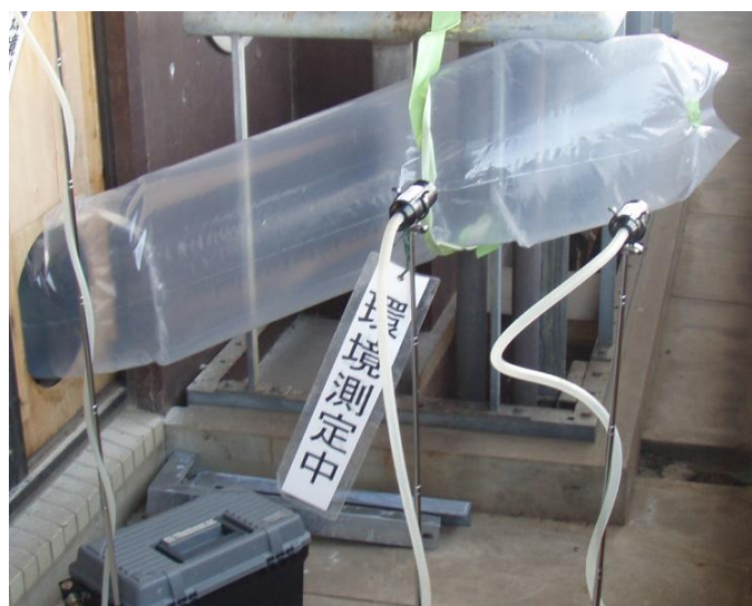
負圧除塵装置排気口前
