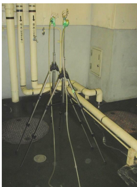
受水槽室内と点検口
