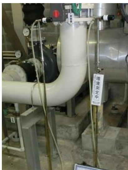
ボイラ室内採気状況
