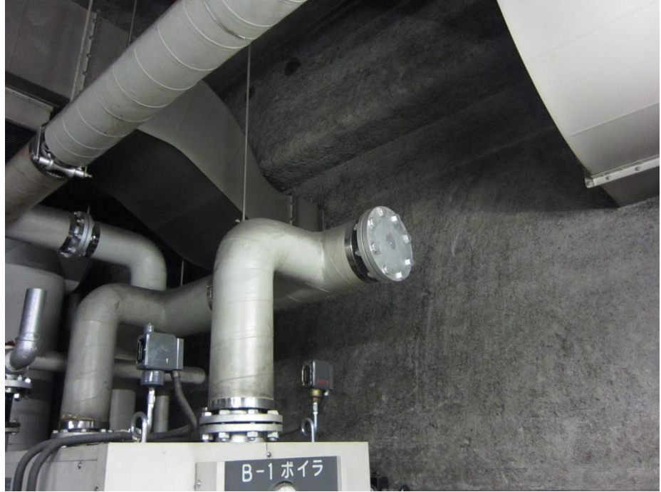
ボイラー室内②
