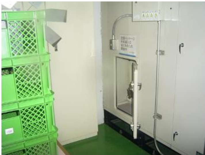
ボイラー室：省エネ対応に伴う外気吸入口の開放について
