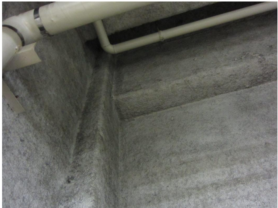
電気室内①
