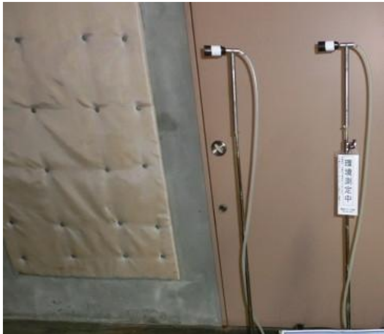
ボイラ室内採気状況
