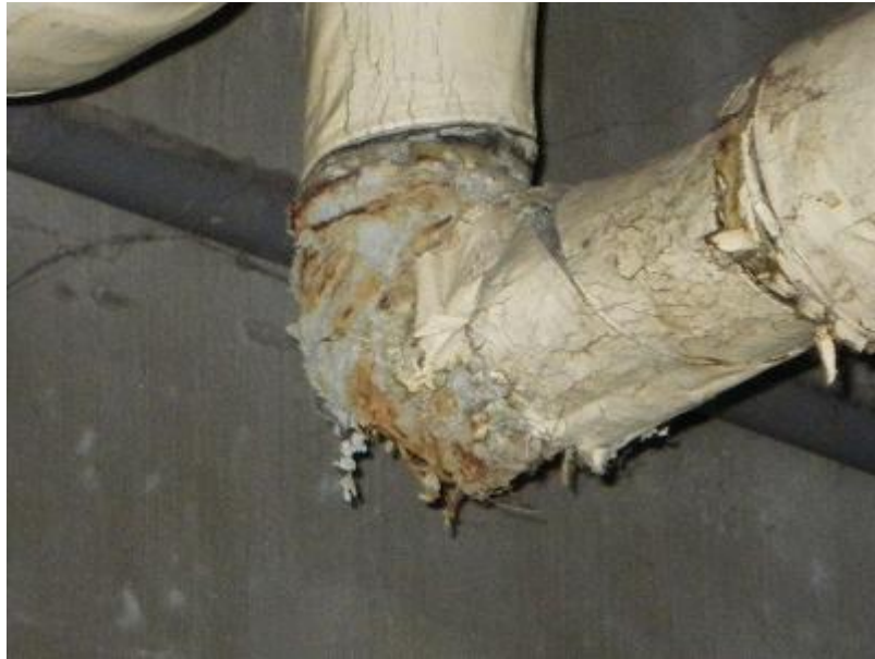
ボイラー室内配管エルボ
