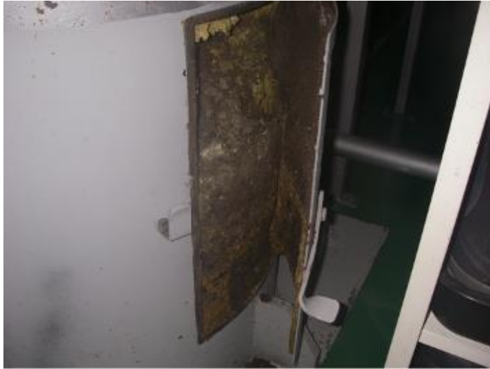
点検口部の断熱材堆積状況
