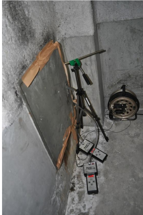
煙突点検口（煙突点検口閉鎖時）
