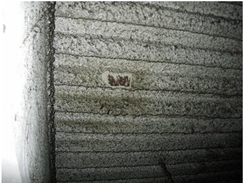
吹付けアスベスト
