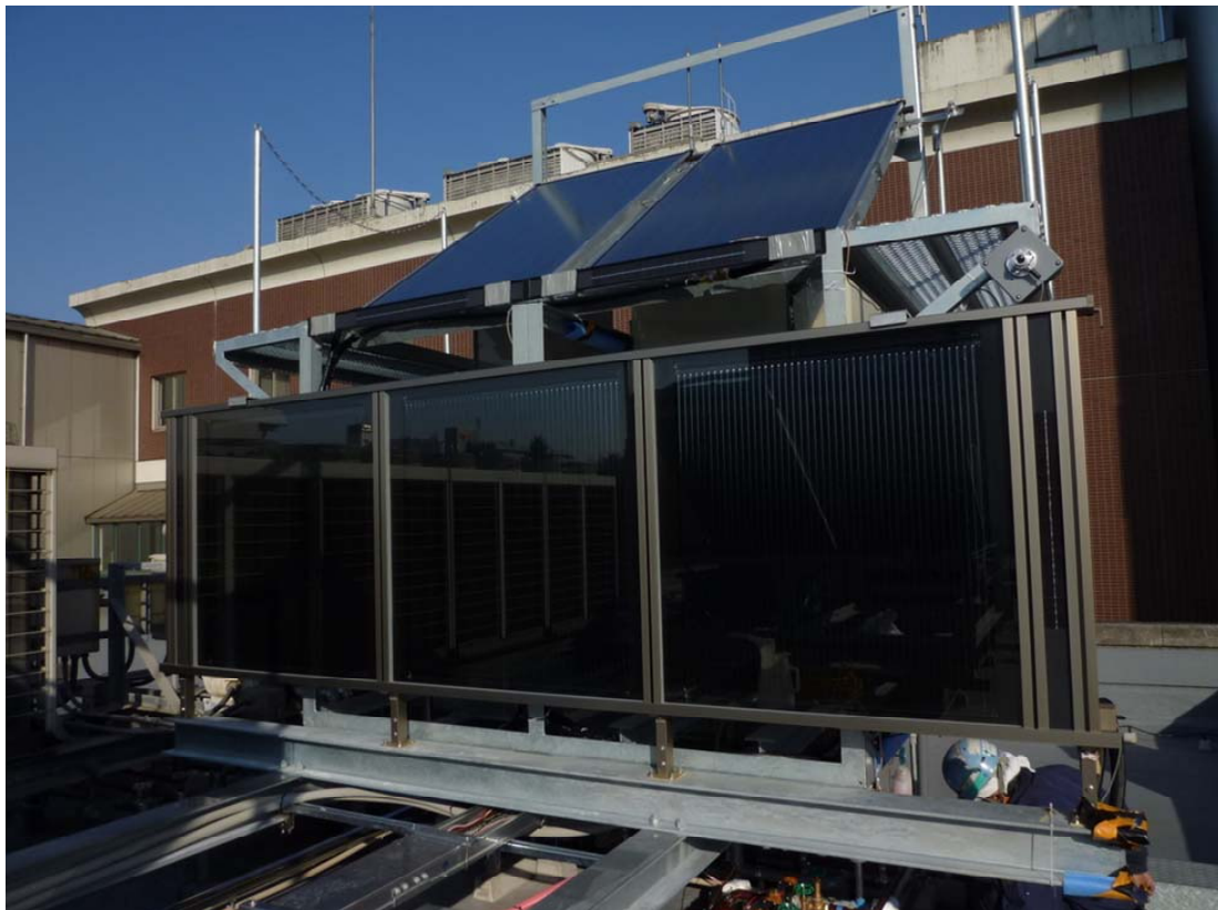
図 7.5.1.7 試験対象機の屋上試験装置への設置 (完了状態)
