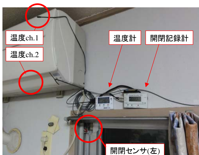
図 7.1.3.2 設置状況(調査要領記載の例)
