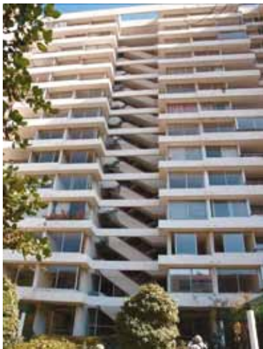
写真 4.37.3 階段部の損傷
