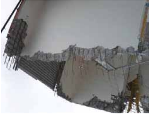
写真 4.25.3 引きちぎられた 1 階壁柱および耐力壁
