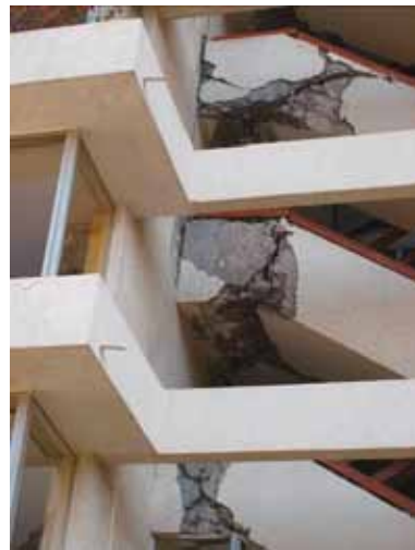
写真 4.37.4 階段部の損傷
