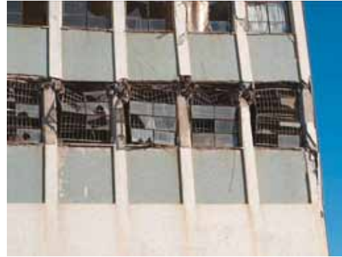
写真 4.36.4 建物右側の損傷
