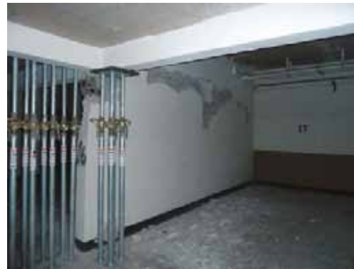
写真 4.2.2 大破した RC 造壁
