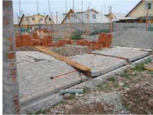
写真 4.18.4 転倒した組積造壁
