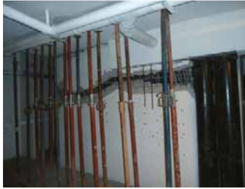
写真 4.1.2 大破した RC 造壁
