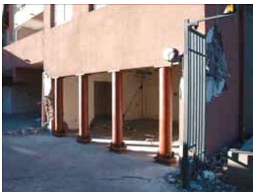
写真 4.29.3 桁行側の構面にも被害
