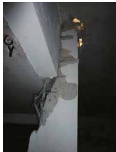
写真 4.2.4 RC 造柱の破壊
