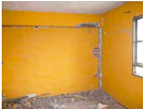
写真 4.21.2 組積造壁の損傷
