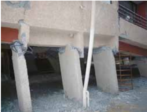
写真 4.9.3 曲げヒンジが生じた壁柱
