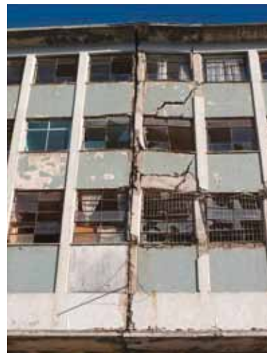
写真 4.36.2 建物の右側が沈下
