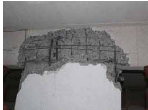
写真 4.38.4 地下駐車場の壁の損傷
