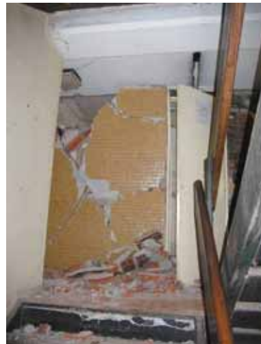
写真 4.26.2 非構造壁の損傷
