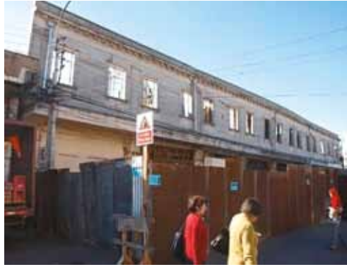
写真 4.32.2 組積造建物（2階部分が崩壊）
