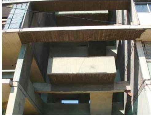
写真 4.12.4 外部階段踊り場を支える梁のたわみとひび割れ
