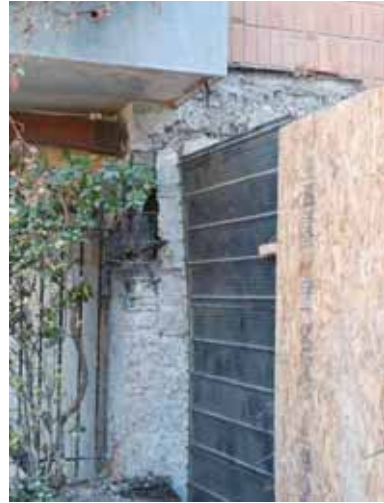
写真 4.38.2 1階南西部の柱の損傷
