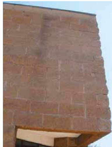
写真 4.11.2 片持ち壁のひび割れ
