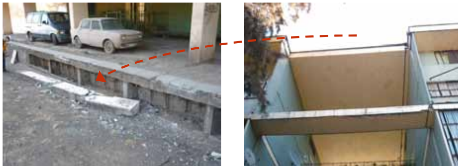
写真 4.12.5 屋上部分の飾り梁が脱落（左は落下した梁）
