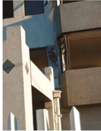
写真 4.30.2 外から確認できる損傷
