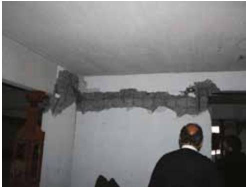
写真 4.38.3 地下駐車場の壁の損傷
