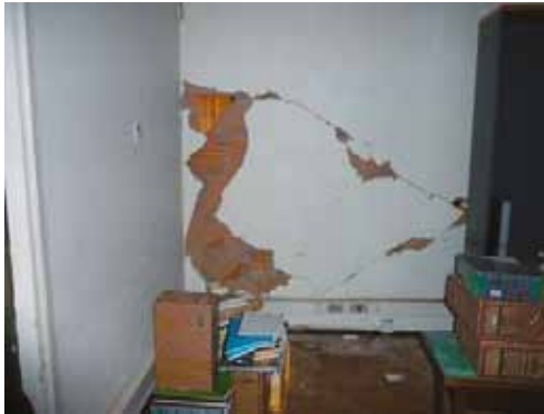
写真 4.24.2 組積造壁の破壊
