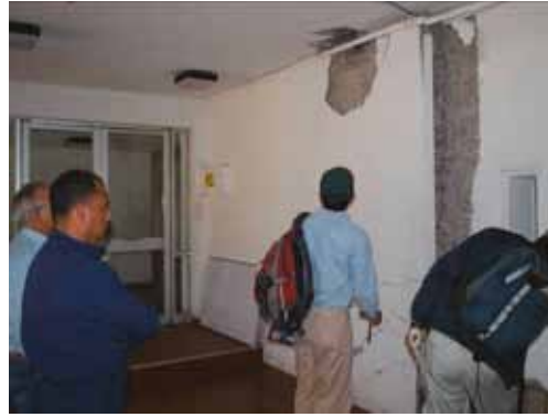
写真 4.37.2 玄関部増し打ち壁の損傷
