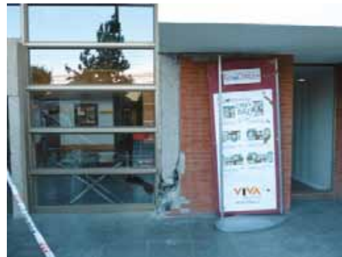
写真 4.4.2 1階柱脚の圧壊
