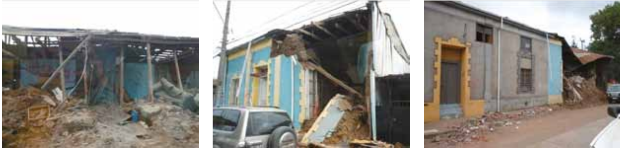
写真 4.16.1 れんが造やアドベ造建物の被害
