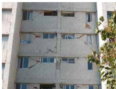
写真 4.5.2 れんが積み外壁の損傷
