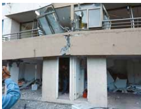
写真 4.27.4 大破した棟の1階部分
