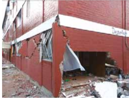
写真 4.17.1 被害建物全景と妻壁の被害
