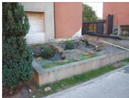
写真 4.29.4 前面の花壇が1mほど沈下
