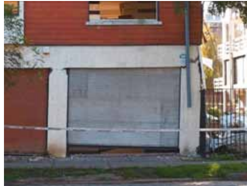
写真 4.28.4 建物裏側の被害
