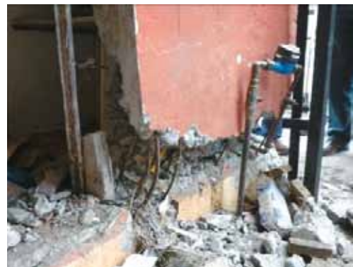
写真 4.15.2 妻壁のせん断破壊
