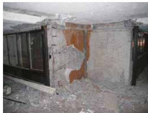
写真 4.26.4 2 階の壁の損傷
