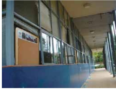
写真 4.20.2 桁行方向鉄骨柱と窓ガラスの飛散
