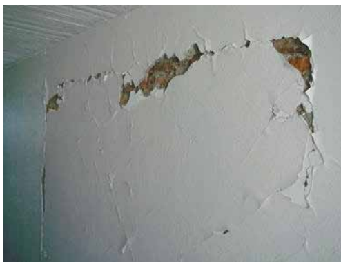
写真 4.12.3 非構造内壁の損傷
