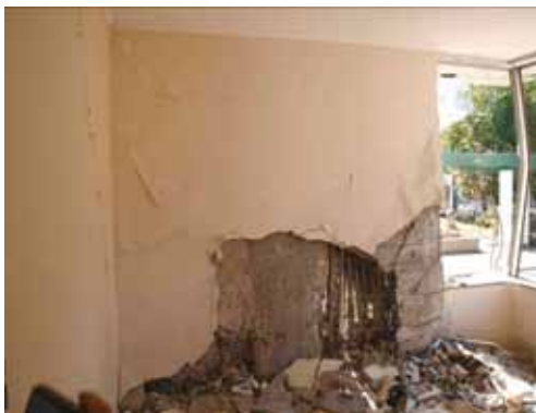
写真 4.37.5 南東の壁脚部の被害
