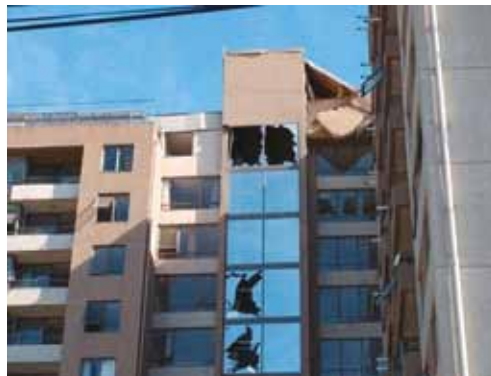
写真 4.27.2 エレベータ部の損傷
