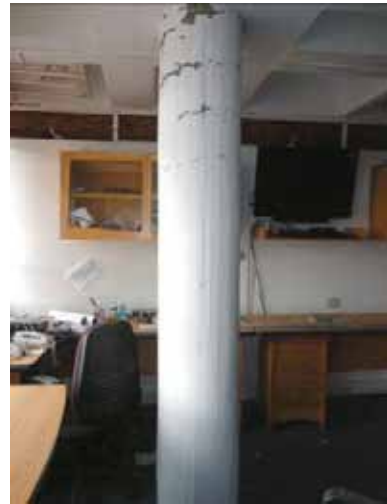
写真 4.24.3 円柱の曲げせん断ひび割れ
