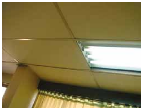
写真 4.11.3 天井材のずれ
