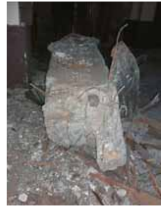
写真 4.39.3 落下した尖塔
