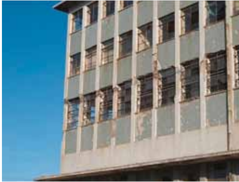
写真 4.36.3 建物左側の損傷
