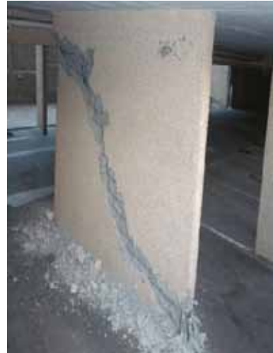
写真 4.9.4 せん断破壊した壁
