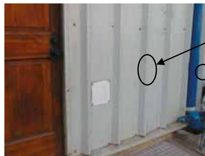
写真 4.35.2 折板の一部が変形
