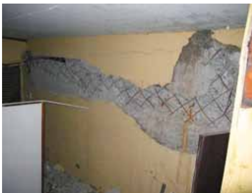
写真 4.26.3 1 階の壁の損傷
