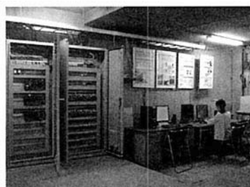
制御室（制御盤、制御用PC）
